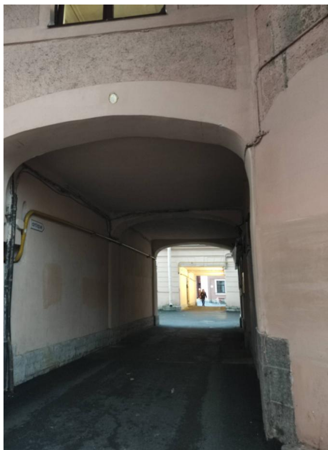
Фото 4. Фрагмент лицевого фасада выявленного объекта культурного наследия «Дом В.Е. и Г.Е Овчинниковых», воротный проезд
