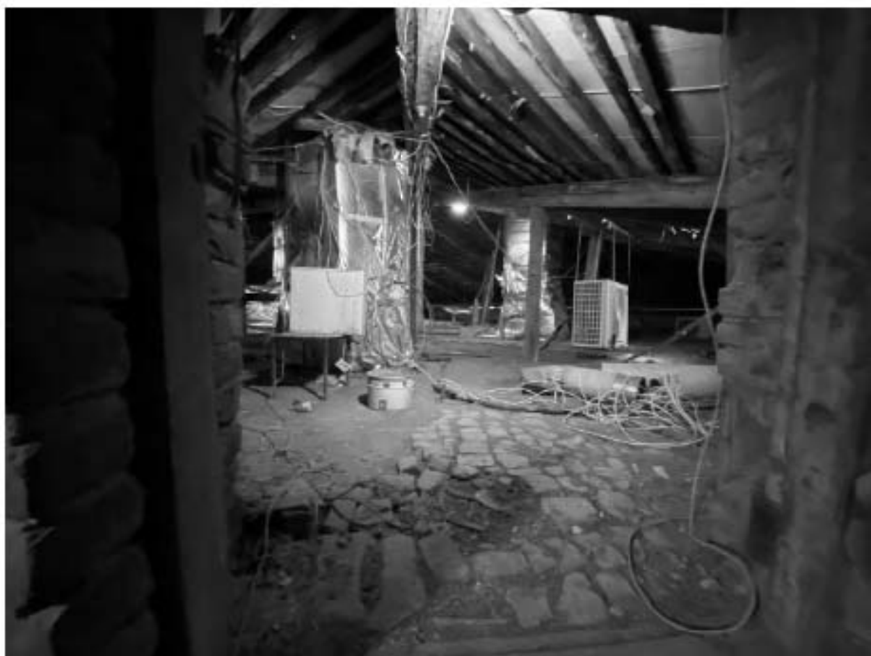
Фото 208. Чердак. Оборудование, размещенное на чердаке.
