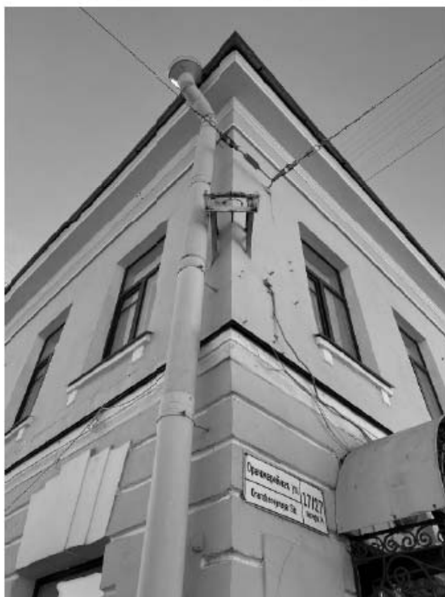
Фото 26 Угловой фасад. Пересечение Московской и Оранжевой улиц. Водоотлив.
