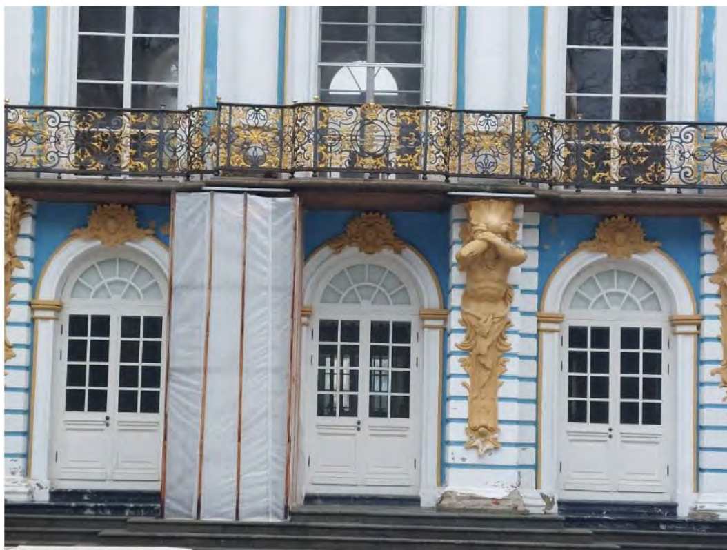
Фото 02. Павильон Эрмитаж. Восточный фасад. Фрагмент. Фигура аварийного атланта зашита в короб. Съёмка 12.11.2024 г.
