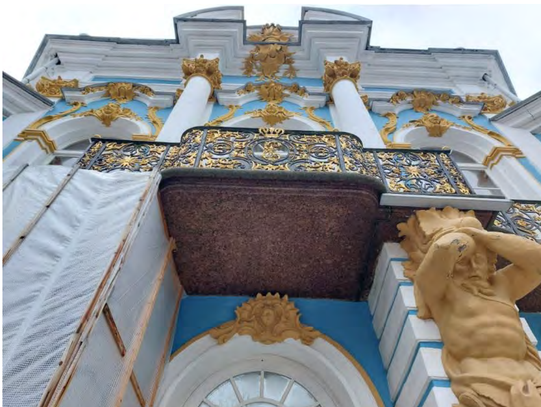
Фото 03. Павильон Эрмитаж. Восточный фасад. Фрагмент. Фигура аварийного атланта зашита в короб. Съёмка 12.11.2024 г.
