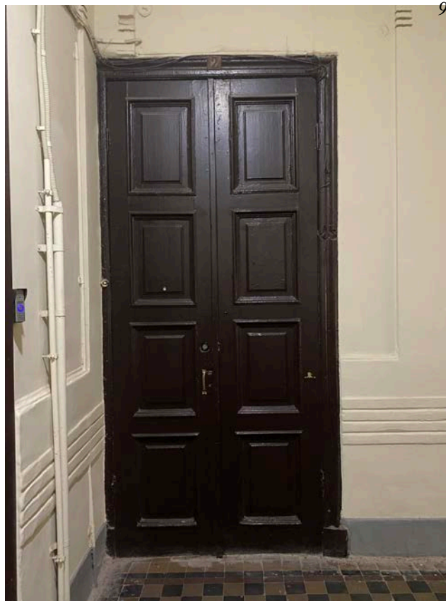
Фото 6. Вход в квартиру № 2 с парадной общедомовой лестничной клетки. Сохранившееся историческое дверное заполнение.
