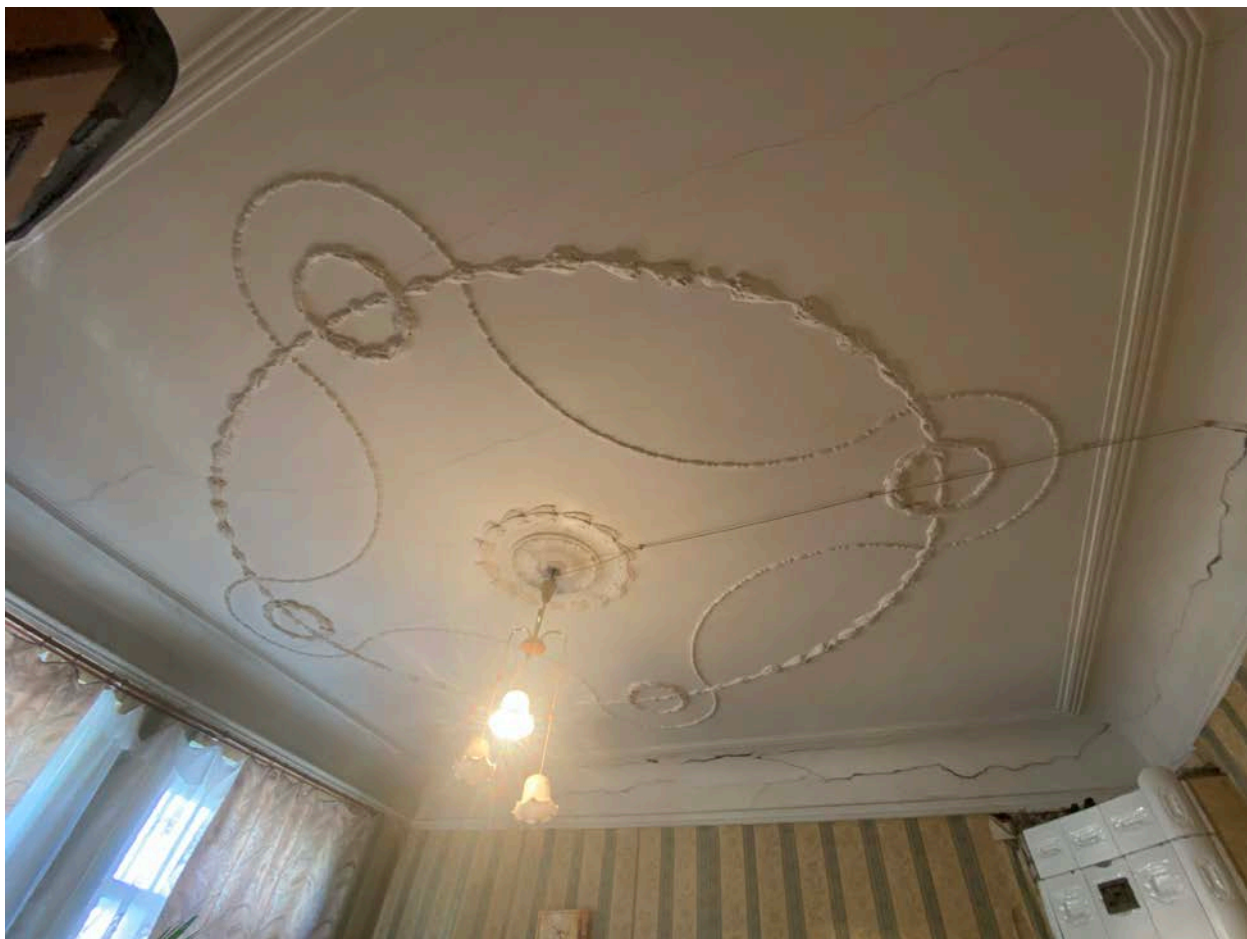
Фото 15. Помещение № 3. Комната. Потолок на высокой падаге; по периметру потолка профилированная штукатурная тяга; в центре потолка круглая лепная розетка в виде пучка из листьев аканта, обрамленного лавровым венком; по всему полю потолка лепные лавровые гирлянды, лепные украшения в виде «бус» и лавровых венков. Вид с запада.
