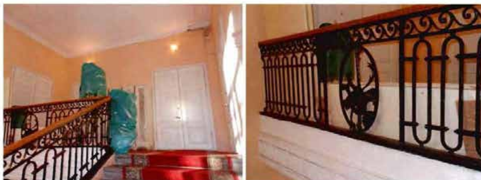
73, 74. Интерьеры и техническое состояние квартир (кв. 46, 47, 48)
