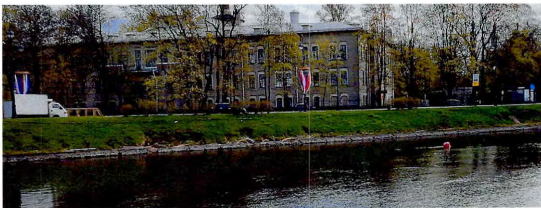
Нарушенное берегоукрепление правого берега выше Восточного Артиллерийского моста.
