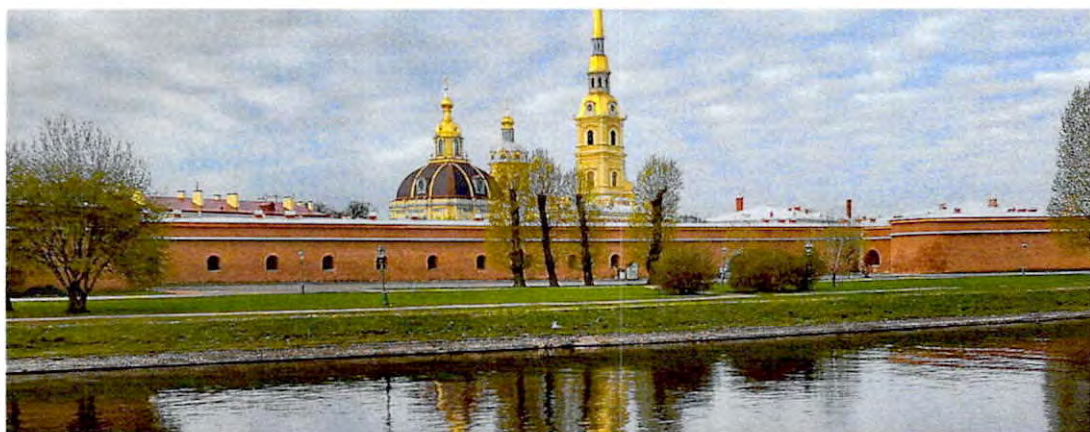
Нарушенное берегоукрепление левого берега.
