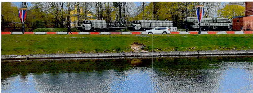
Нарушение берегоукрепления правого берега.
