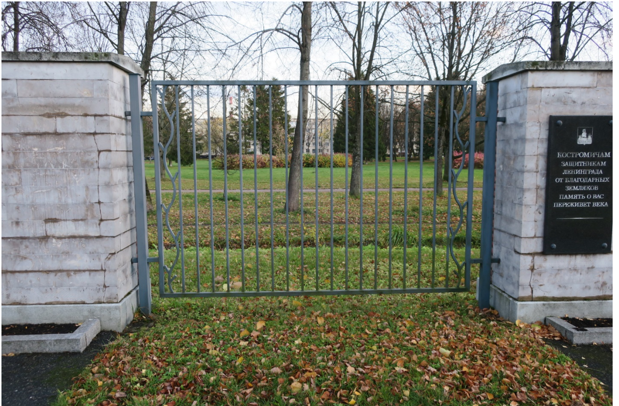
21. Восточная ограда вдоль аллеи Памяти объекта культурного наследия федерального значения «Кладбище Пискаревское», расположенного по адресу: г. Санкт-Петербург, пр. Непокоренных, д. 72 литера А. Фрагмент. 15.10.2021
