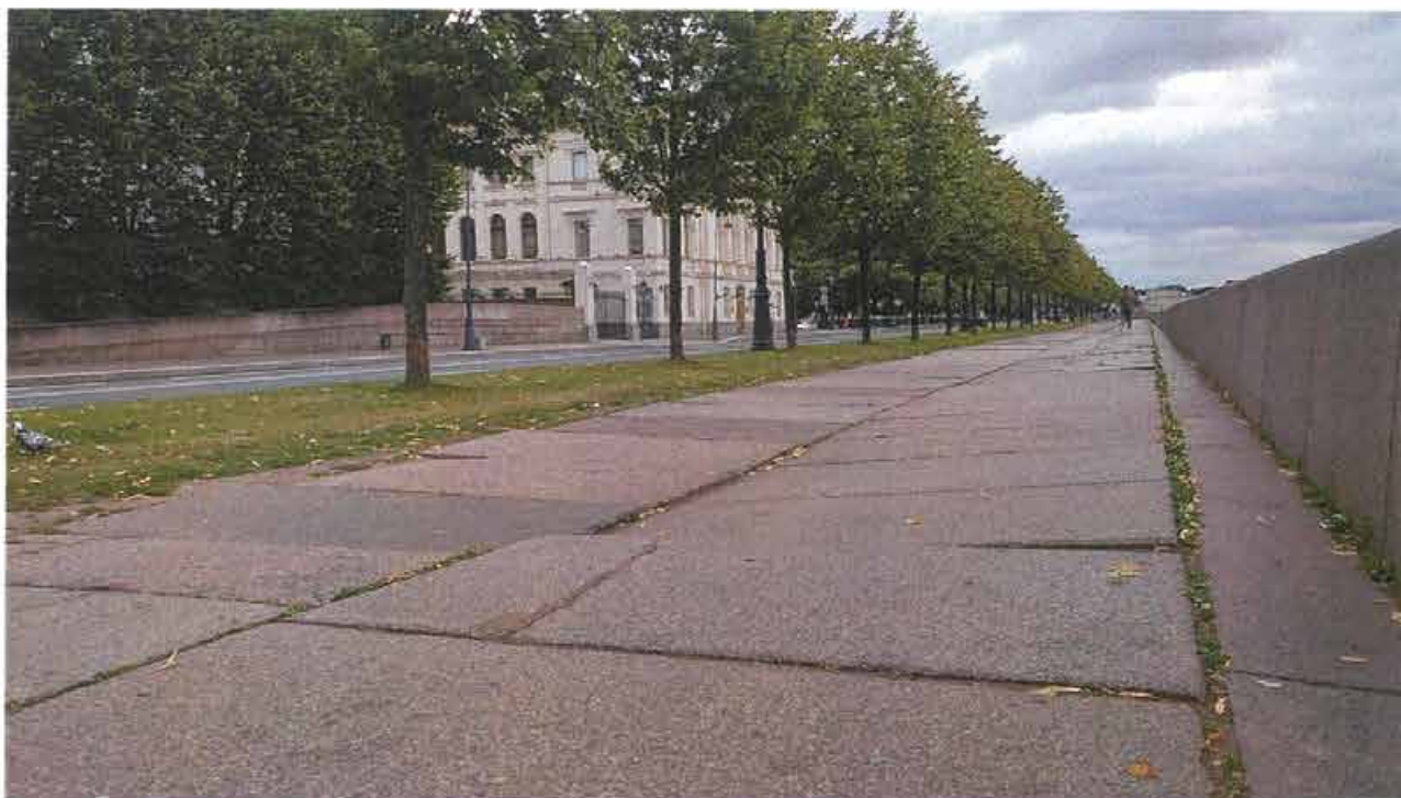
3. Нарушение геометрии гранитного настила набережной
