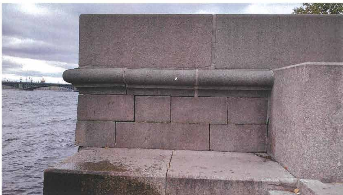
3. Утрата шовного заполнения между гранитными элементами пристани
