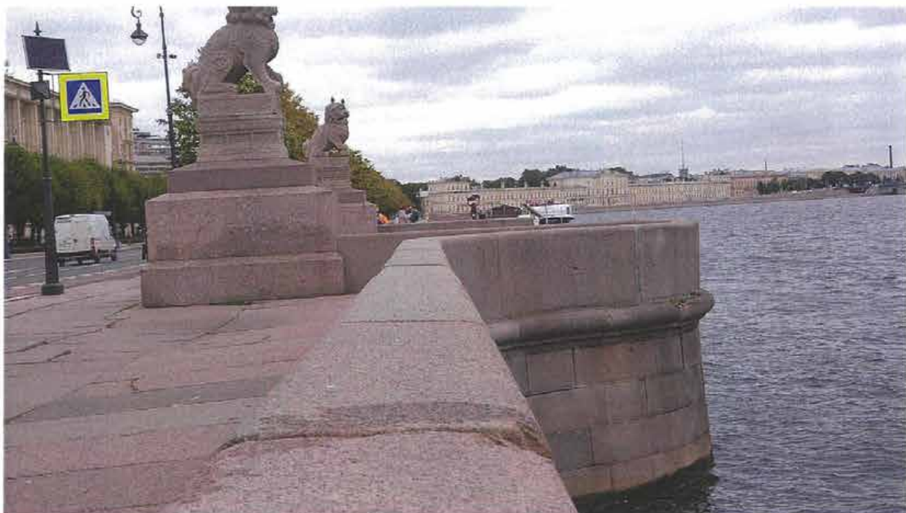
2. Просадка гранитного настила на прилегающей территории
