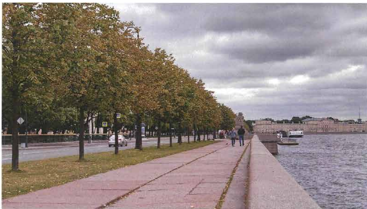
4. Нарушение геометрии ограждения набережной
