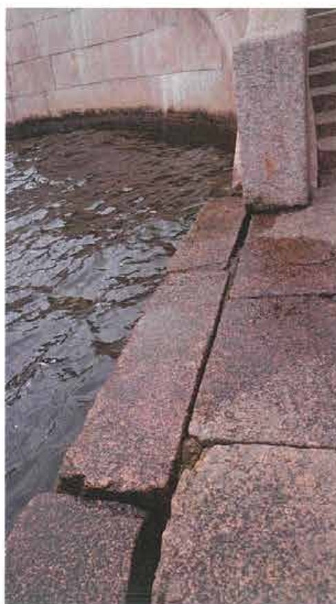
5. Нарушение примыкания гранитного элемента спуска набережной
