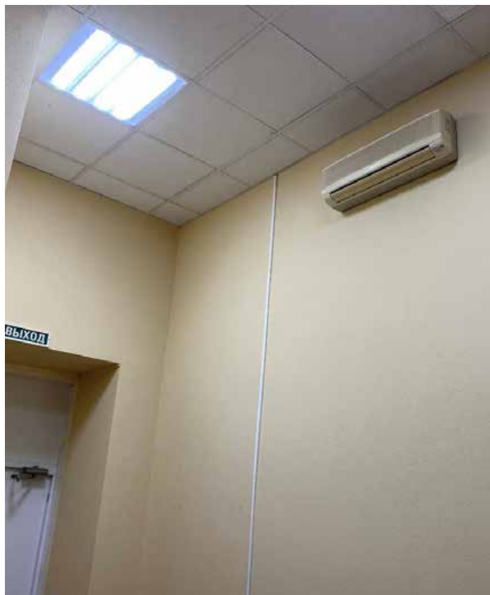
Фото 3, 3 этаж. Внутренний блок кондиционирования
