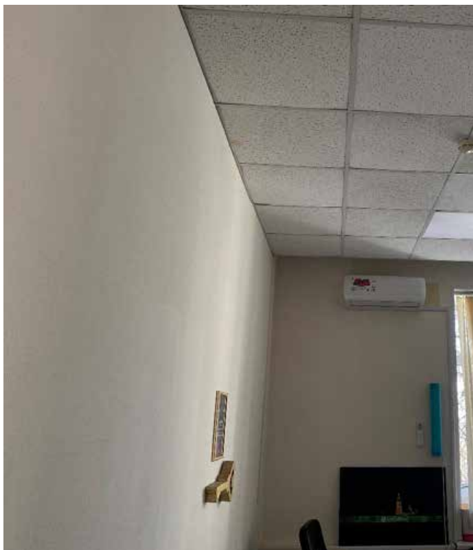
Фото 17, 3 этаж. Внутренний блок кондиционирования
