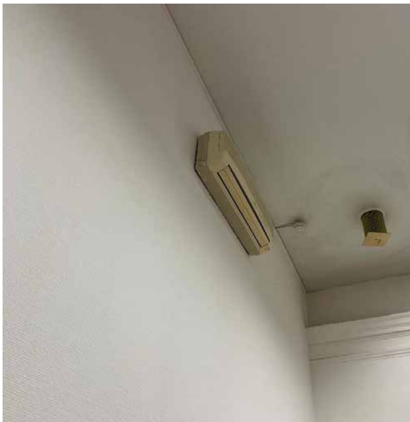
Фото 15, 3 этаж. Внутренний блок кондиционирования
