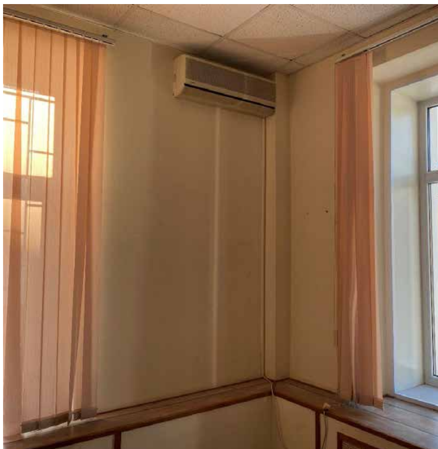
Фото 2, 2 этаж. Кабинет. Внутренний блок кондиционирования
