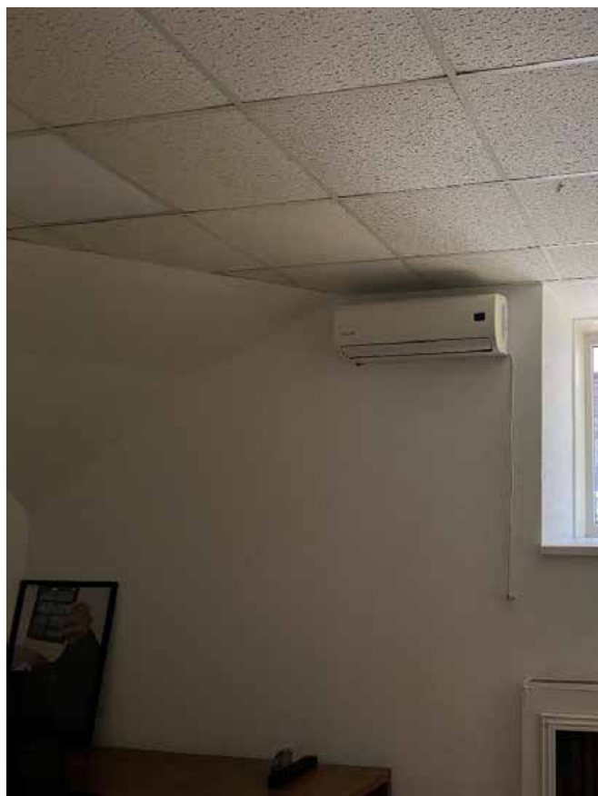
Фото 4, 1 этаж. Внутренний блок кондиционирования
