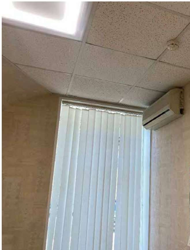
Фото 7, 1 этаж. Внутренний блок кондиционирования
