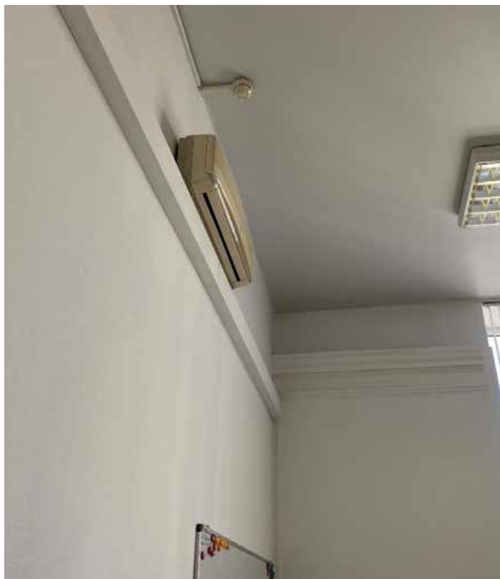
Фото 13, 3 этаж. Внутренний блок кондиционирования
