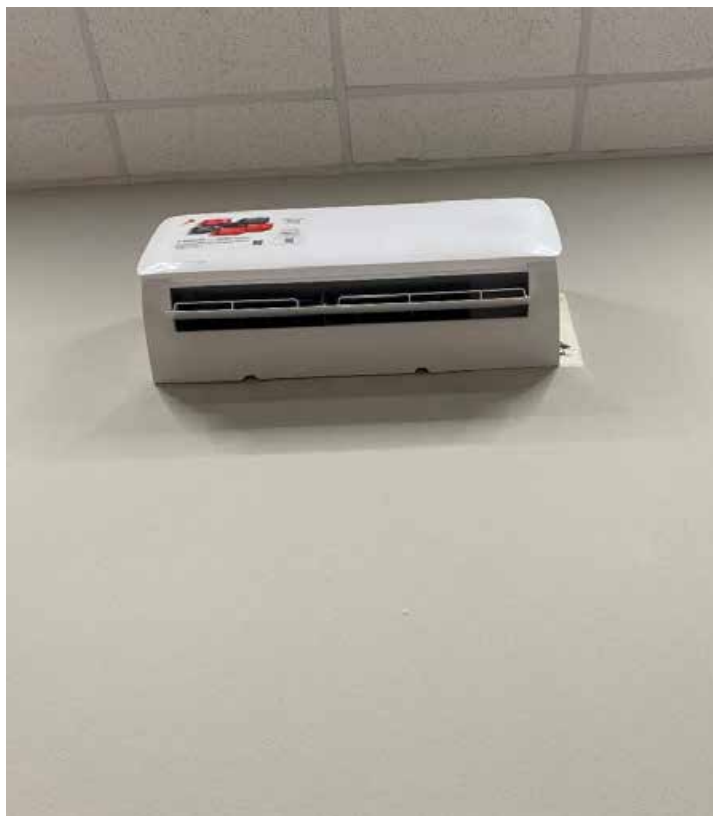
Фото 11, 3 этаж. Внутренний блок кондиционирования
