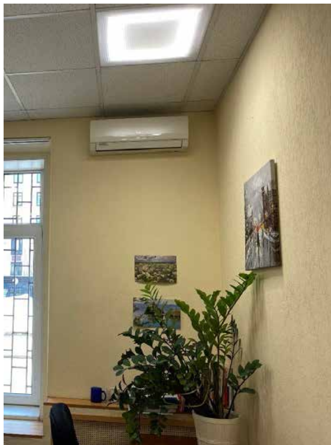
Фото 5, 2 этаж. Кабинет. Внутренний блок кондиционирования
