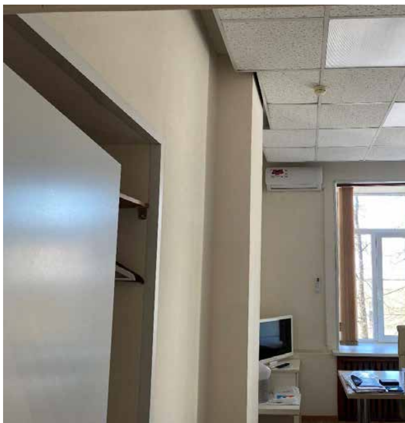
Фото 16, 3 этаж. Внутренний блок кондиционирования
