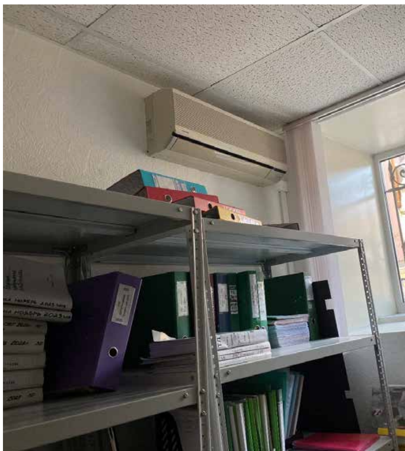
Фото 6, 1 этаж. Внутренний блок кондиционирования
