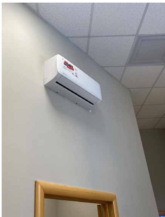
Фото 8, 3 этаж. Внутренний блок кондиционирования
