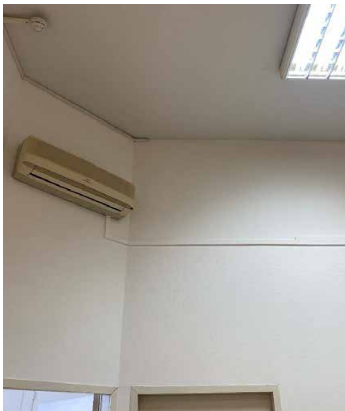
Фото 12, 3 этаж. Внутренний блок кондиционирования
