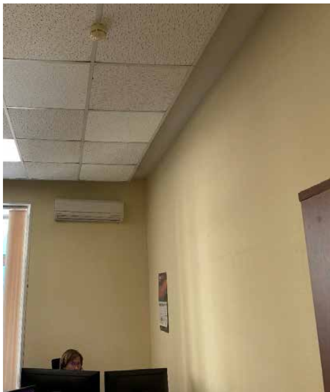
Фото 19, 3 этаж. Внутренний блок кондиционирования
