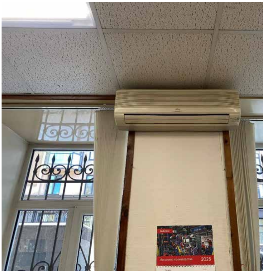
Фото 9, 1 этаж. Внутренний блок кондиционирования
