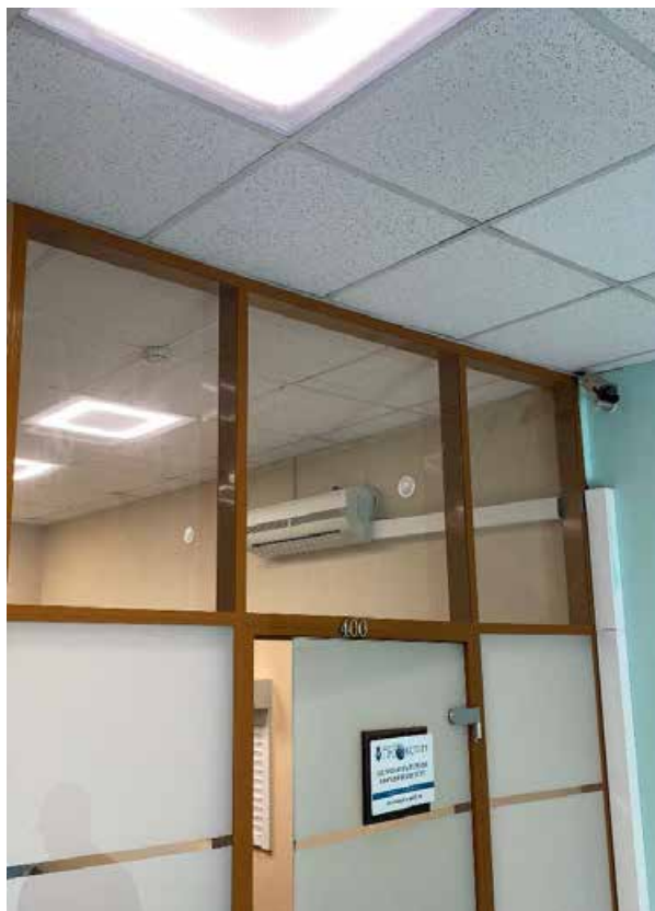
Фото 1, 4 этаж. Внутренний блок кондиционирования. Трасса, соединяющая блоки кондиционирования
