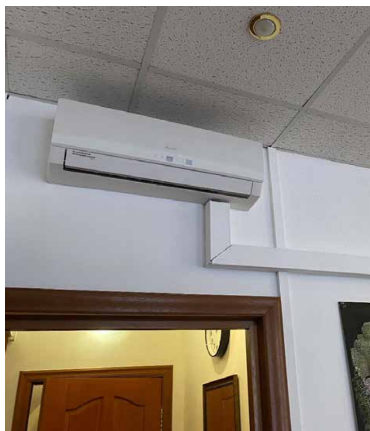
Фото 2, 1 этаж. Внутренний блок кондиционирования
