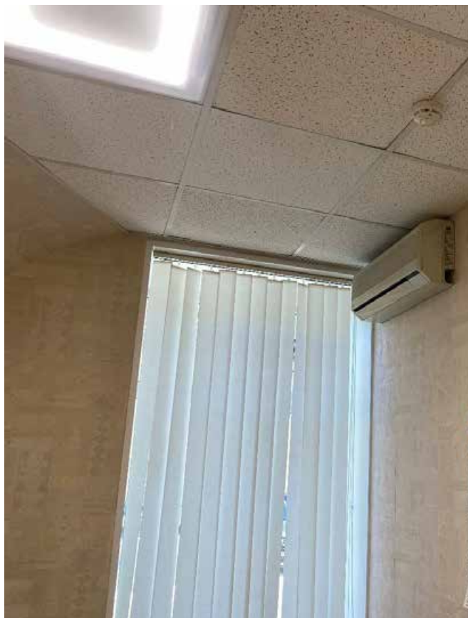
Фото 7, 1 этаж. Внутренний блок кондиционирования
