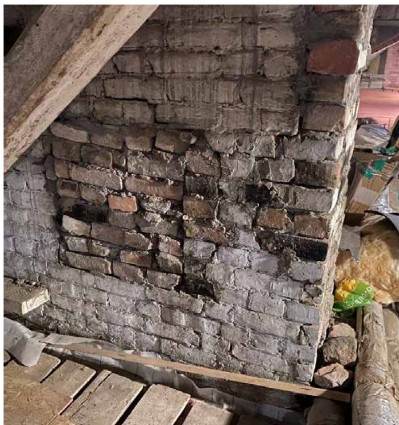
Фото 12. Чердак, разрушение кирпичной кладки
