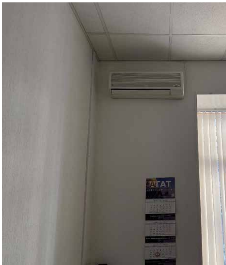
Фото 16, 2 этаж. Внутренний блок кондиционирования
