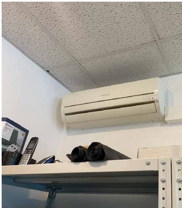
Фото 1, 1этаж. Внутренний блок кондиционирования
