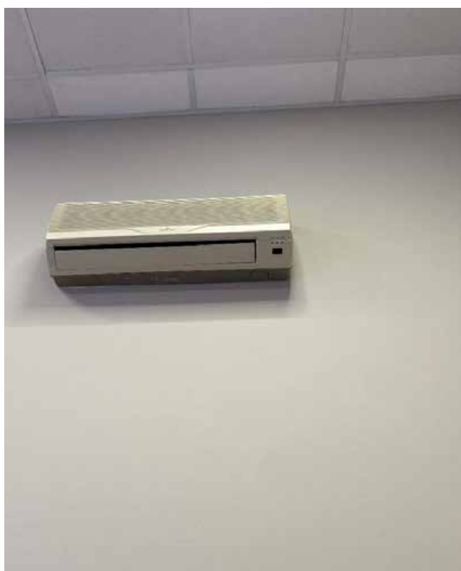
Фото 10, 3 этаж. Внутренний блок кондиционирования
