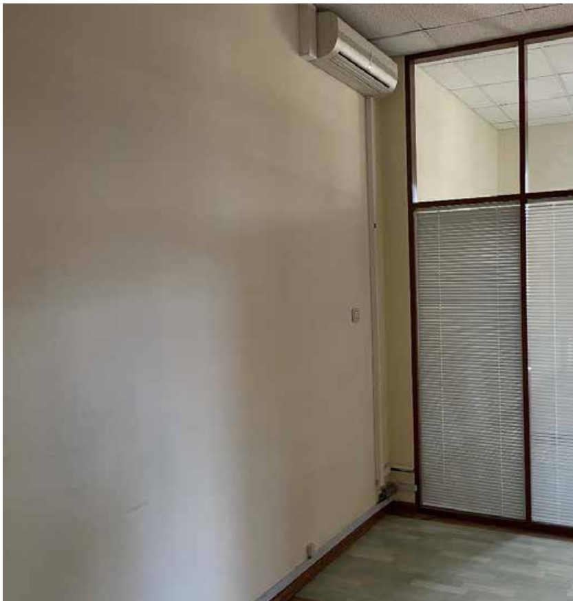
Фото 3, 2 этаж. Кабинет. Внутренний блок кондиционирования
