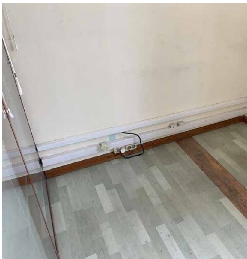
Фото 4, 2 этаж. Кабинет. Трассы соединяющие блоки кондиционирования
