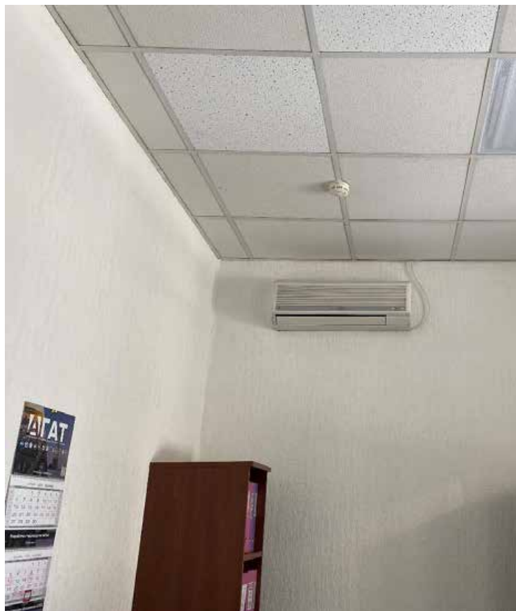
Фото 17, 2 этаж. Внутренний блок кондиционирования
