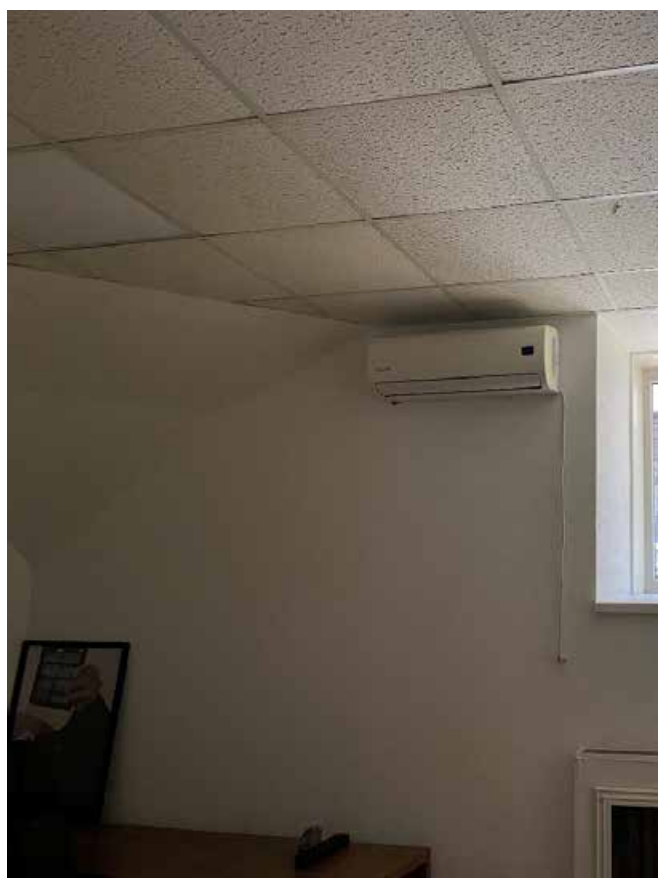
Фото 4, 1 этаж. Внутренний блок кондиционирования
