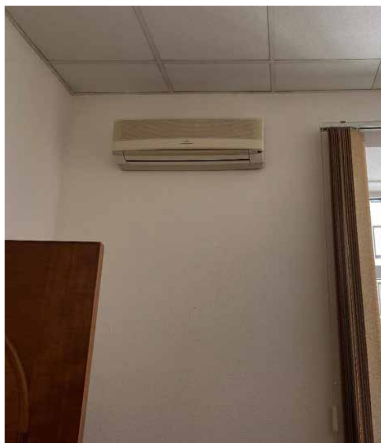
Фото 18, 2 этаж. Внутренний блок кондиционирования
