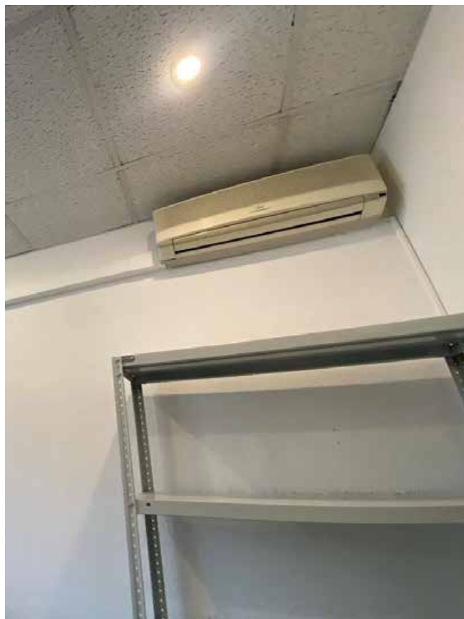
Фото 3, 1 этаж. Внутренний блок кондиционирования
