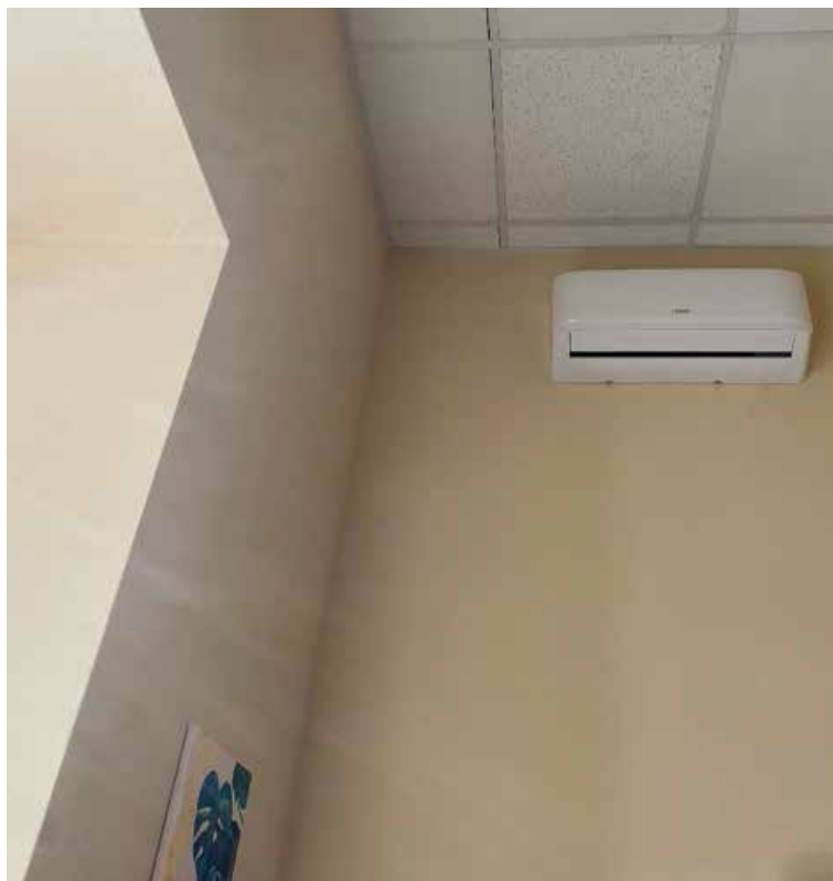
Фото 5, 3 этаж. Внутренний блок кондиционирования
