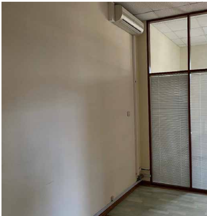
Фото 3, 2 этаж. Кабинет. Внутренний блок кондиционирования
