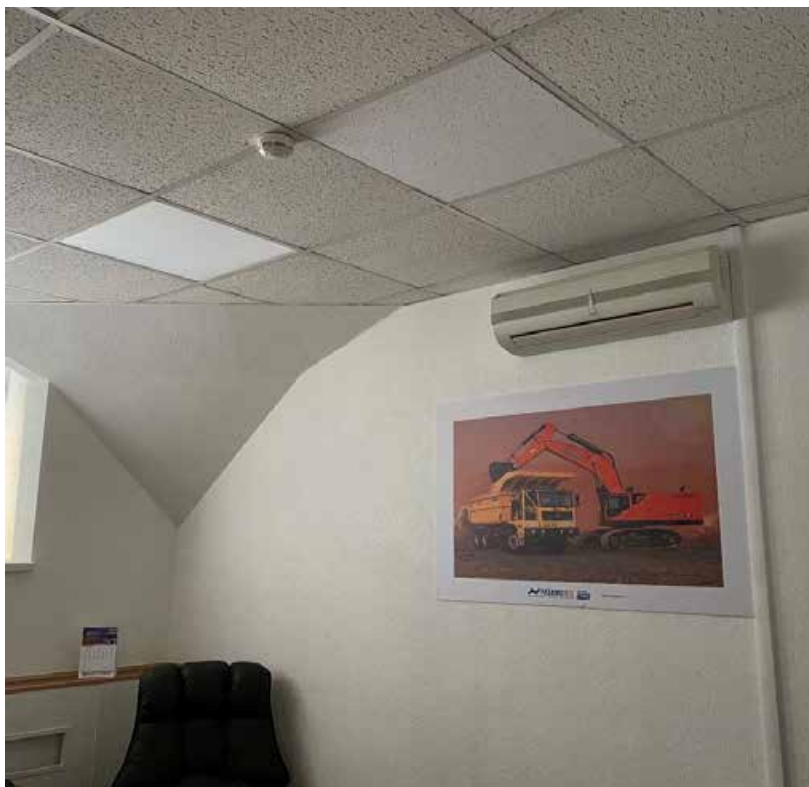
Фото 5, 1 этаж. Внутренний блок кондиционирования
