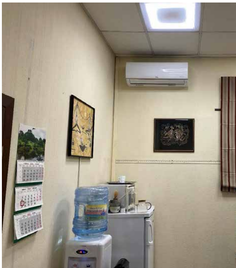
Фото 14, 2 этаж. Внутренний блок кондиционирования
