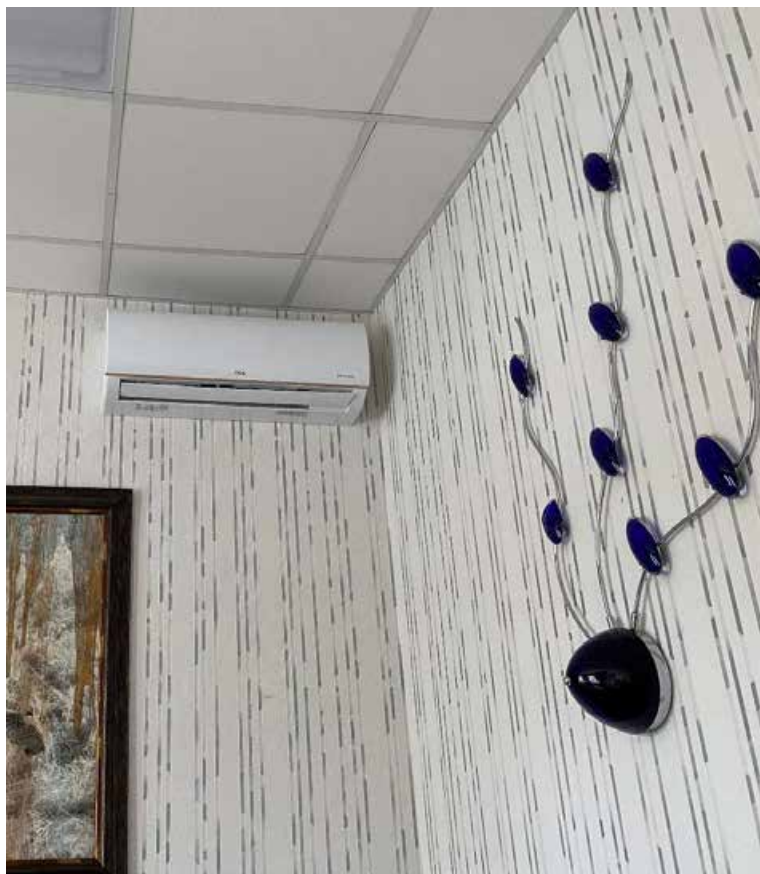
Фото 15, 2 этаж. Внутренний блок кондиционирования
