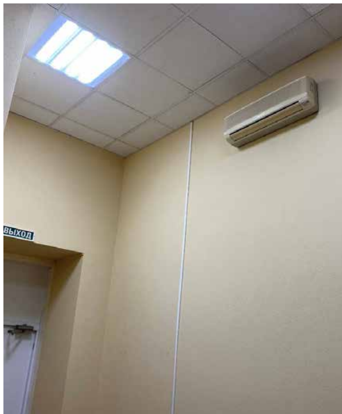
Фото 3, 3 этаж. Внутренний блок кондиционирования
