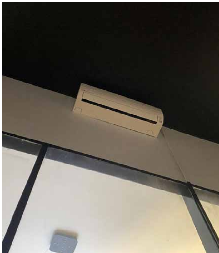
Фото 7, 3 этаж. Внутренний блок кондиционирования
