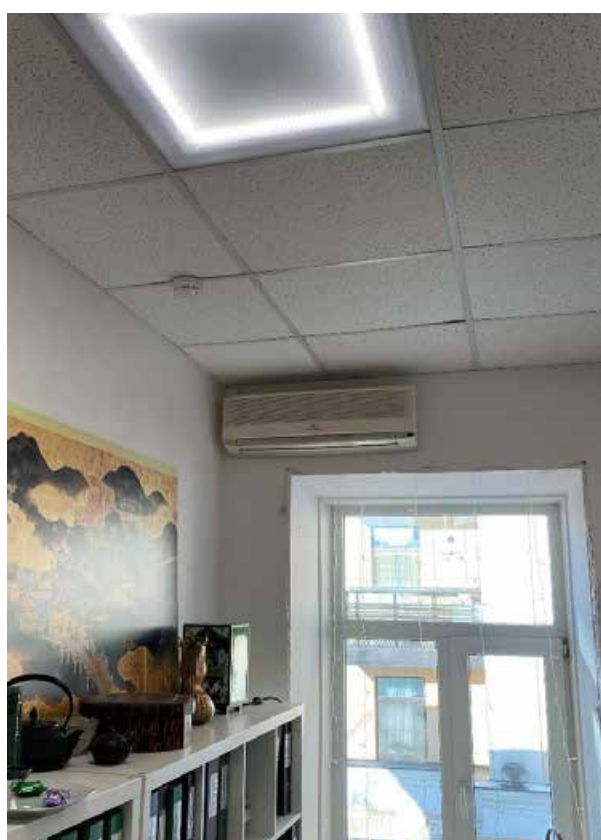
Фото 2, 4 этаж. Внутренний блок кондиционирования
