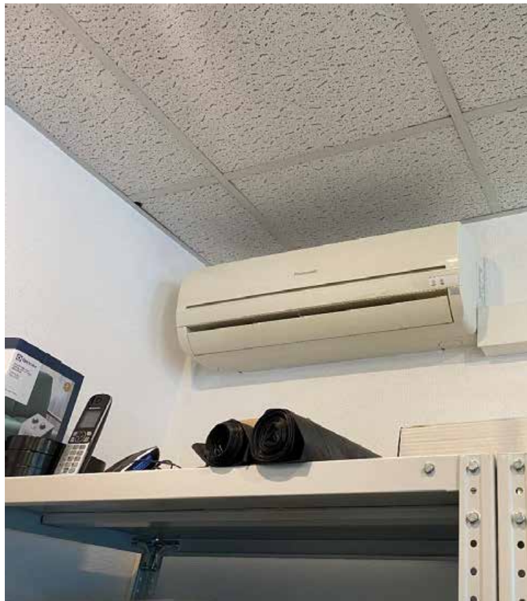
Фото 1, 1этаж. Внутренний блок кондиционирования
