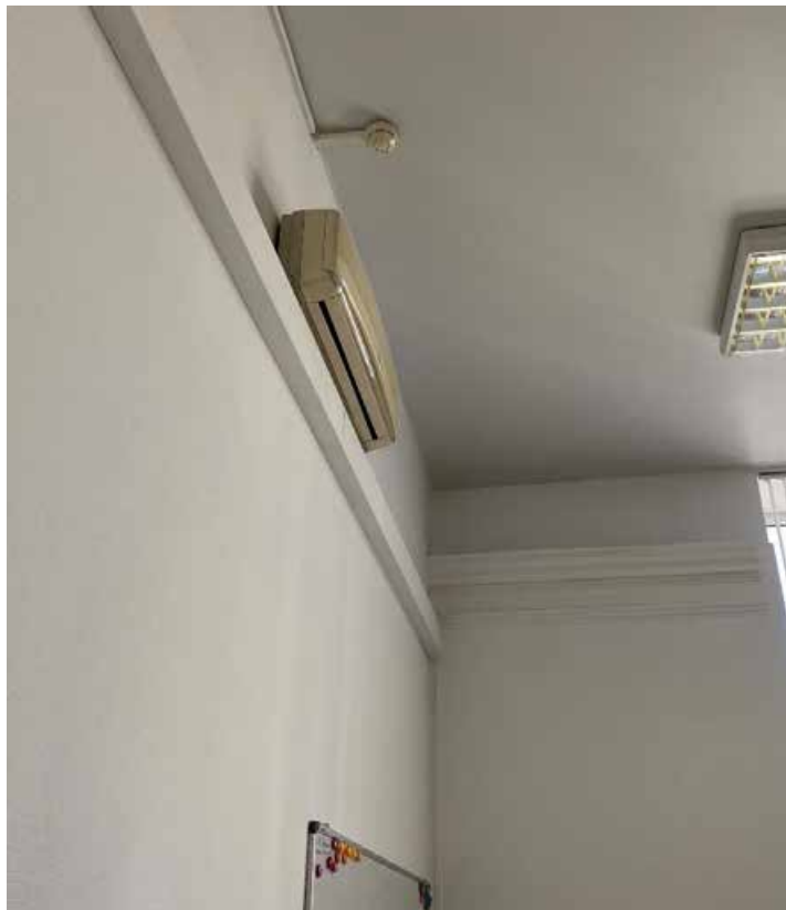
Фото 13, 3 этаж. Внутренний блок кондиционирования
