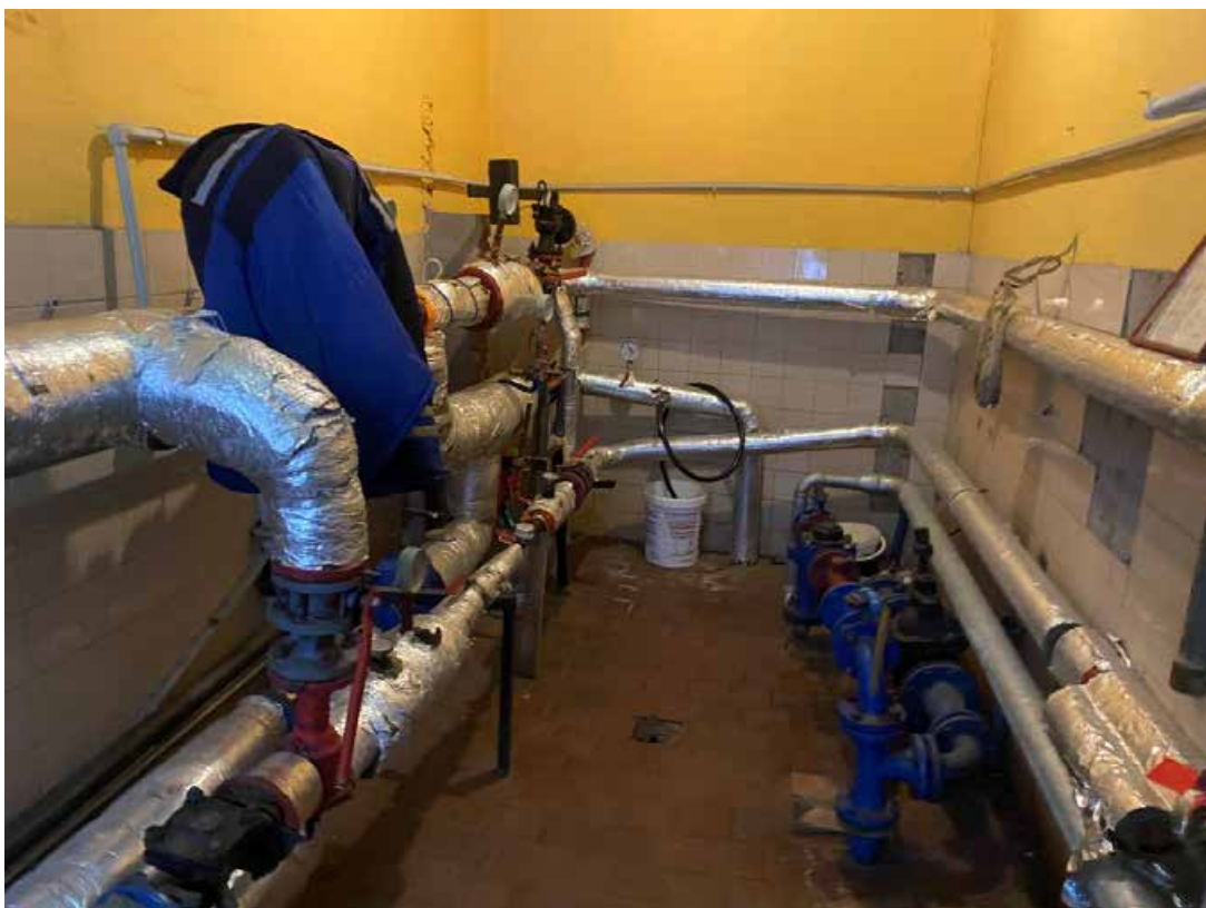
Фото 14, 1 этаж. Общий вид ИТП узла холодного водоснабжения
