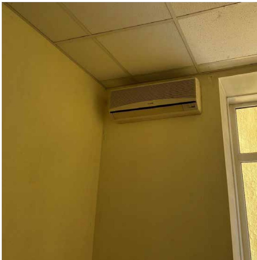
Фото 9, 2 этаж. Внутренний блок кондиционирования
