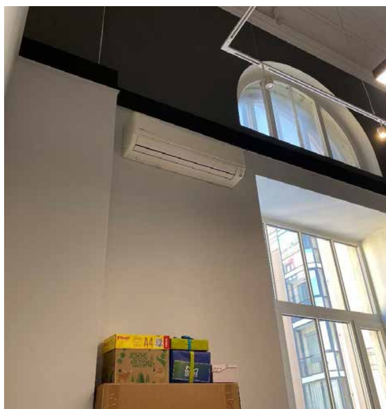
Фото 6, 3 этаж. Внутренний блок кондиционирования
