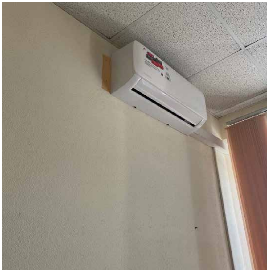
Фото 1, 2 этаж. Внутренний блок кондиционирования
