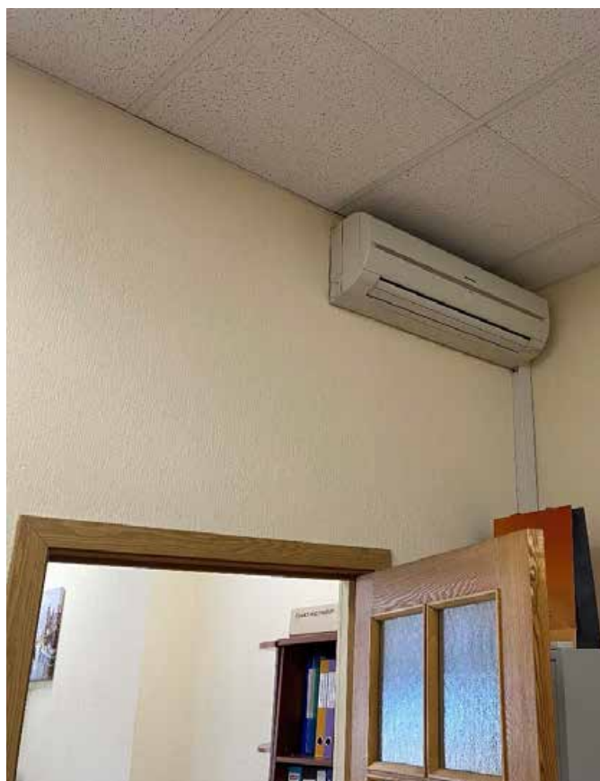
Фото 6, 2 этаж. Внутренний блок кондиционирования
