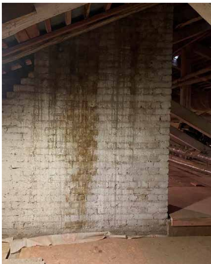
Фото 2. Чердак, протечки кровли на кирпичную кладку
