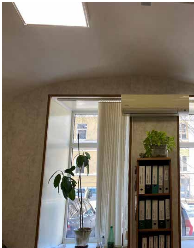
Фото 8, 1 этаж. Внутренний блок кондиционирования
