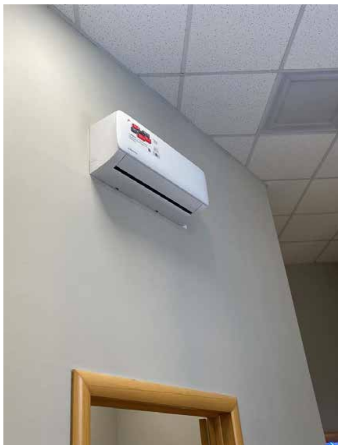
Фото 8, 3 этаж. Внутренний блок кондиционирования
