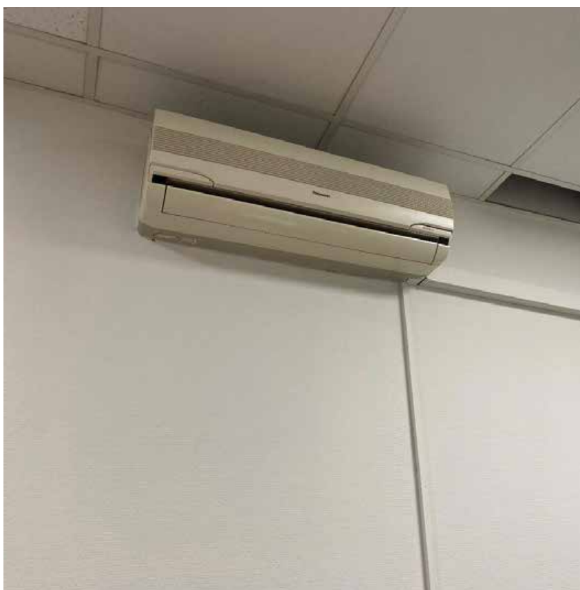
Фото 10, 1 этаж. Внутренний блок кондиционирования
