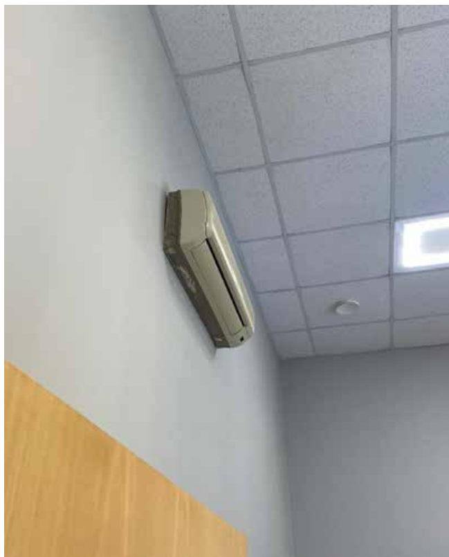
Фото 9, 3 этаж. Внутренний блок кондиционирования
