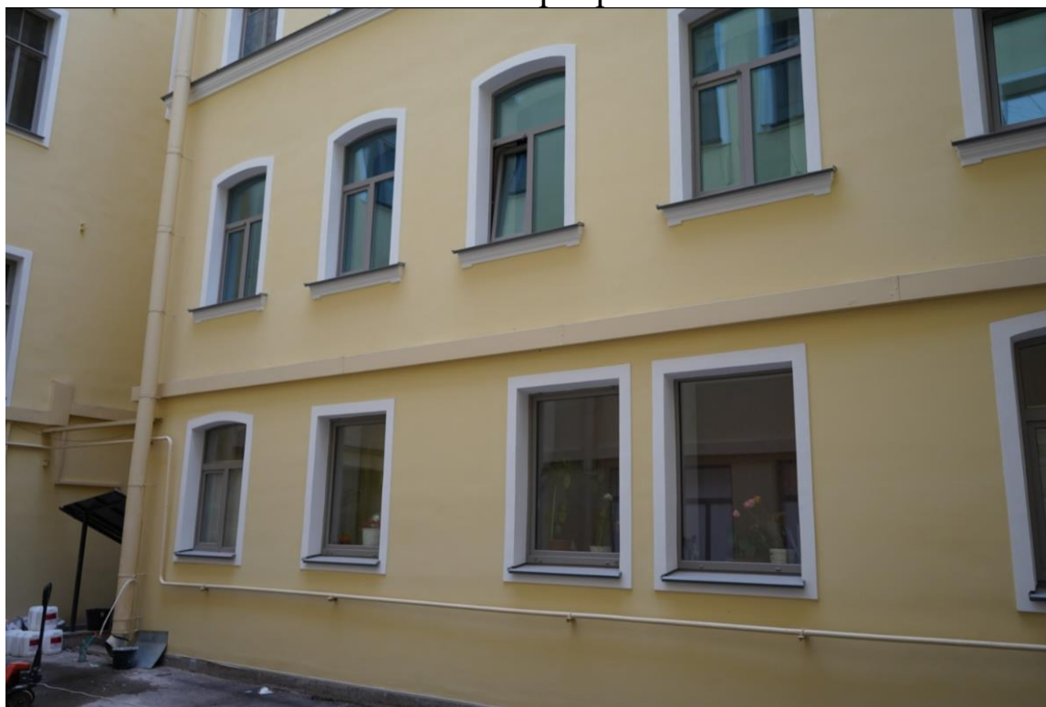
4. Дворовый фасад объекта культурного наследия регионального значения «Дом А.П. Романова», расположенного по адресу: г. Санкт-Петербург, Солдатский переулок, д. 1/23, литера А. Окна квартиры №13.
