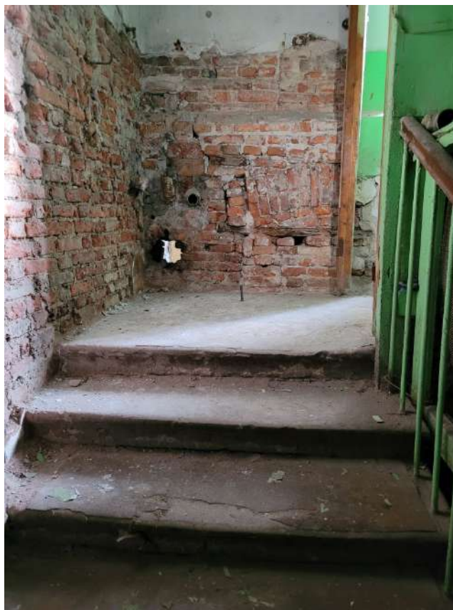
15. ВОКН «Воздвиженское городское мужское училище». Междуэтажная площадка лестницы. Следы заложения оконного исторического проема. Дата съемки: 10.02.2025г.
