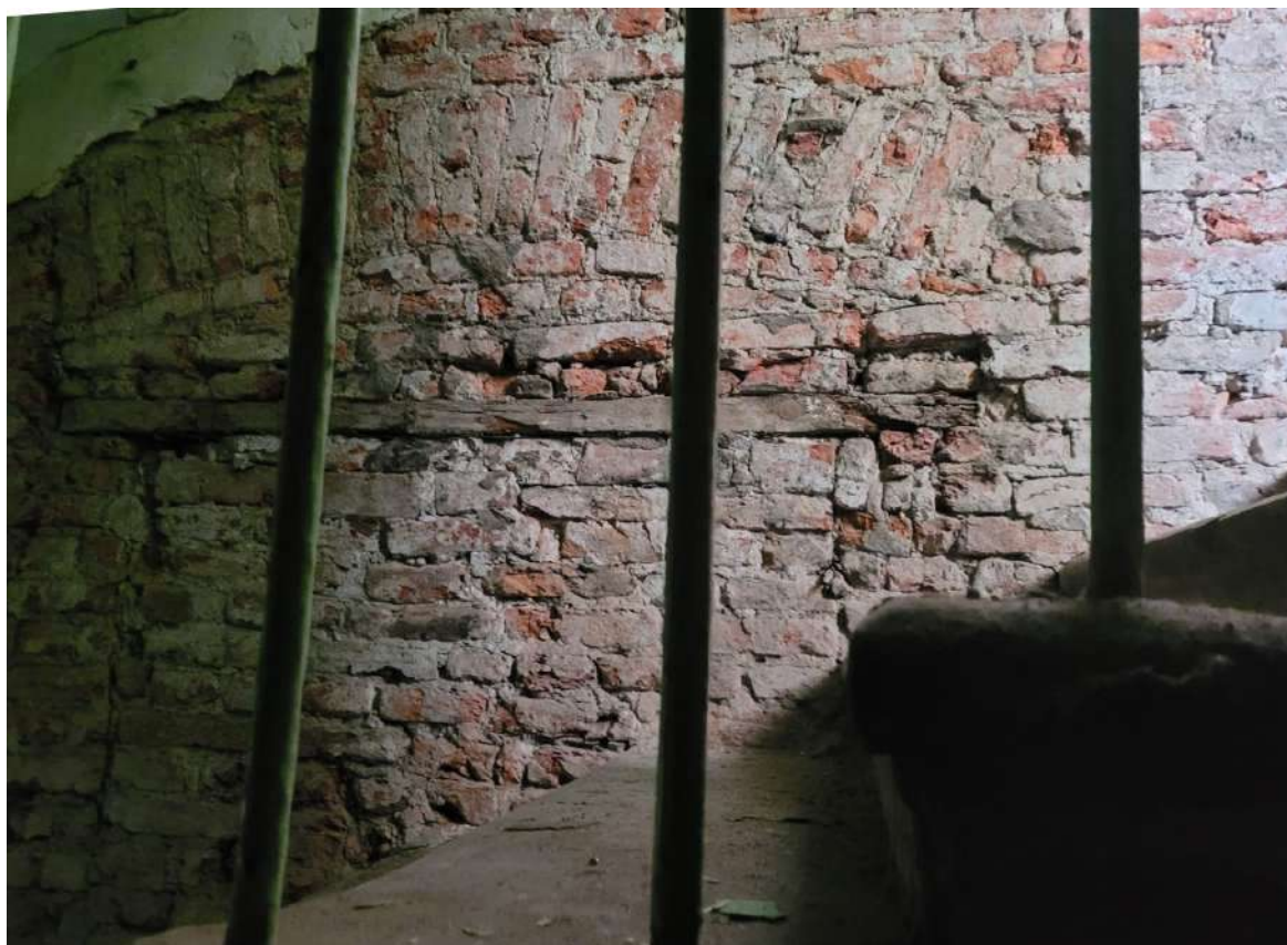
4. ВОКН «Воздвиженское городское мужское училище». Следы заложения дверного исторического проема. Дата съемки: 10.02.2025г.
