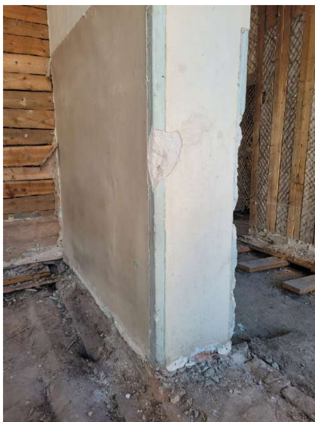
28. ВОКН «Воздвиженское городское мужское училище». Интерьеры 2-го этажа. Фрагмент несущей стены. Дата съемки: 10.02.2025г.
