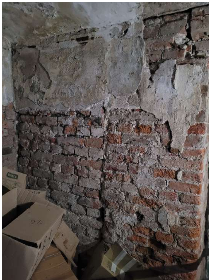
1. ВОКН «Воздвиженское городское мужское училище». Заложенный дверной исторический проем. Дата съемки: 10.02.2025г.
