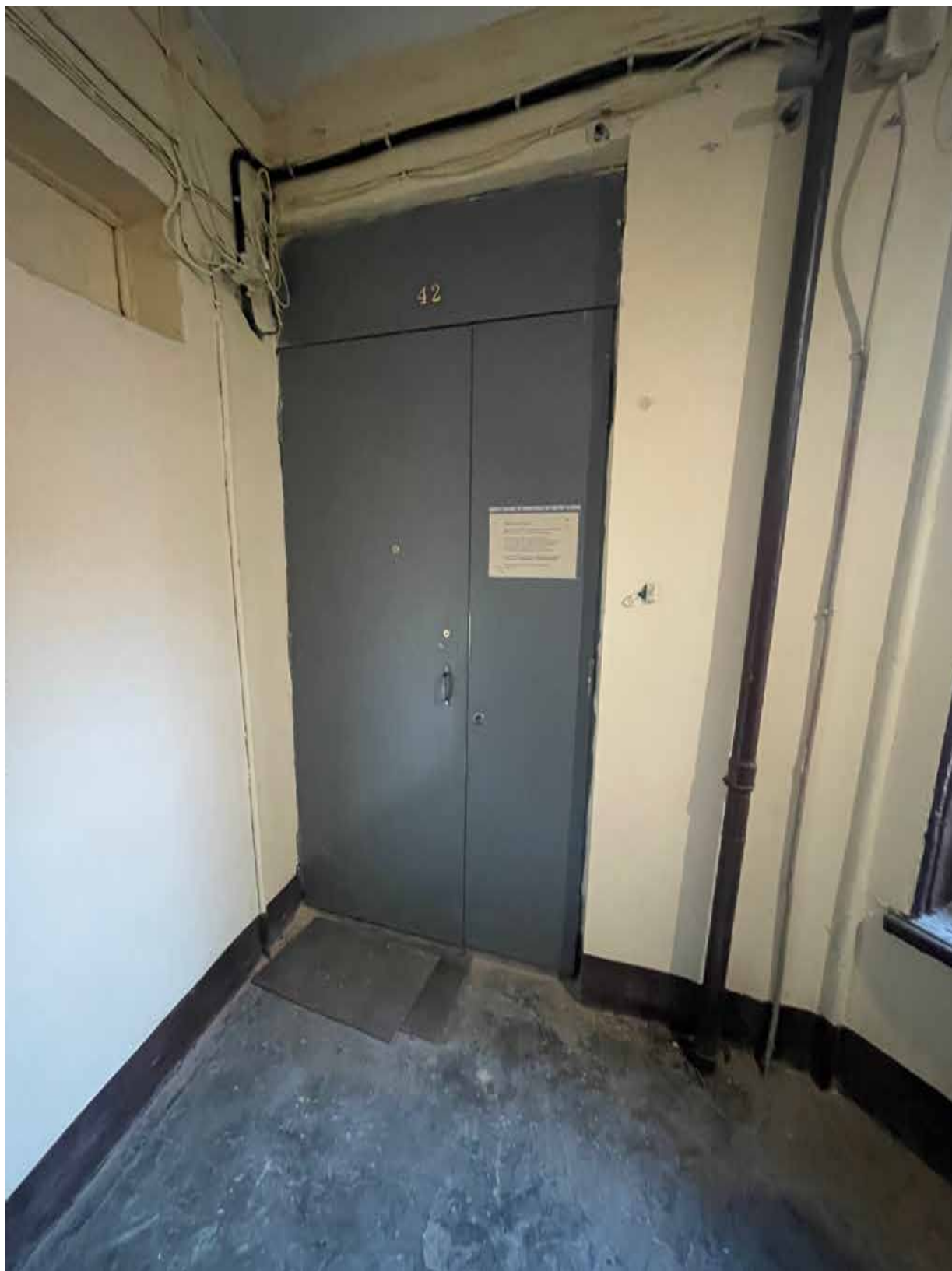
4. Входная дверь в квартиру № 42.
