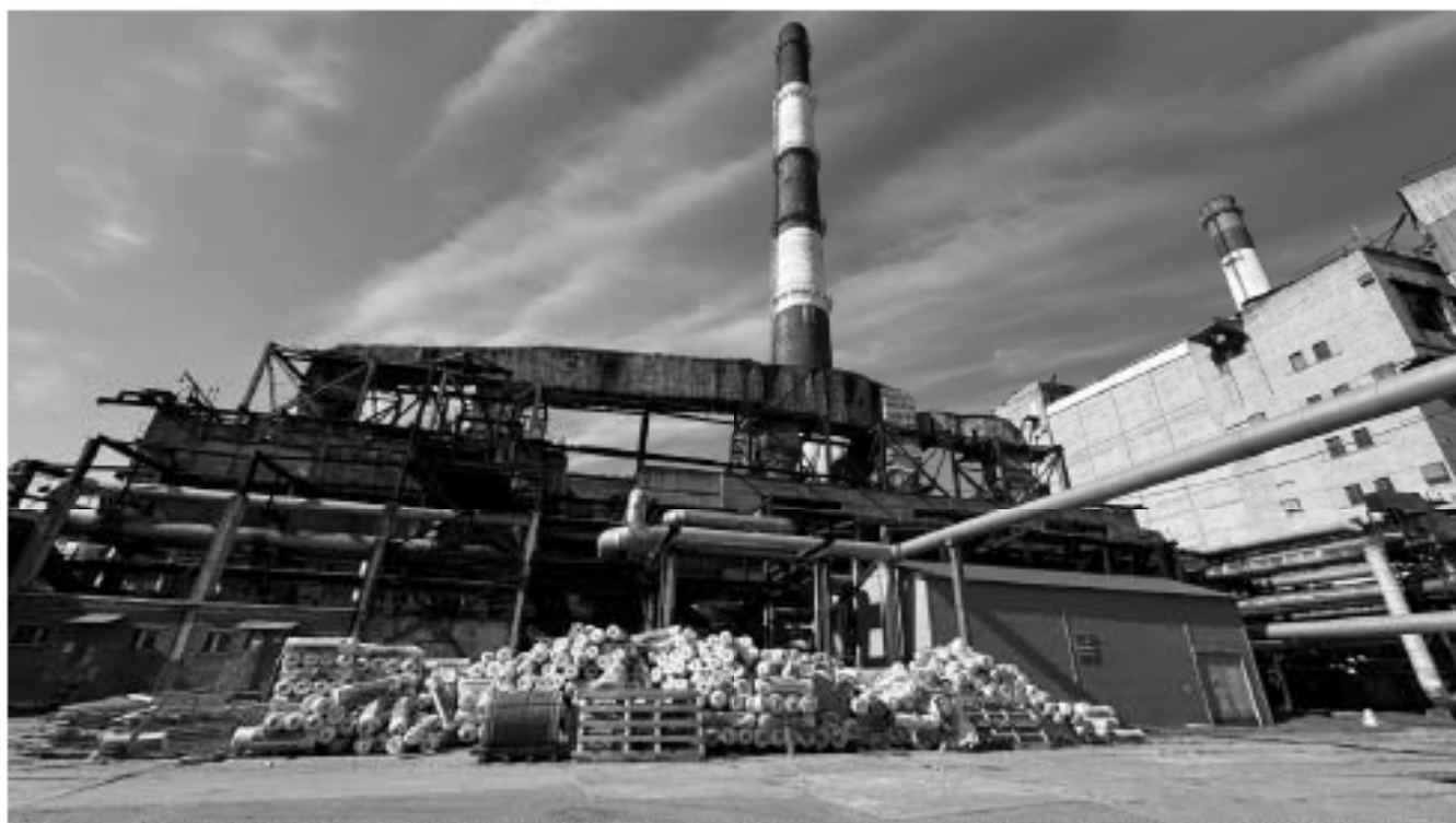
7. Восточный фасад объекта культурного наследия (объект культурного наследия регионального значения «Котельная ТЭЦ-2» в составе объекта культурного наследия регионального значения «Петроградское общество электрических сооружений (ТЭЦ-2)»).
