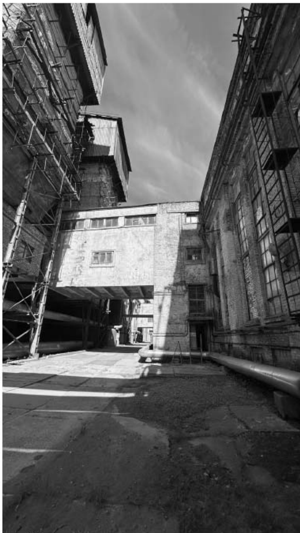
8. Вид с востока на переход между корпусами здания по адресу: Санкт-Петербург, Новгородская улица, дом 11, литера А.
