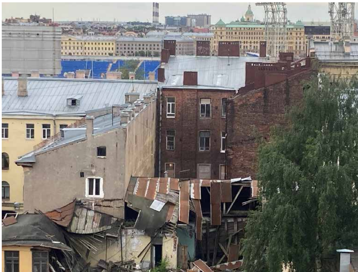
13. Объект демонтажа, расположенный по адресу: Санкт-Петербург, Малый проспект П.С., д. 4, литера А.
