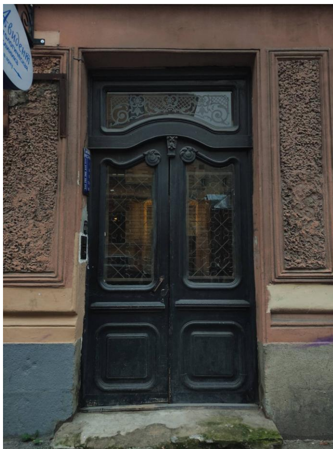
Фото 3. Фрагмент лицевого фасада выявленного объекта культурного наследия «Дом А.Г.Романова», входное дверное заполнение
