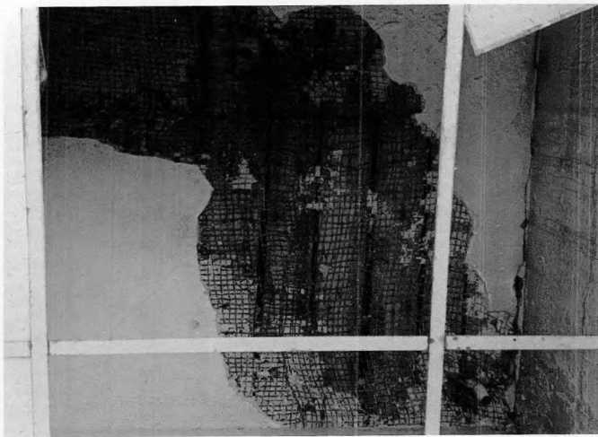
57. Повреждение отделочных слоев (помещение 17-Н ч.п. 15)
