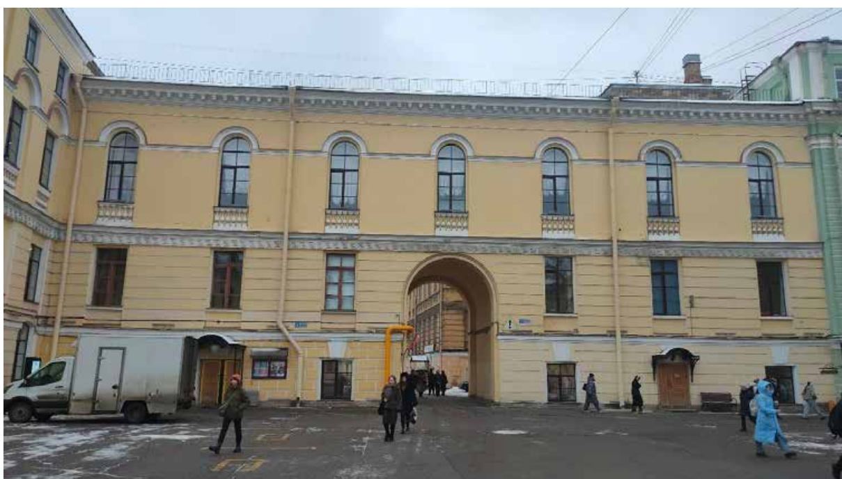
Фото 24. Фрагмент северо-западного фасада объекта культурного наследия федерального значения «Дворец Разумовского К.Г. Никольский сиротский институт», входящего в состав объекта культурного наследия федерального значения «Воспитательный дом Императорский», расположенный по адресу: Санкт-Петербург, наб. р. Мойки, д. 48, лит. А, корп. 5
