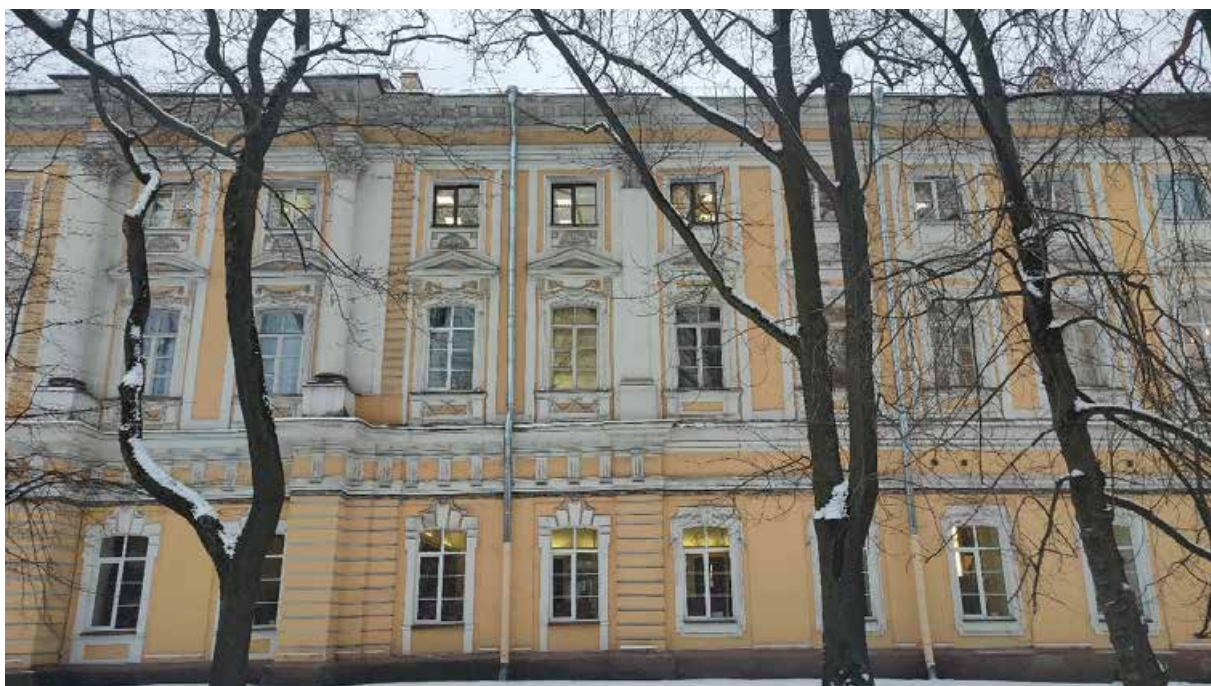
Фото 27. Фрагмент северо-западного фасада объекта культурного наследия федерального значения «Дворец Разумовского К.Г. Никольский сиротский институт», входящего в состав объекта культурного наследия федерального значения «Воспитательный дом Императорский», расположенный по адресу: Санкт-Петербург, наб. р. Мойки, д. 48, лит. А, корп. 5
