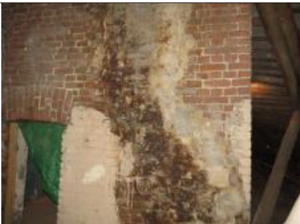
17.«Солдатская казарма с палисадником». Биопоражения кирпичной кладки.
