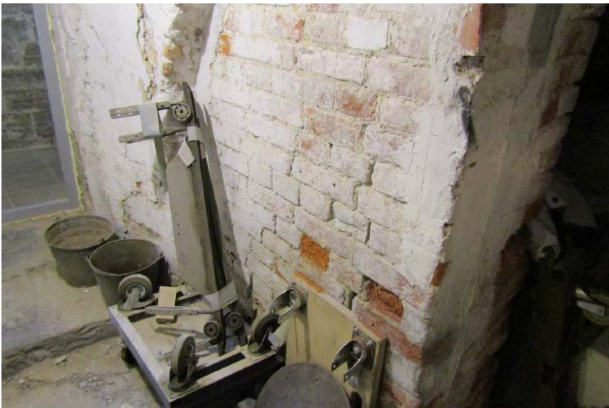
18. Стена подвала здания объекта культурного наследия федерального значения «Тетр Михайловский 1831-1833 гг., арх. Росси К.И., арх. Брюллов А.П.», расположенного по адресу: г. Санкт-Петербург, пл. Искусств, д. 1, литера А. 15.09.2020
