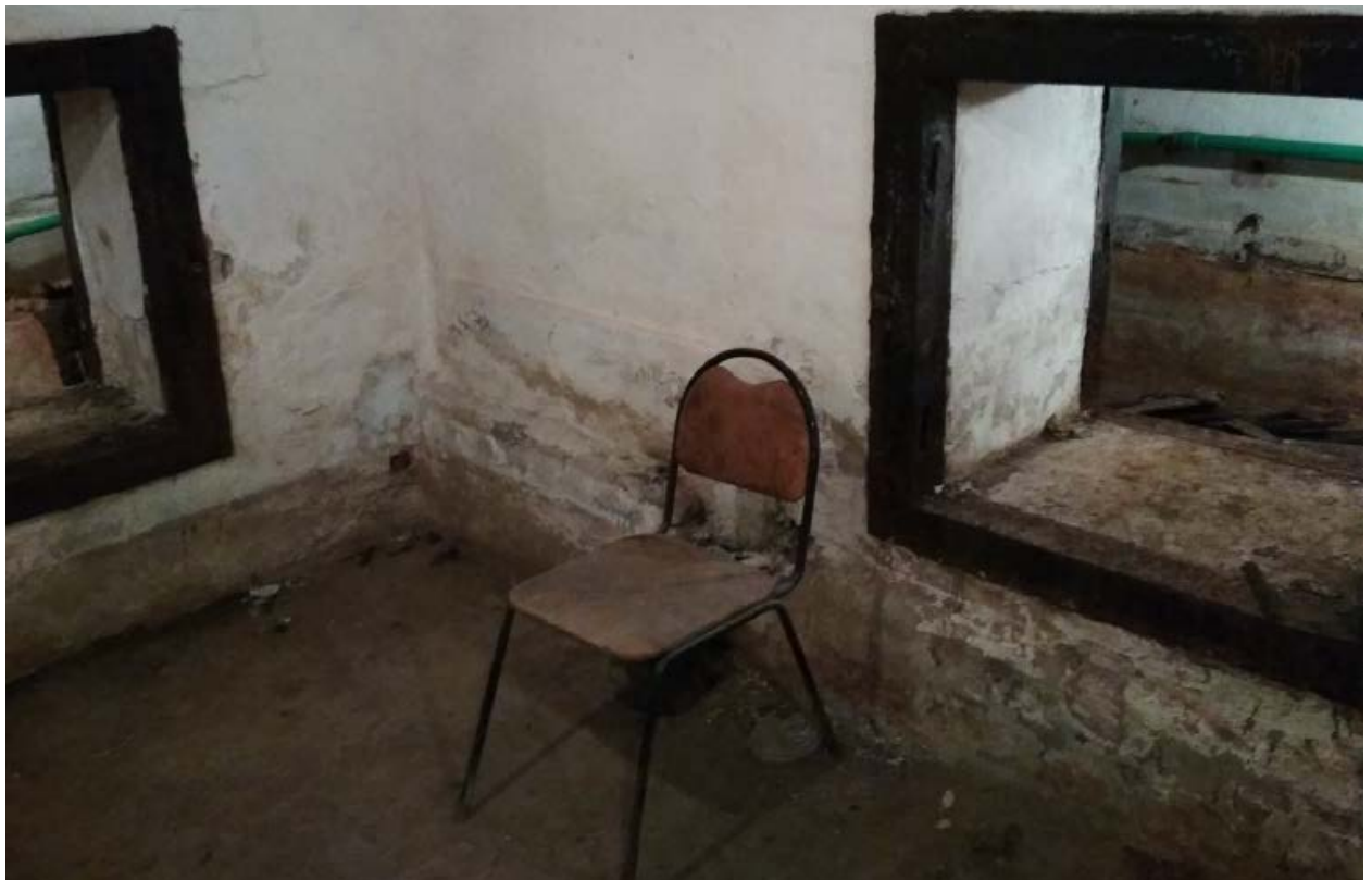
20. Стена и полы подвала здания объекта культурного наследия федерального значения «Дом Голенищева - Кутузова П.В., 1820-е гг., 1830-е гг. (фасады), арх. Росси К.И. Здесь в 1924 - 1939 гг. жил художник Бродский И.И.», расположенного по адресу: г. Санкт-Петербург, пл. Искусств, д. 3, литера А. 15.09.2020
