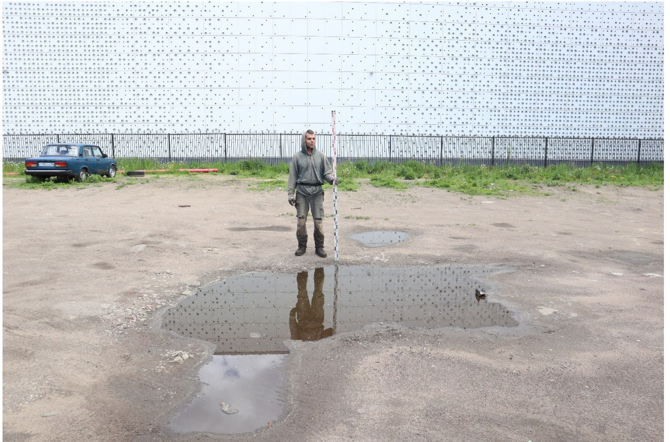
Рис. 34. Санкт-Петербург, Василеостровский р-н, Малый проспект В.О., участок 35, (у дома 68, корпус 3, литера Г). Шурф 2. Общий вид до начала работ. Вид на северо-восток.
