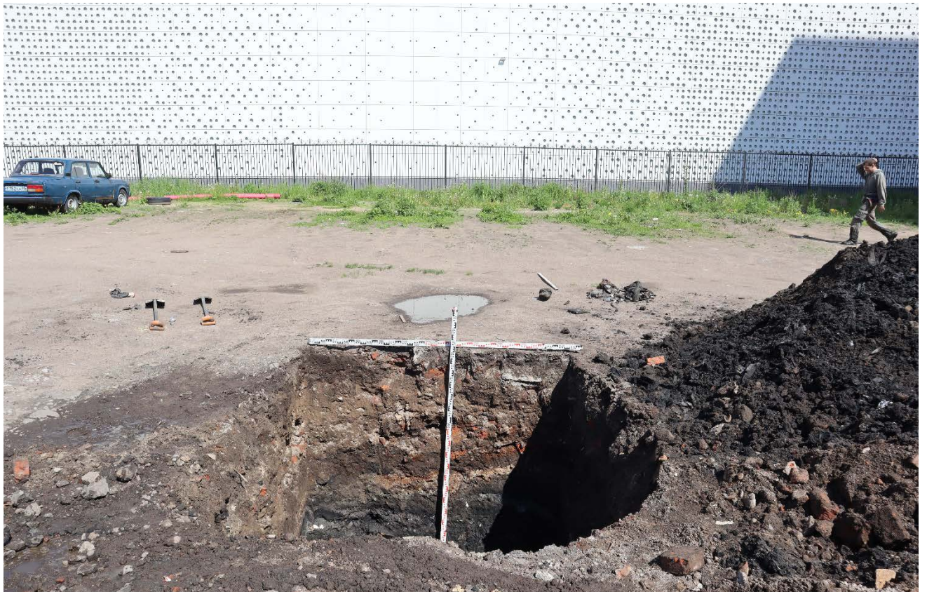
Рис. 41. Санкт-Петербург, Василеостровский р-н, Малый проспект В.О., участок 35, (у дома 68, корпус 3, литера Г). Шурф 2. Фотофиксация общего вида шурфа с окружающим пейзажем после остановки работ. Вид на северо-восток.
