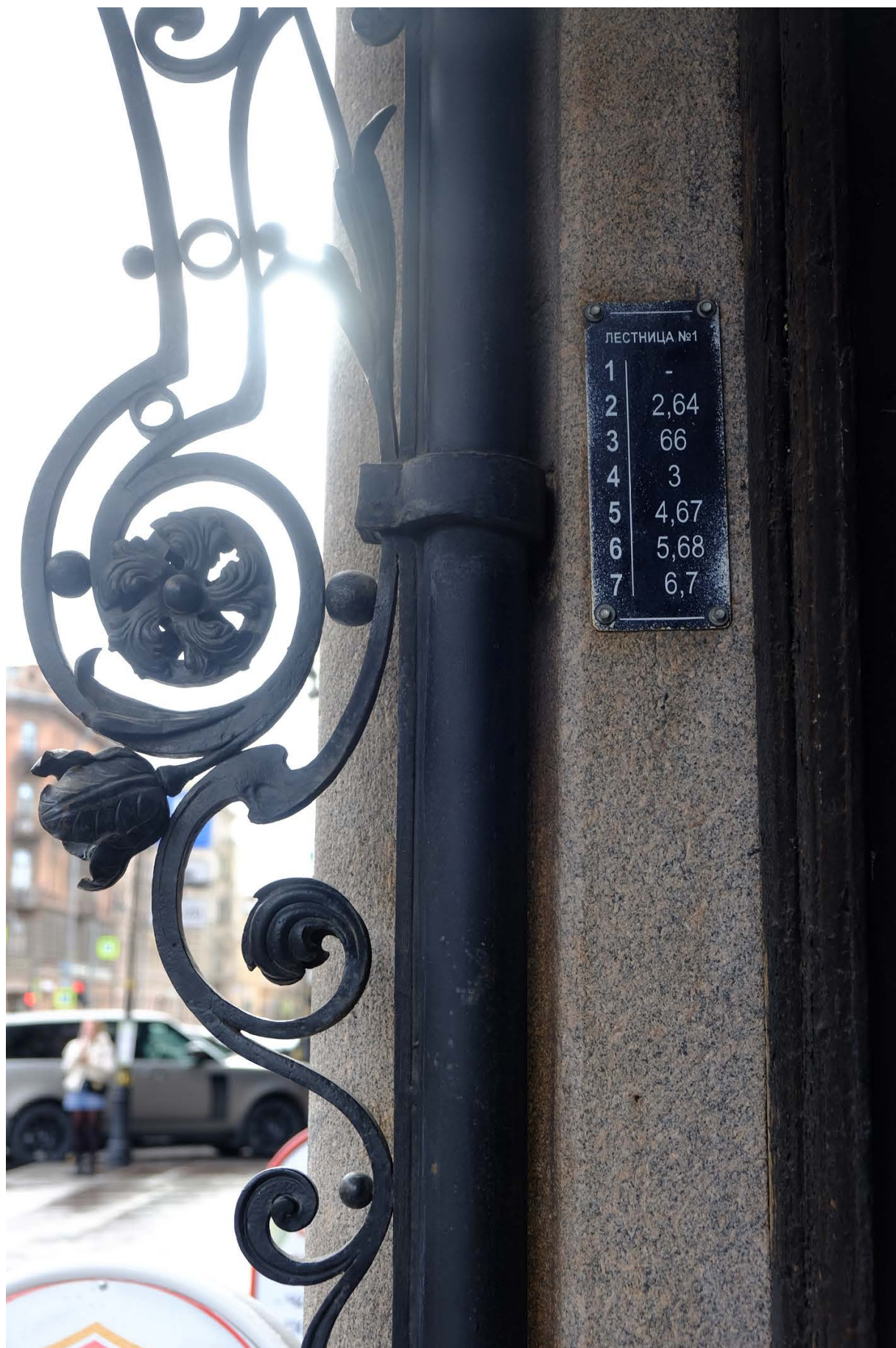
4. Кирочная улица, дом 24, литера А. «Дом Ю.Бака». Лицевой фасад. Откос и фрагмент кронштейна дверного проема парадной № 1.
