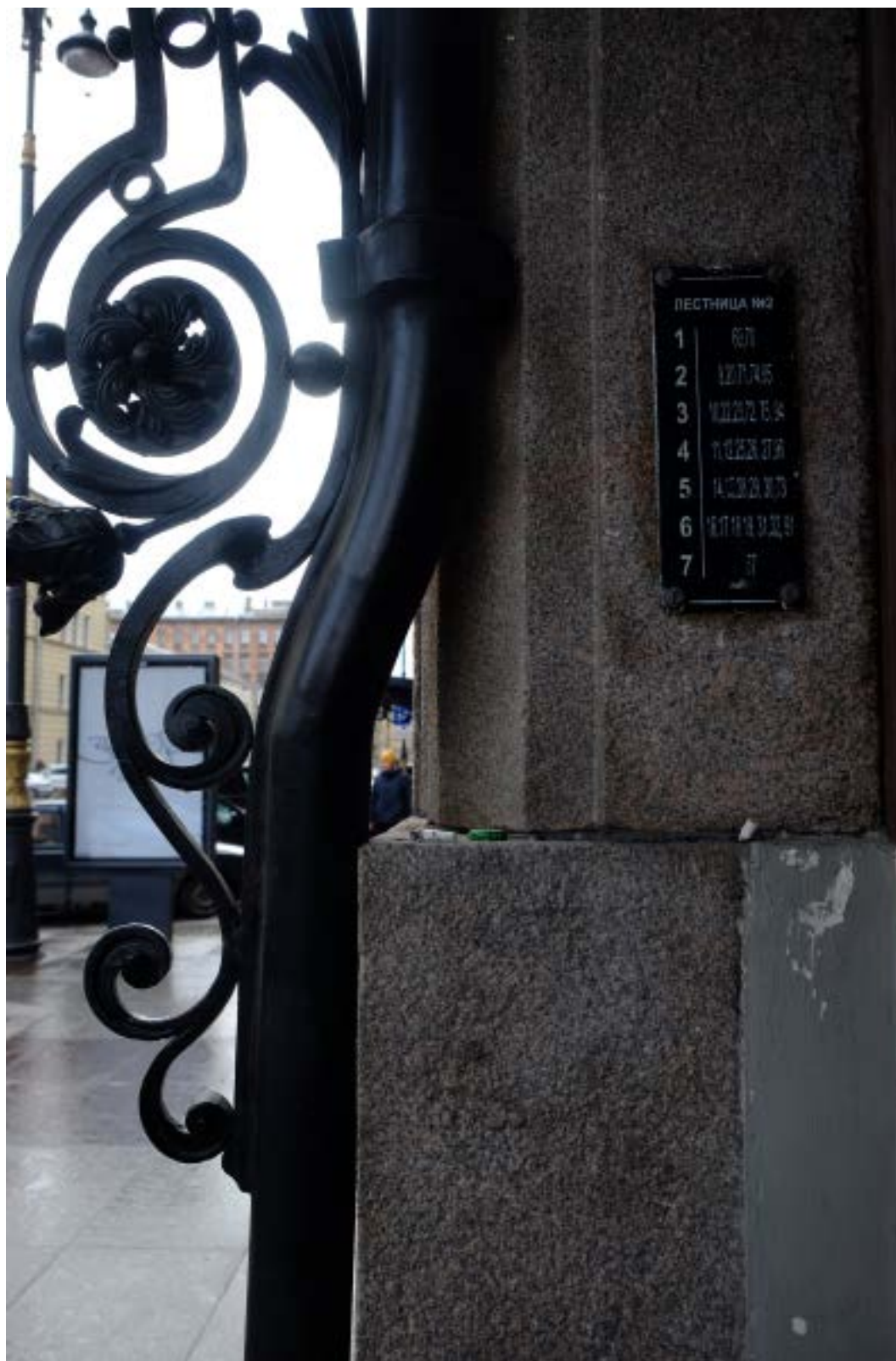
31. Кирочная улица, дом 24, литера А. «Дом Ю.Бака». Парадная лестница № 2. Откос с фрагментом кронштейна.
