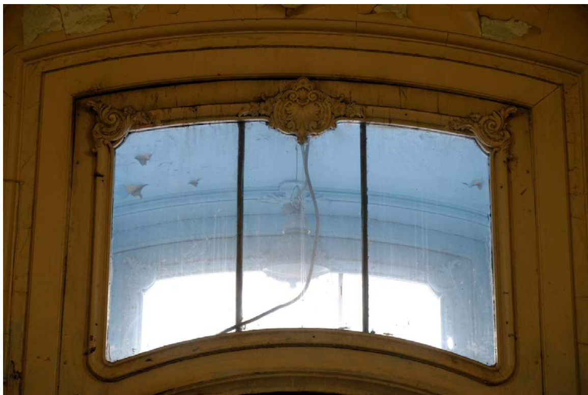
17. Кирочная улица, дом 24, литера А. «Дом Ю.Бака». Тамбур парадной лестницы № 1. Фрамуга со стороны лестницы.
