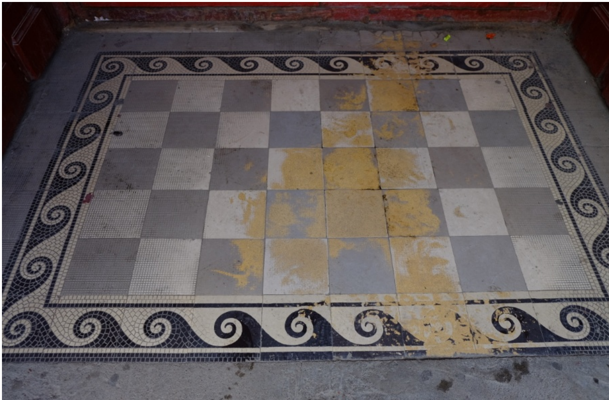
42. Кирочная улица, дом 24, литера А. «Дом Ю.Бака». Парадная лестница № 2. Тамбур. Напольная плитка.
