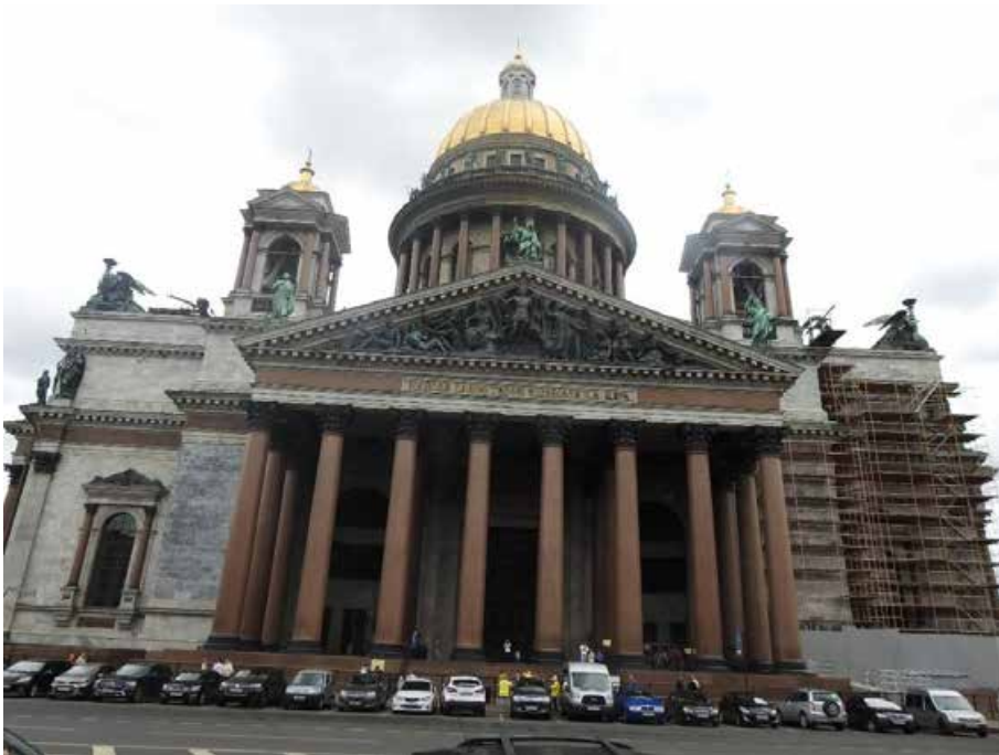
1. «Собор, 1818-1858 гг., инж. Бетанкур А., ск. Витали И.П., ск. Герман И, ск. Клодт П.К., ск. Лемер А., ск. Логановский А.В., арх. Монферран О, ск. Пименов Н.С., 1947-1951 г.г., 1954-1963 г.г. (реставрация), арх. Ротач А.Л.», Исаакиевская площадь, дом 4, литера А. Северный фасад. Общий вид. Фото 16.07.2021г.
