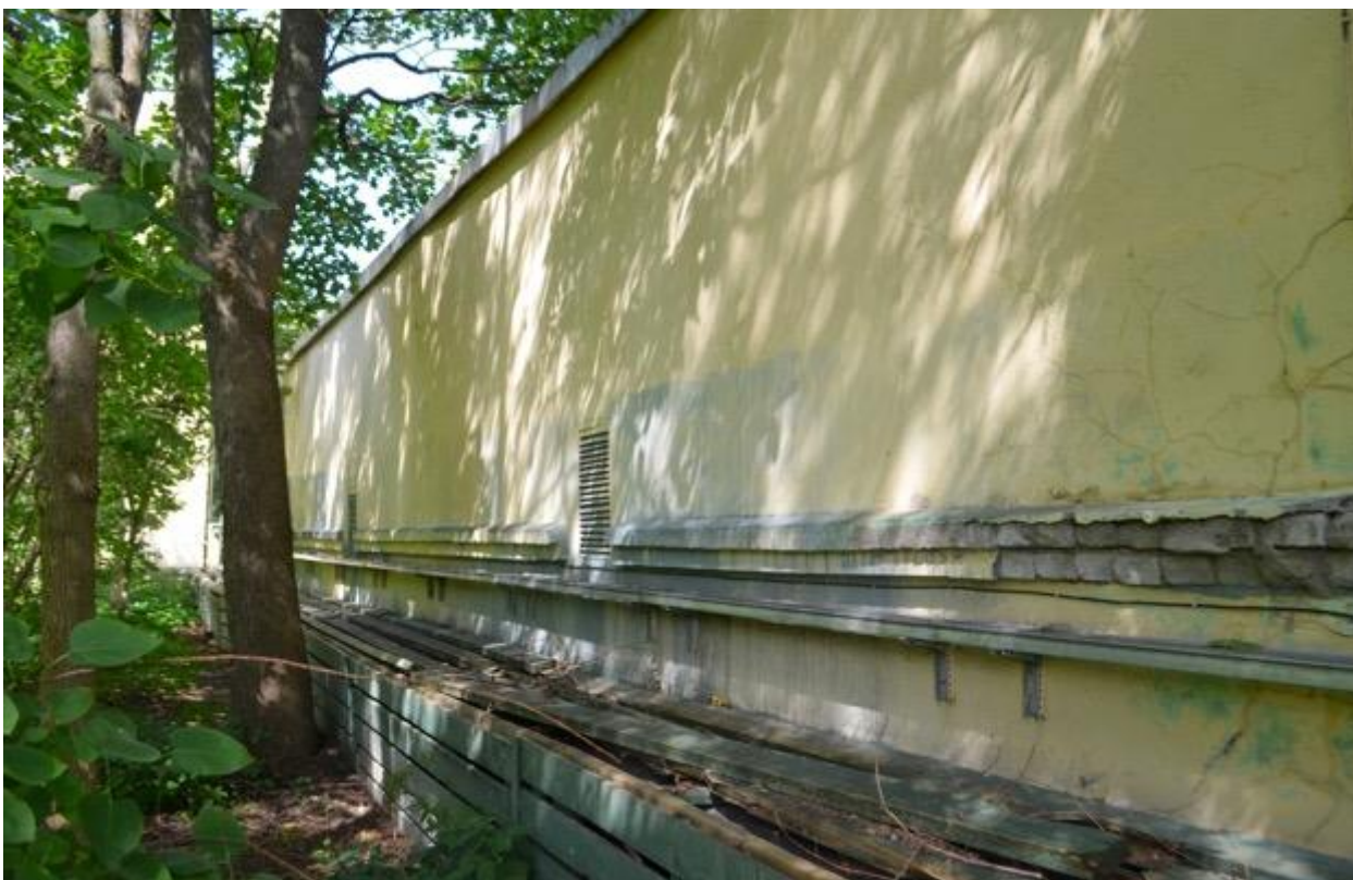
Фото 32. Особняк Кочубея В.П. (Пушкин, ул. Радищева, 4). Участок теплотрассы, проходящий вдоль восточной границы владельческого участка. Съёмка 15.07.2020 г.
