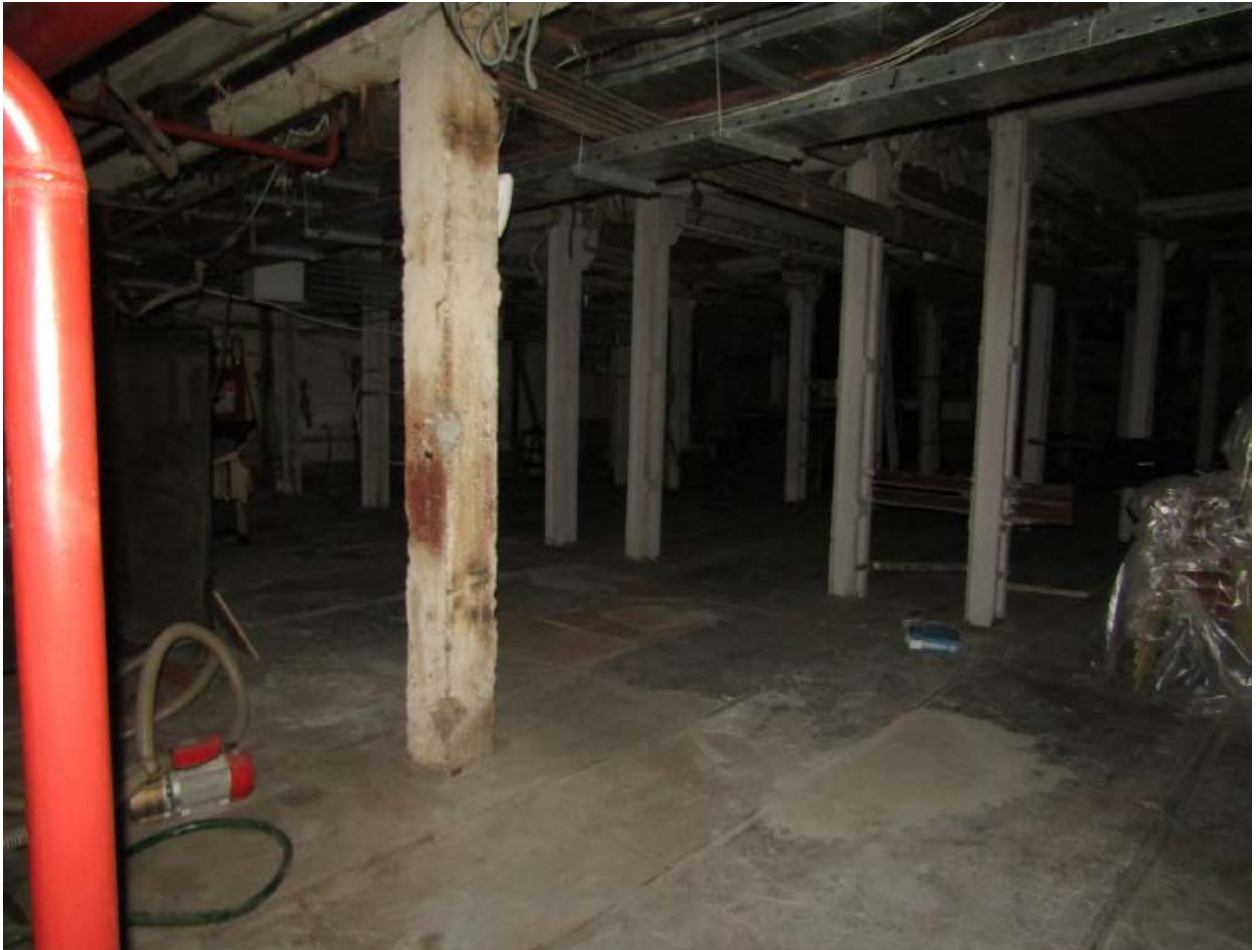
12. Полы подвала объекта культурного наследия федерального значения «Театр Михайловский 1831-1833 гг., арх. Росси К.И., арх. Брюллов А.П.», расположенного по адресу: г. Санкт-Петербург, пл. Искусств, д. 1, литера А. 15.09.2020
