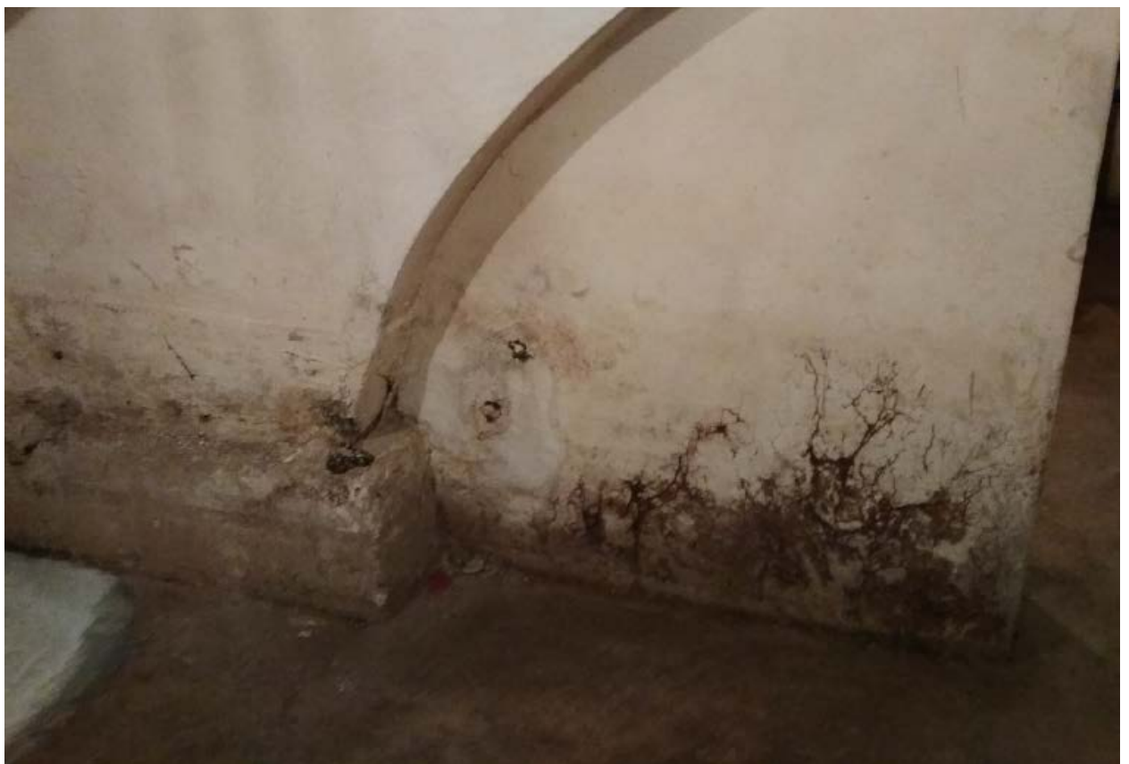
21. Стена и полы подвала здания объекта культурного наследия федерального значения «Дом Голенищева - Кутузова П.В., 1820-е гг., 1830-е гг. (фасады), арх. Росси К.И. Здесь в 1924 - 1939 гг. жил художник Бродский И.И.», расположенного по адресу: г. Санкт-Петербург, пл. Искусств, д. 3, литера А. 15.09.2020
