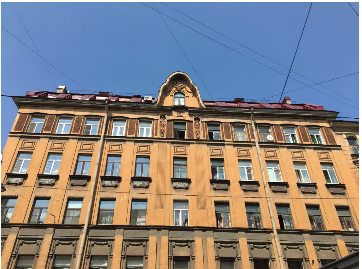
3. Лицевой фасад выявленного объекта культурного наследия «Дом Потаповой (Н.В. Иванова)», расположенного по адресу: г. Санкт-Петербург, Некрасова ул., д. 36. Общий вид. 26.04.2021
