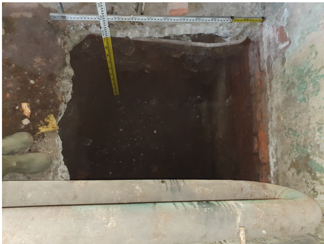
Рис. 19. Мойка, 60-2021. Шурф 1, фиксация по уровню окончания работ, вид на вид на северо-восток.
