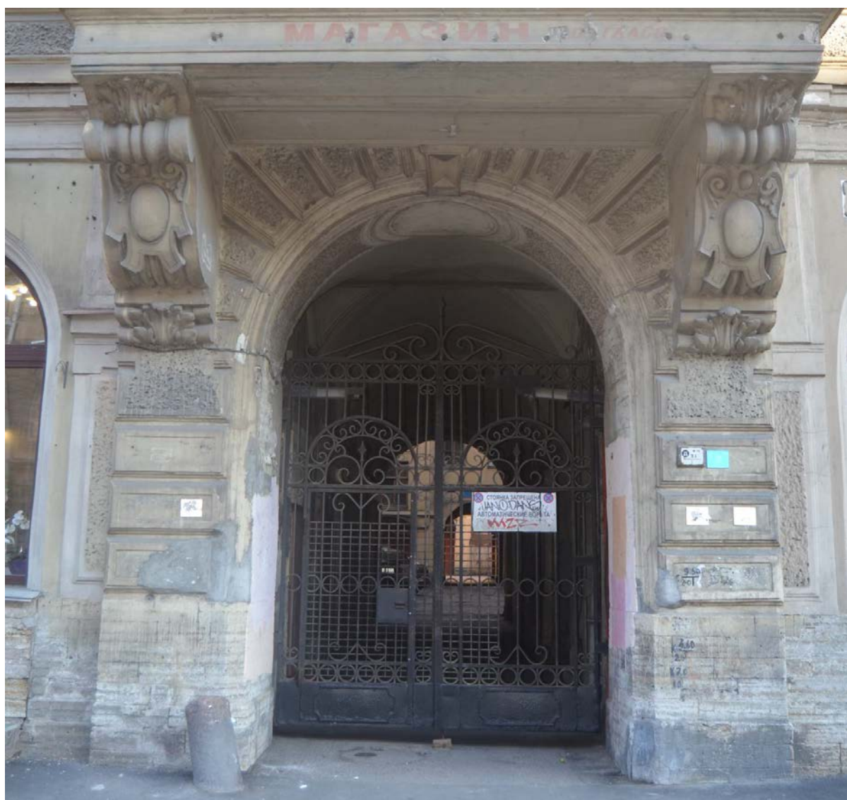
6. Выявленный объект культурного наследия «Дом Сироткиных». Оформление основания эркера и воротного проезда по лицевому фасаду. Вид с северо-запада. Съемка 26.04.2021
