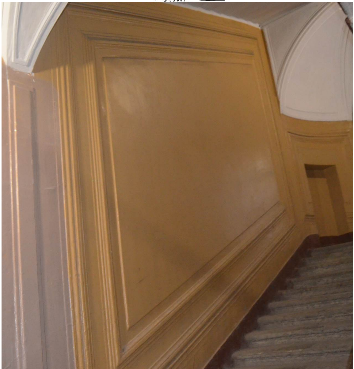
27. Выявленный объект культурного наследия «Дом Сироткиных». Парадная лестница (Л1). Оформление стен объема лестничной клетки. Вид с запада. Съемка 26.04.2021
