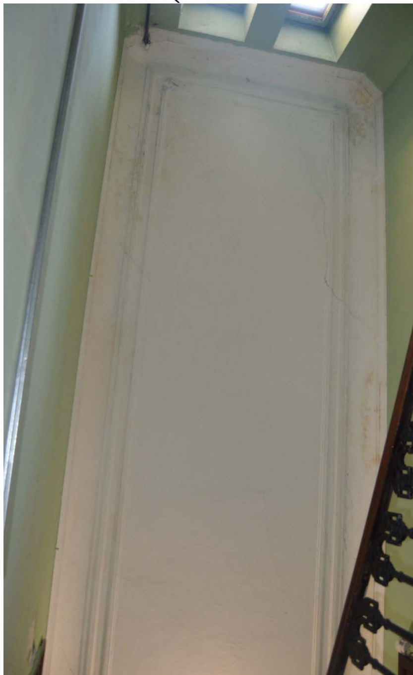
47. Выявленный объект культурного наследия «Дом Сироткиных». Лестница юго-восточного дворового флигеля (Л3). Оформление толка лестничной клетки. Вид с востока. Съемка 26.04.2021.
