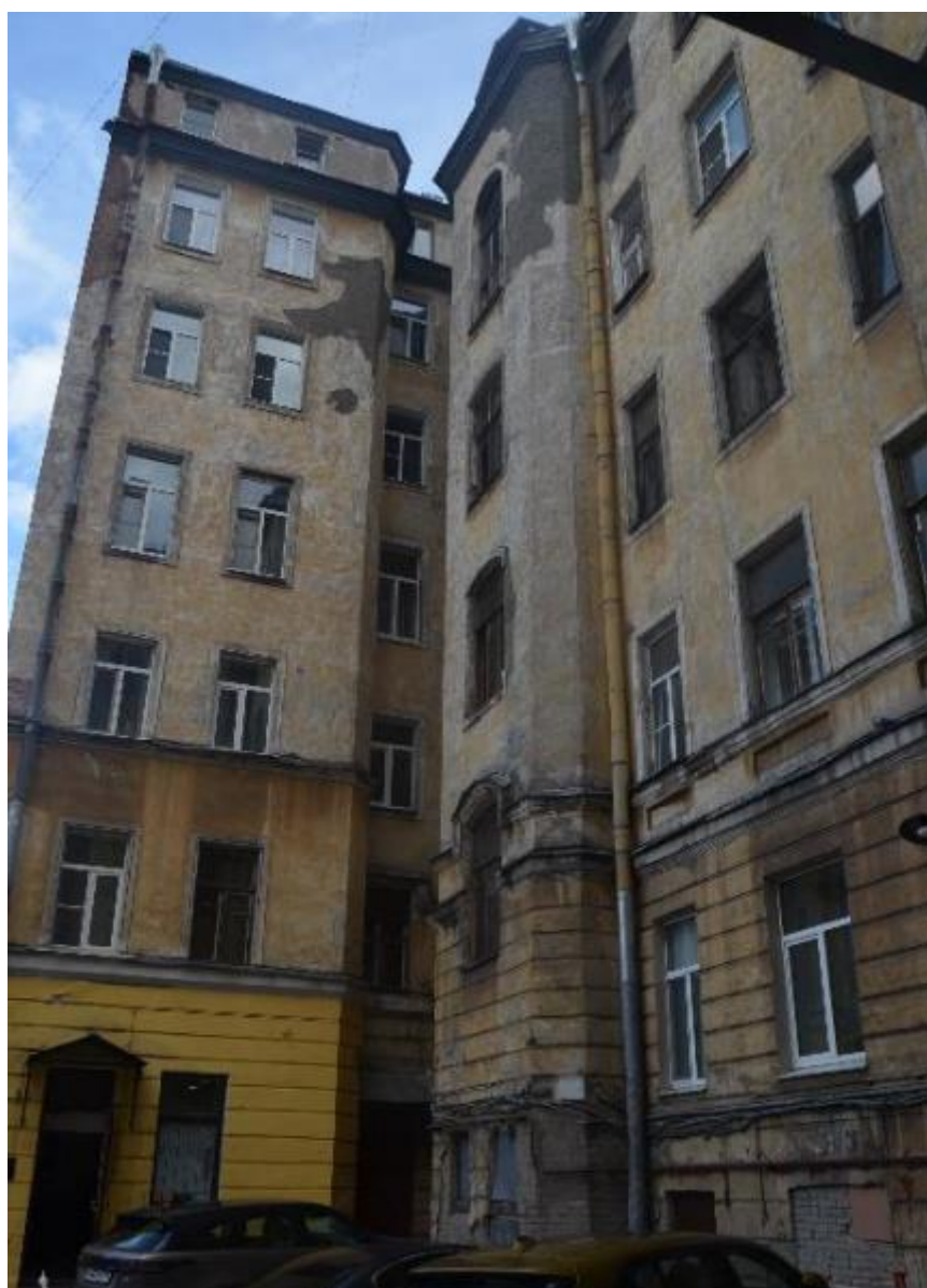
30. Выявленный объект культурного наследия «Дом П. Ф. Дыренкова». Южный и западный дворовые фасады. Вид с запада. Съемка 26.04.2021.
