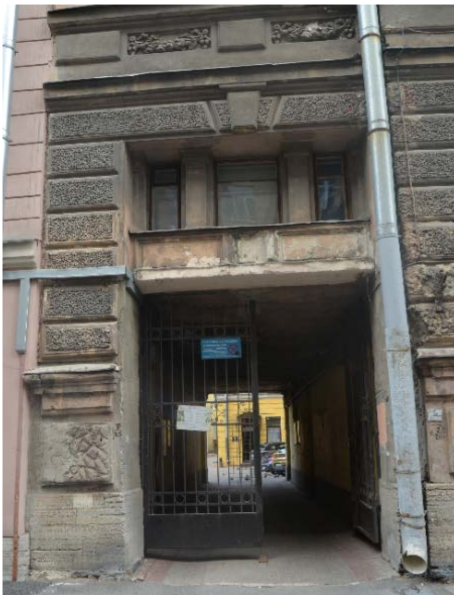
12. Выявленный объект культурного «Дом П. Ф. Дыренкова». Оформление воротного проезда по крайней западной оси южного лицевого фасада. Вид с юго-запада. Съемка 26.04.2021.
