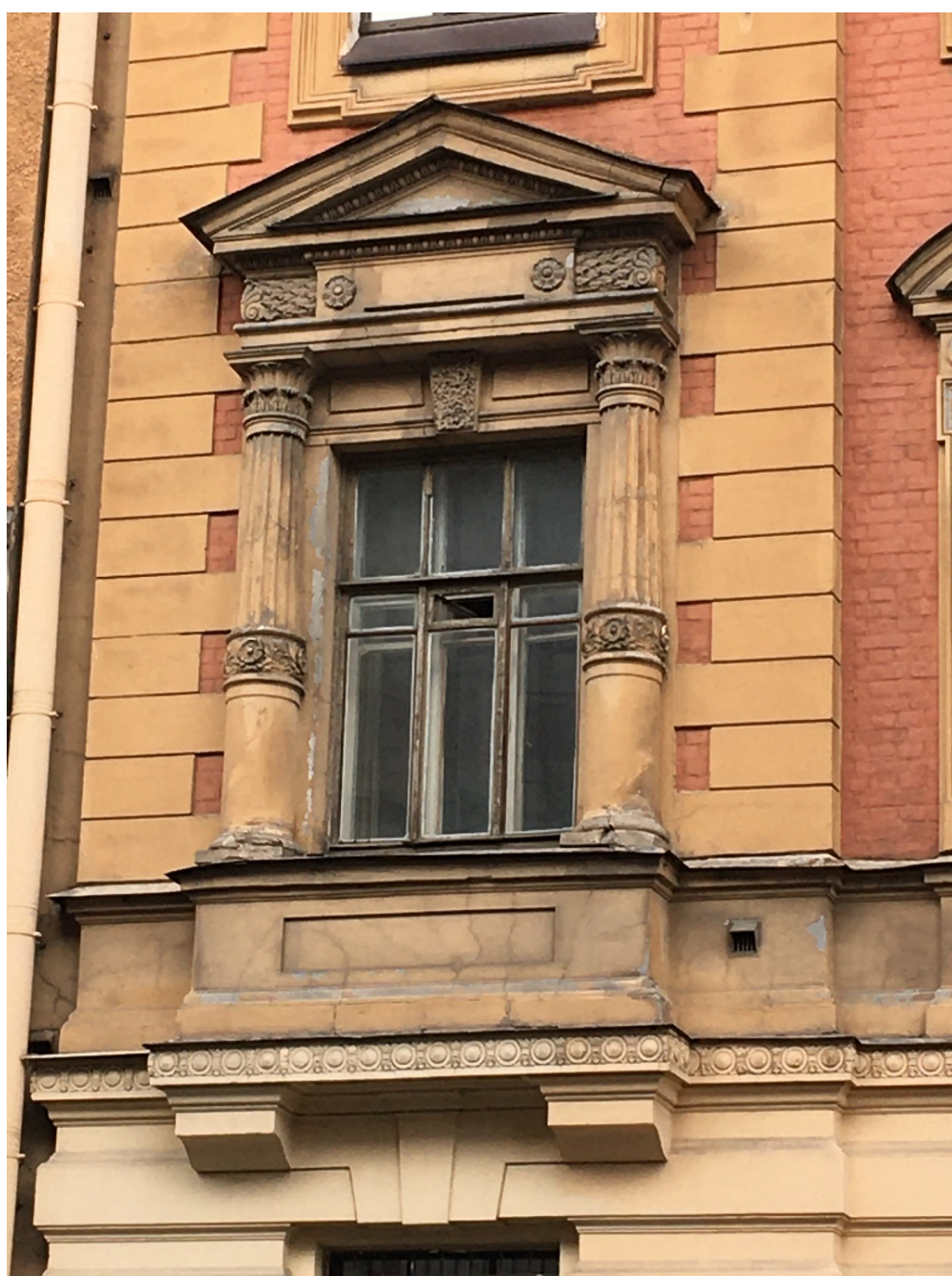
5. Лицевой фасад выявленного объекта культурного наследия «Дом А.И. Резанова», расположенного по адресу: г. Санкт-Петербург, Моховая ул., д. 28. Фрагмент.
