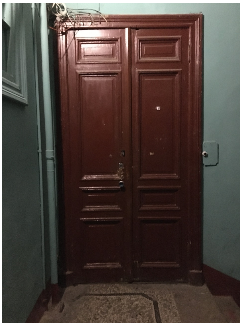
34. Парадная лестница 1ЛК. Площадка второго этажа. Дверное заполнение кв. 4.
