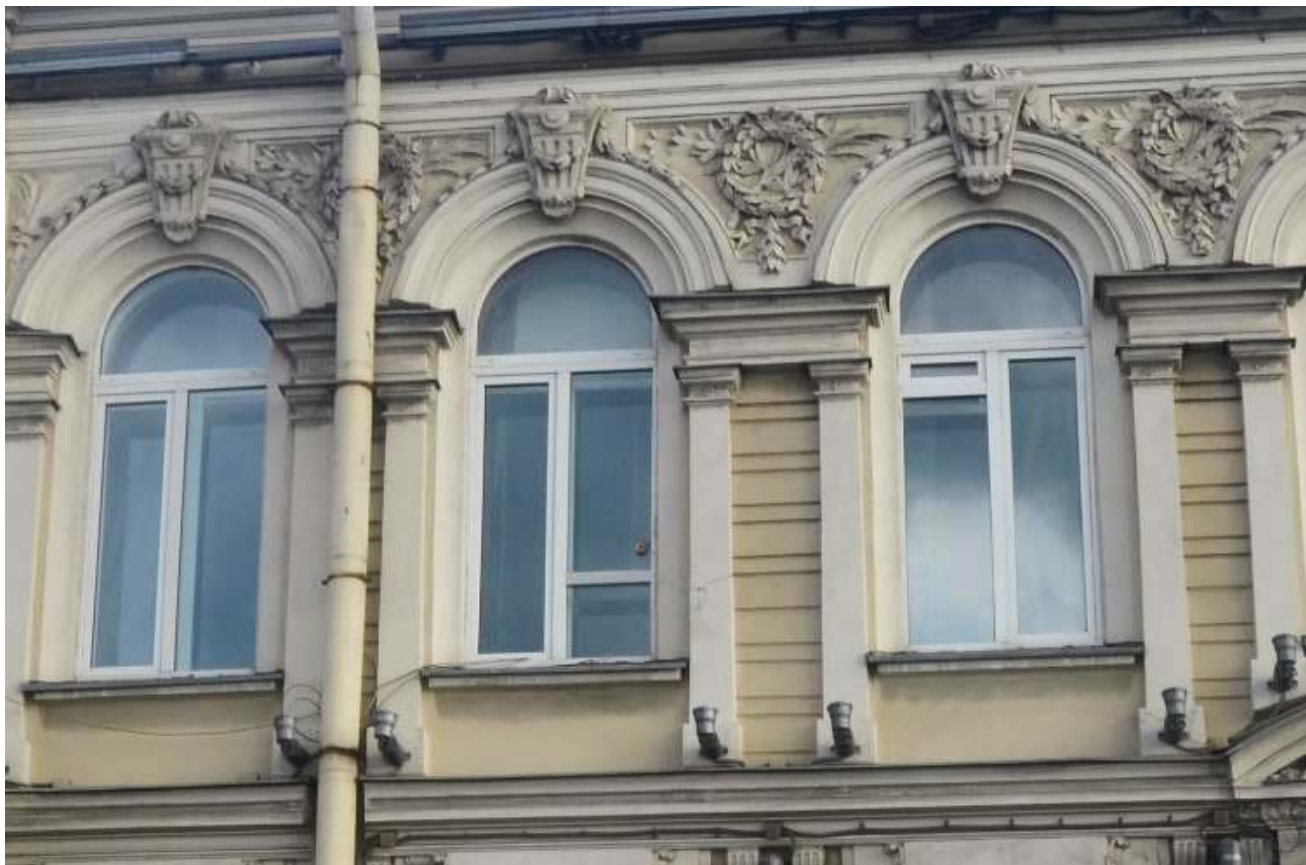
7. Выявленный объект культурного наследия «Особняк Е.А. Александровской (здание нефтепромышленного торгового общества "Мазут")». Оформление оконных проемов лицевого фасада в уровне третьего этажа. Вид с севера. Съемка 26.04.2021
