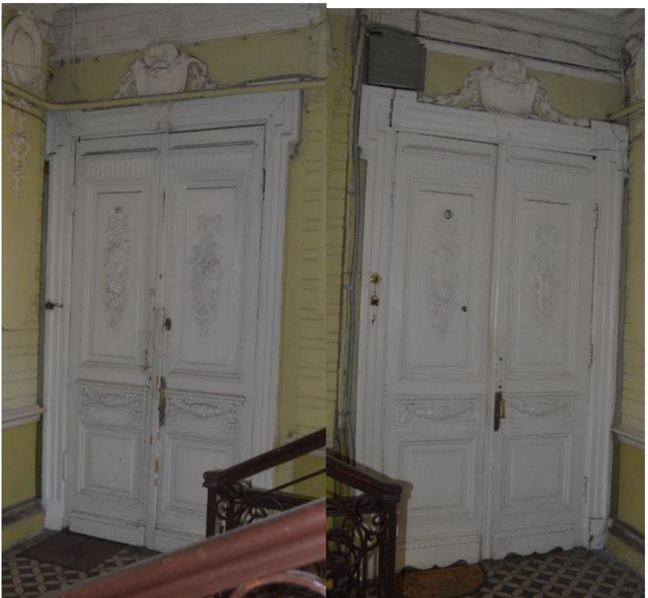
31. Выявленный объект культурного наследия «Особняк Е.А. Александровской (здание нефтепромышленного торгового общества "Мазут")». Парадная лестница (Л 2). Исторические дверные заполнения и оформление дверных проемов в уровне второго этажа. Вид с запада и востока. Съемка 26.04.2021
