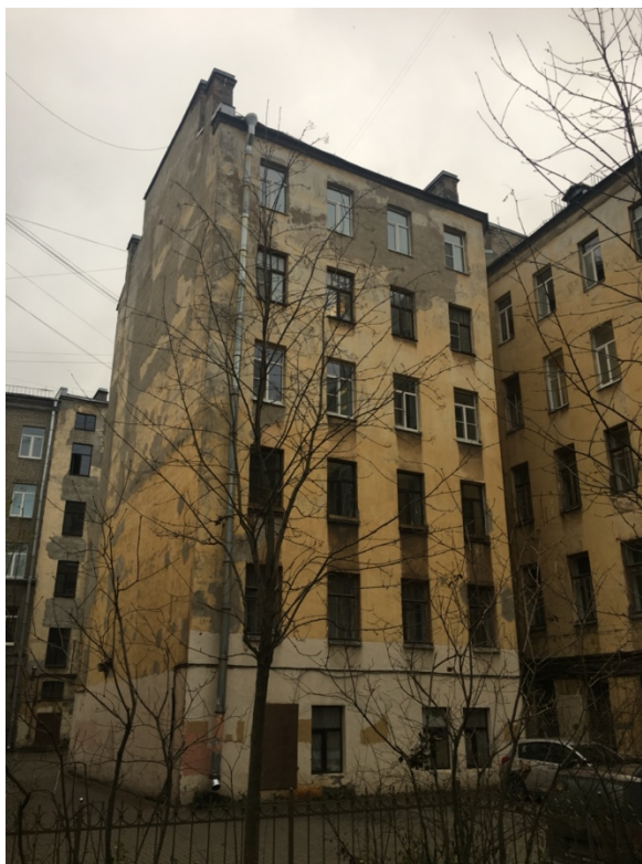
10. Выявленный объект культурного наследия «Дом Санкт-Петербургского мещанского общества», расположенный по адресу: г. Санкт-Петербург, Центральный район, Загородный пр-т, д. 31 (Бородинская ул., д. 12). Вид дворового фасада. Направление съемки юго-восток. Фото 10.11.2020
