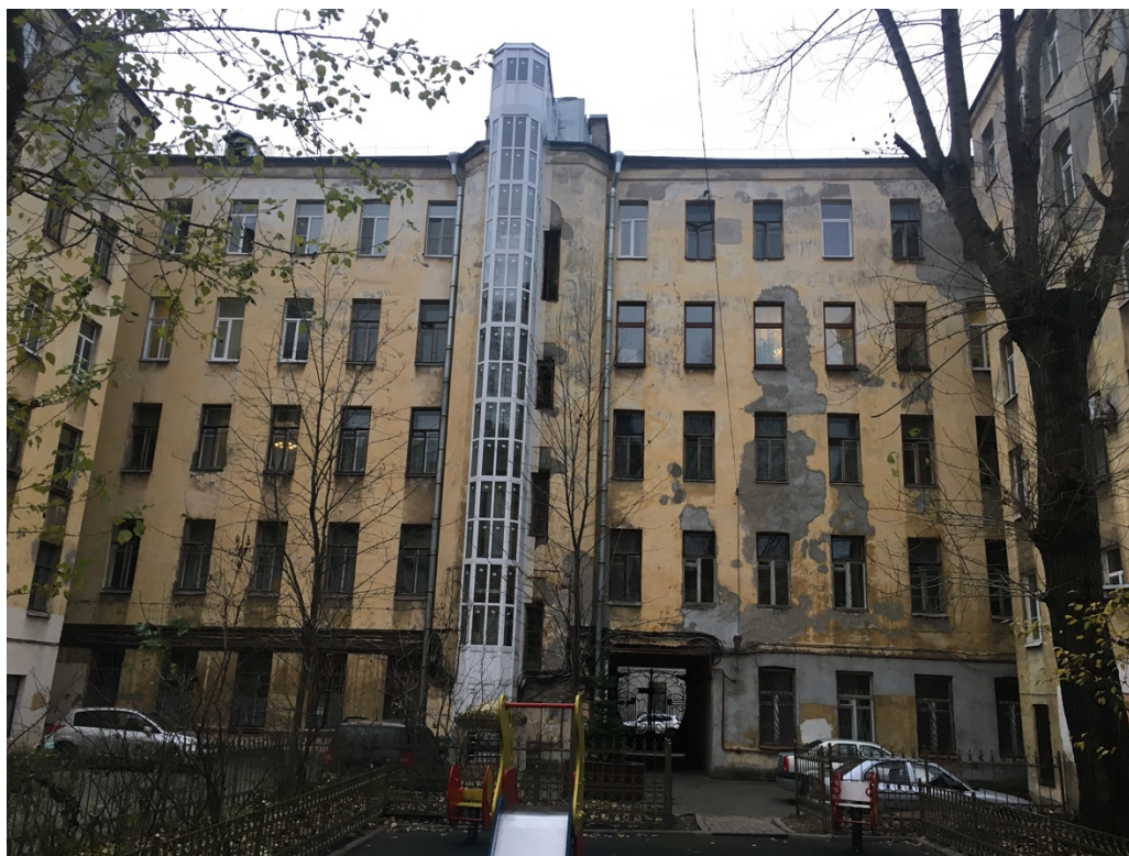
11. Выявленный объект культурного наследия «Дом Санкт-Петербургского мещанского общества», расположенный по адресу: г. Санкт-Петербург, Центральный район, Загородный пр-т, д. 31 (Бородинская ул., д. 12). Вид дворового фасада. Направление съемки юго-запад. Фото 10.11.2020
