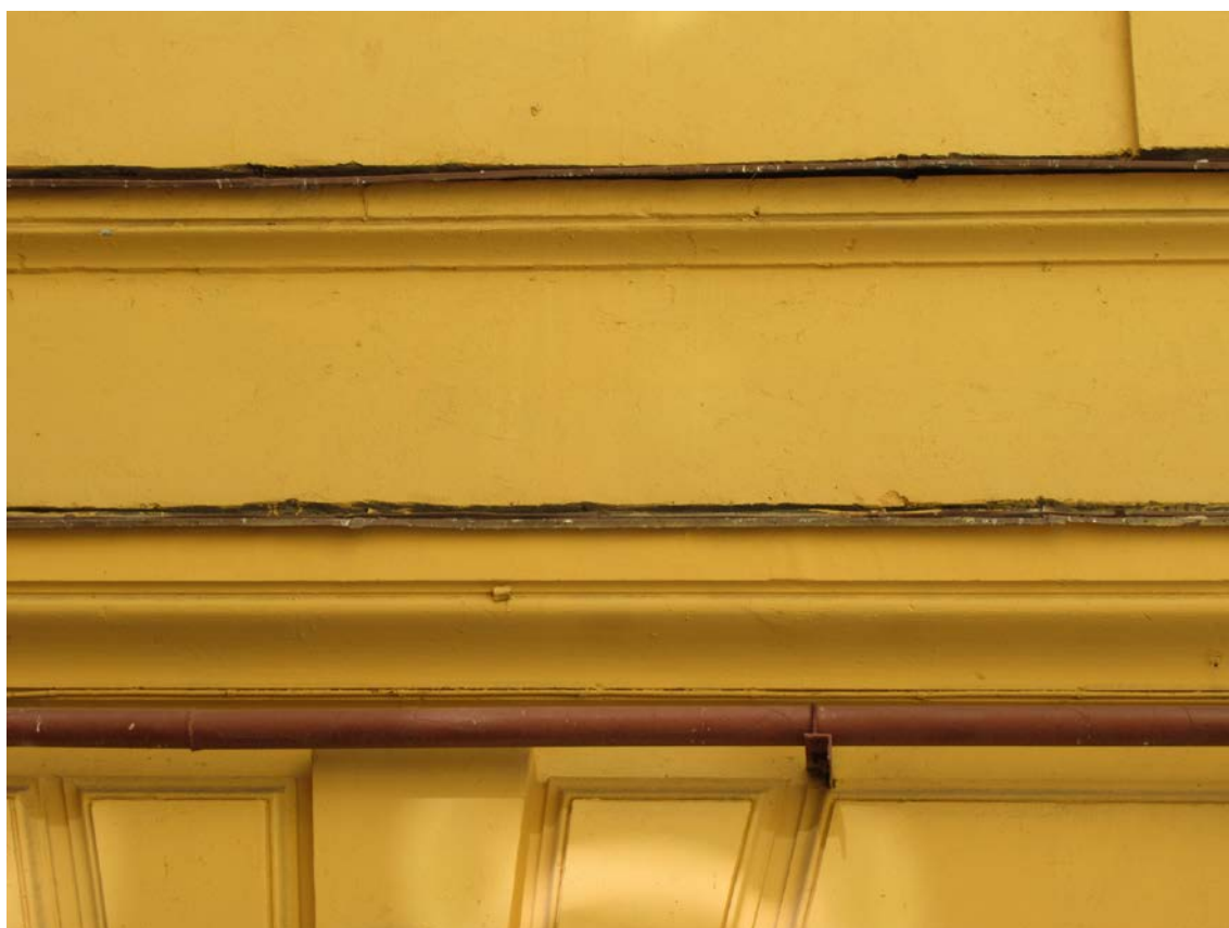
19. 12-я линия В.О., 25; Средний пр. В.О., 48, лит.Б. Флигель, входящий в состав ОКН «Дома В.Н. фон Дервиз». Фрагмент профилированной тяги между 1-м и 2-м этажами северо-восточного фасада.
