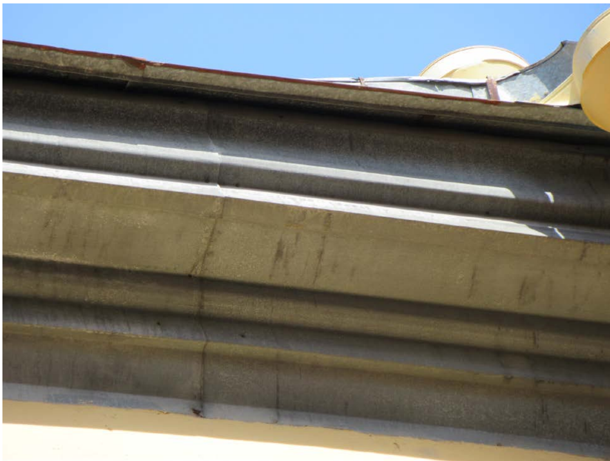
29. 12-я линия В.О., 25; Средний пр. В.О., 48, лит.Б. Флигель, входящий в состав ОКН «Дома В.Н. фон Дервиз». Профилированный венчающий карниз юго-западного фасада.
