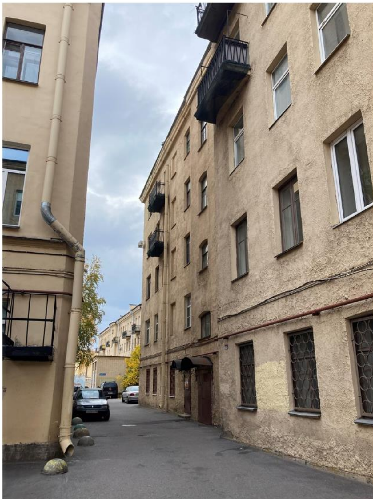
Фото 11. Вид со двора проход между восточным и южным фасадами. (Измайловский пр., 7; Троицкая пл. 6/№). Съемка: Богомаз К.М.
