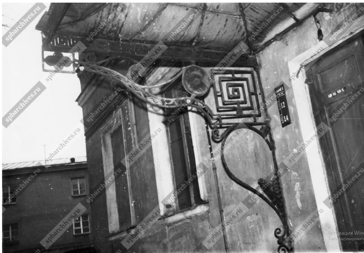
30. Вид кронштейна козырька парадного входа со стороны двора дома № 130 по набережной реки Фонтанки (бывший флигель особняка П.А. Поповой, архитектор [А.И. Мельников], 1822-1825 гг.). 9 ноября 1978 г. ЦГАКФФД СПб. Шифр: Ар 212775.
