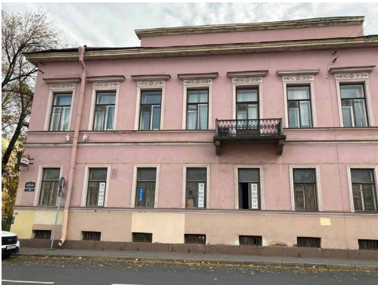
Фото 02. Вид на северный фасад лицевого корпуса с четной стороны наб. р. Фонтанки (Санкт-Петербург, набережная реки Фонтанки, дом 130). Съемка: Богомаз К.М.
