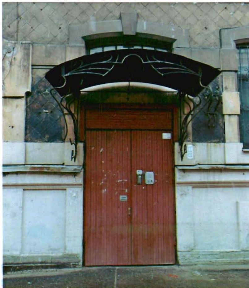
3. Фасад по переулку Макаренко 10. Козырек.
