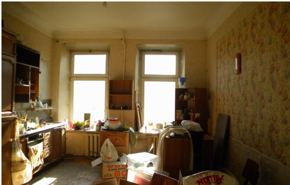
20. Объект культурного наследия «Дом Х.Г. Борхова» по адресу: г. Санкт-Петербург, Большой пр. В.О., д. 56, литера А. Квартира 34. Кухня. Общий вид.
