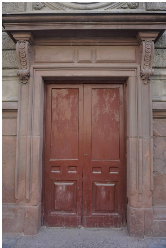
Фото 5. Фрагмент лицевого фасада объекта культурного наследия федерального значения «Банк для внешней торговли Русский с флигелями», оформление портала директорского подъезда
