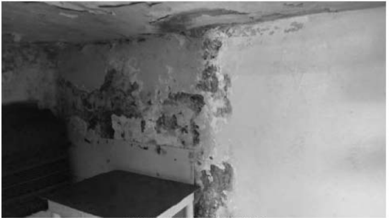
фото 14. Место протечки потолка. Блок 1.
