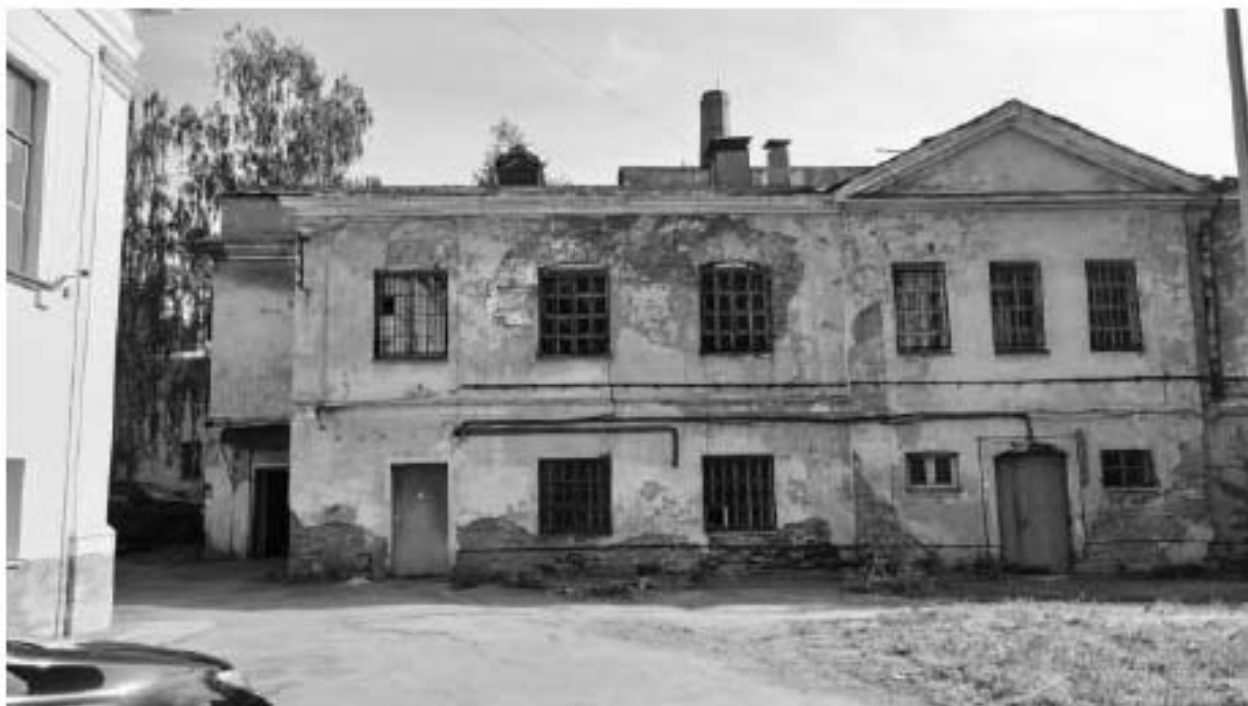
фото 1. Главный фасад здания, вид со стороны Московского переулка. Разрушение штукатурного слоя, выветривание раствора кирпичной кладки, разрушения отмостки.
