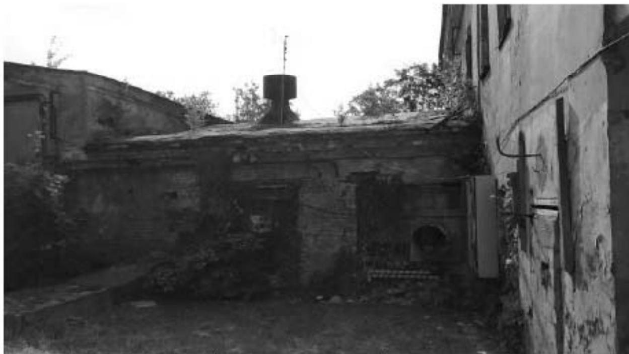
фото 6. Вид со стороны Госпитальной улицы (помещение насосной). Имеются разрушения штукатурного слоя и кирпичной кладки, выветривание раствора. Отсутствует отмостка здания.
