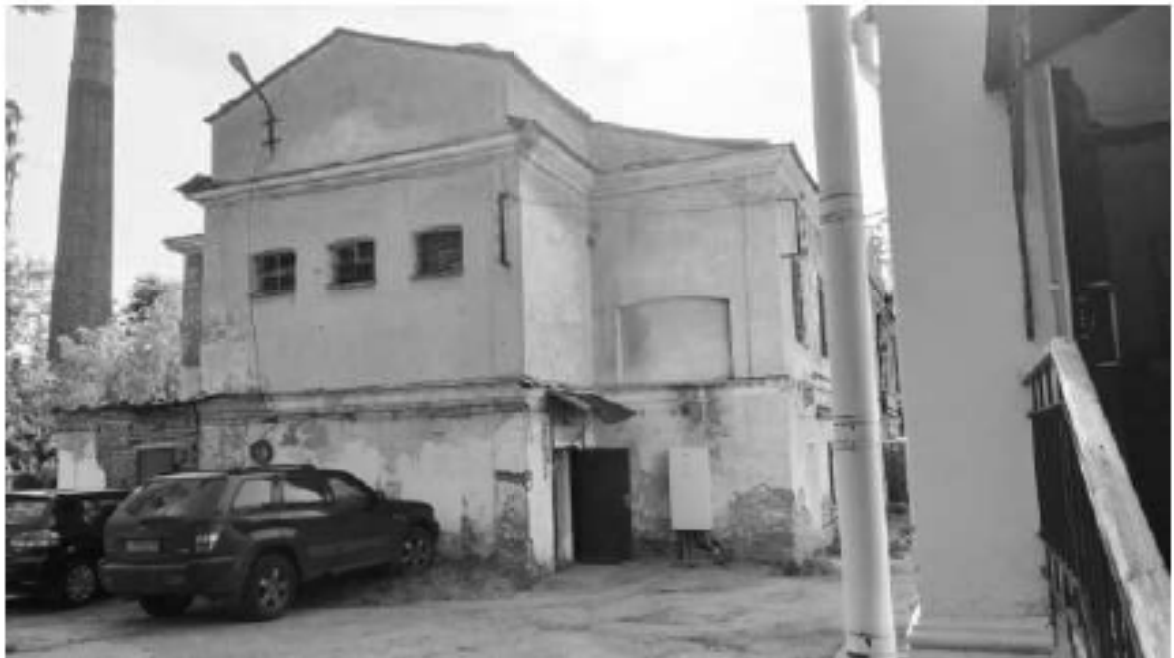
фото 4. Вид со стороны Госпитальной улицы. В средней части здания, на первом этаже заложены три оконных проема кирпичной кладкой. Имеются разрушения штукатурного слоя и кирпичной кладки, выветривание раствора. Отсутствует отмостка здания.
