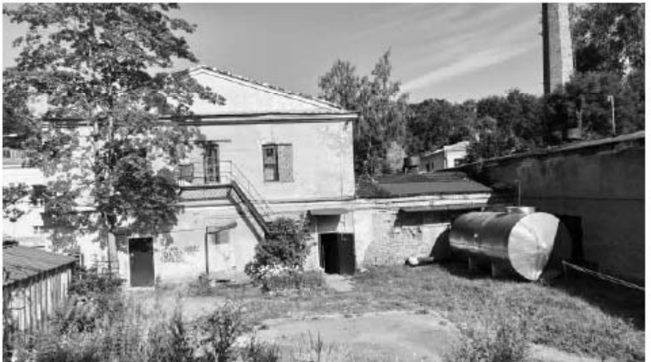
фото 12. Вид со стороны Софийского бульвара (помещение котельной). Имеются разрушения штукатурного слоя и кирпичной кладки, выветривание раствора. Отсутствует отмостка здания.
