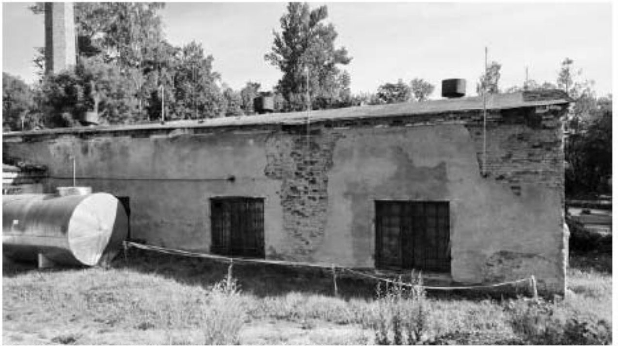
фото 11. Вид со стороны Московского переулка (помещение котельной). Имеются разрушения штукатурного слоя и кирпичной кладки, выветривание раствора. Отсутствует отмостка здания.
