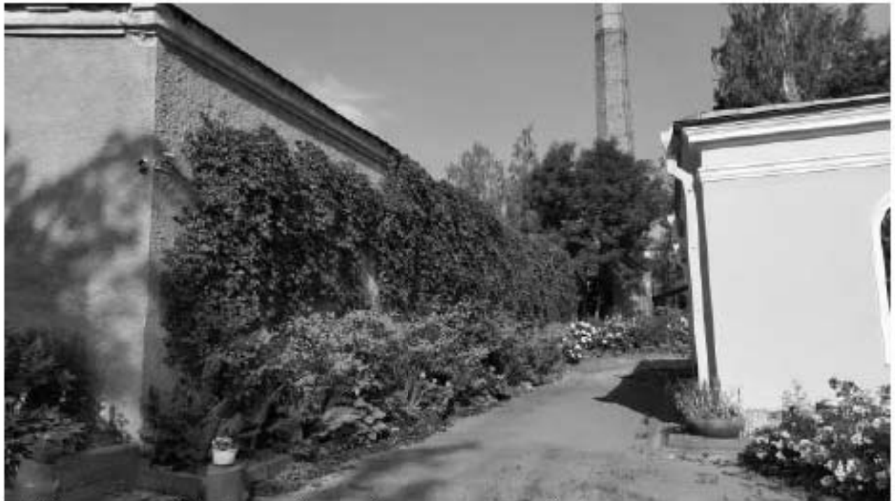
фото 9. Вид со стороны Октябрьского бульвара (помещение котельной). Имеются разрушения штукатурного слоя и кирпичной кладки, выветривание раствора. Отсутствует отмостка здания. Сильная поросль на месте отмостки.
