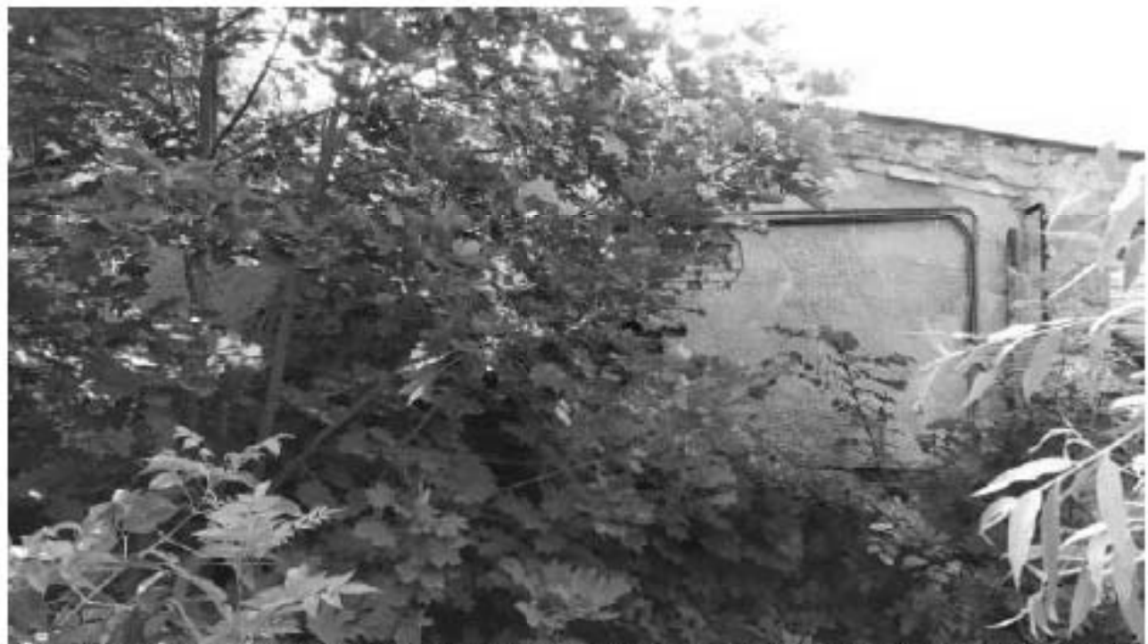
фото 8. Вид со стороны Госпитальной улицы (помещение котельной). Имеются разрушения штукатурного слоя и кирпичной кладки, выветривание раствора. Отсутствует отмостка здания. Сильная поросль на месте отмостки.
