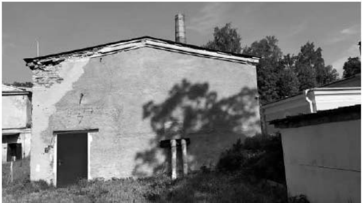
фото 10. Вид со стороны Софийского бульвара (помещение котельной). Имеются разрушения штукатурного слоя и кирпичной кладки, выветривание раствора. Отсутствует отмостка здания.
