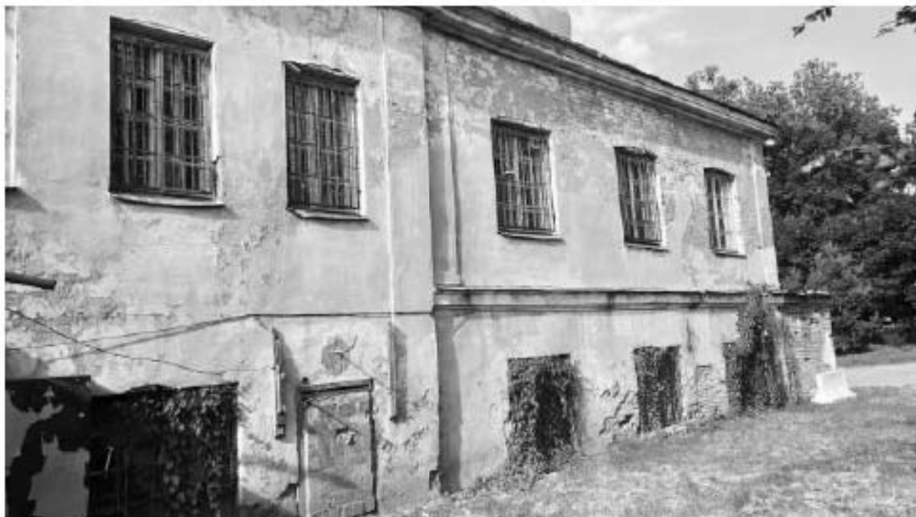
фото 5. Вид со стороны Октябрьского бульвара. В средней части здания заложен дверной проем кирпичной кладкой. Имеются разрушения штукатурного слоя и кирпичной кладки, выветривание раствора. Отсутствует отмостка здания.
