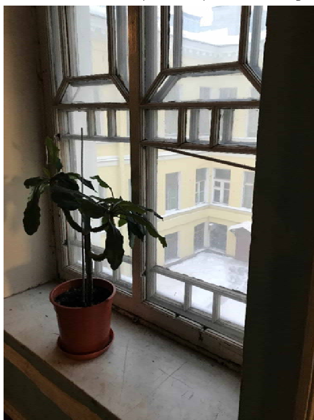
Фото 28. Оконное заполнение, 3 этаж, парадная лестница. Наблюдаются утраты фрагментов, сколы древесины по краю рам, трещины, расхождение узловых соединений.
