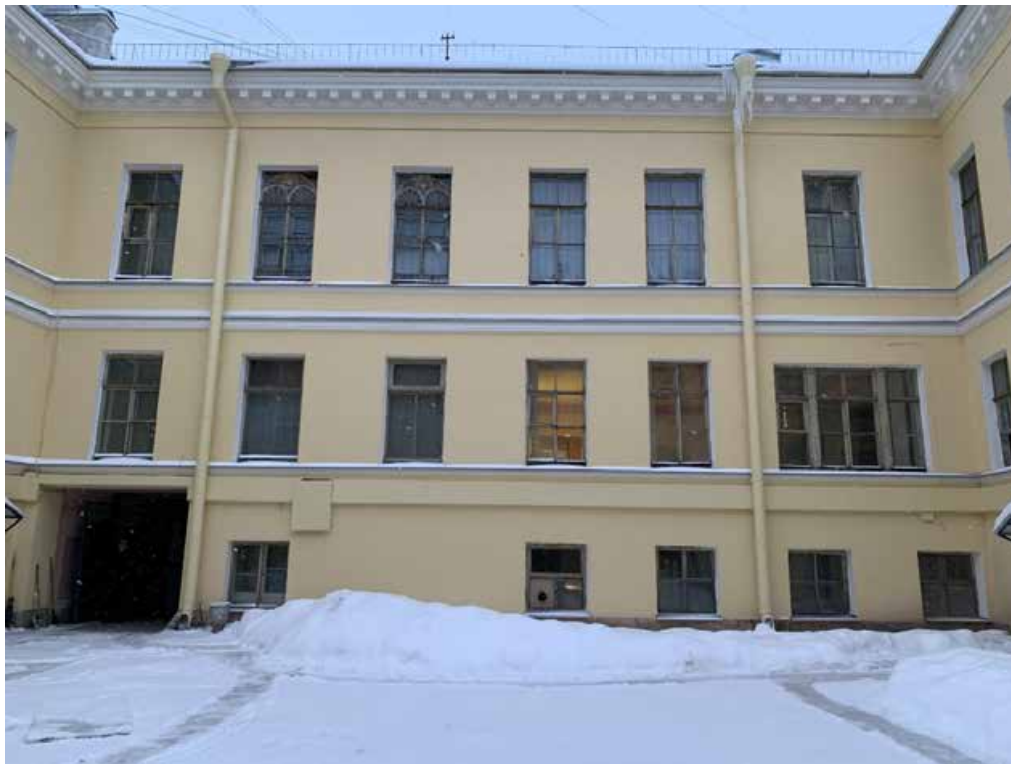
Фото 3. Дворовой фасад. Оконные заполнения за годы эксплуатации получили естественный физический износ, наблюдаются следы биоповреждений, деструкция древесины, поздние вставки и замены.
