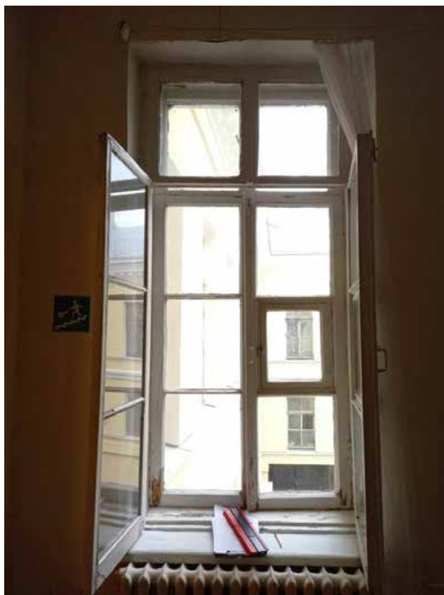
Фото 30. Оконное заполнение, 3 этаж, вид из помещения. Наблюдаются нарушения геометрии окна, перекос створок, следы биоповреждений, многочисленные следы поздней покраски, расхождение узловых соединений
