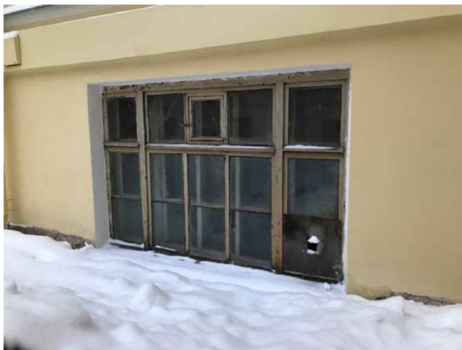
Фото 32. Дворовой фасад. Оконное заполнение с поздними вставками из оргалита и металла, наблюдаются следы биоповреждений, замачивание коробки
