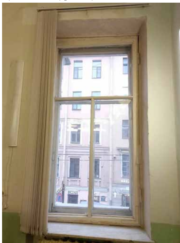
Фото 20. Оконное заполнение 3 этаж, лицевой фасад, вид из помещения. Наблюдаются нарушения геометрии окна, перекося створок, поздние вставки, многочисленные следы поздней покраски, подоконная доска (мрамор) имеет сколы.
