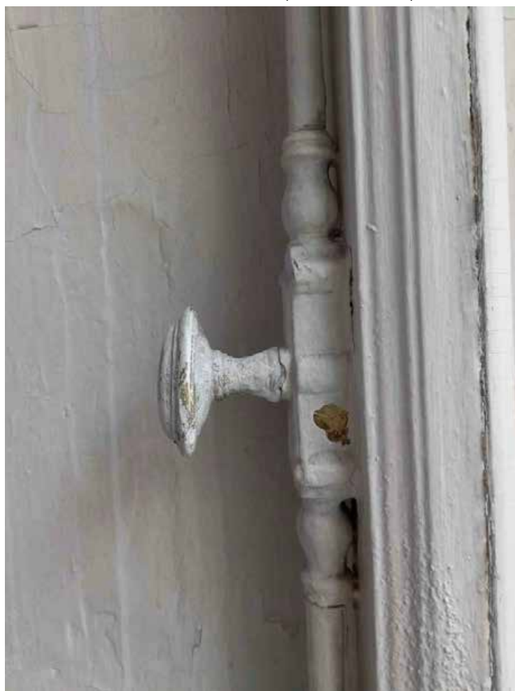
Фото 24. Фурнитура. Наблюдаются следы многочисленных покрасок, вмятины
