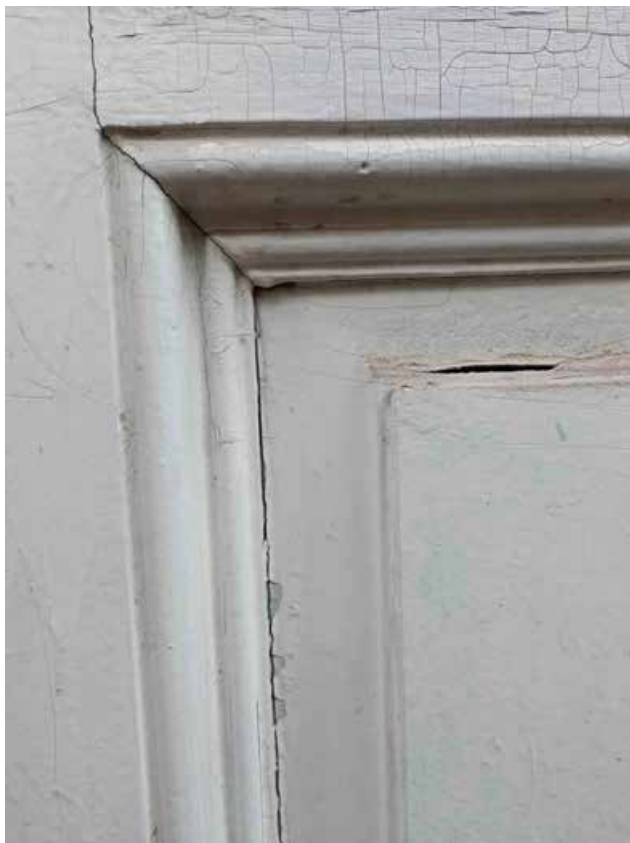
Фото 15. Балконная дверь (правая), вид из помещения. Наблюдается общий износ, трещины, разнообразная поздняя фурнитура, многочисленные следы (растрескивание) поздних покрасок
