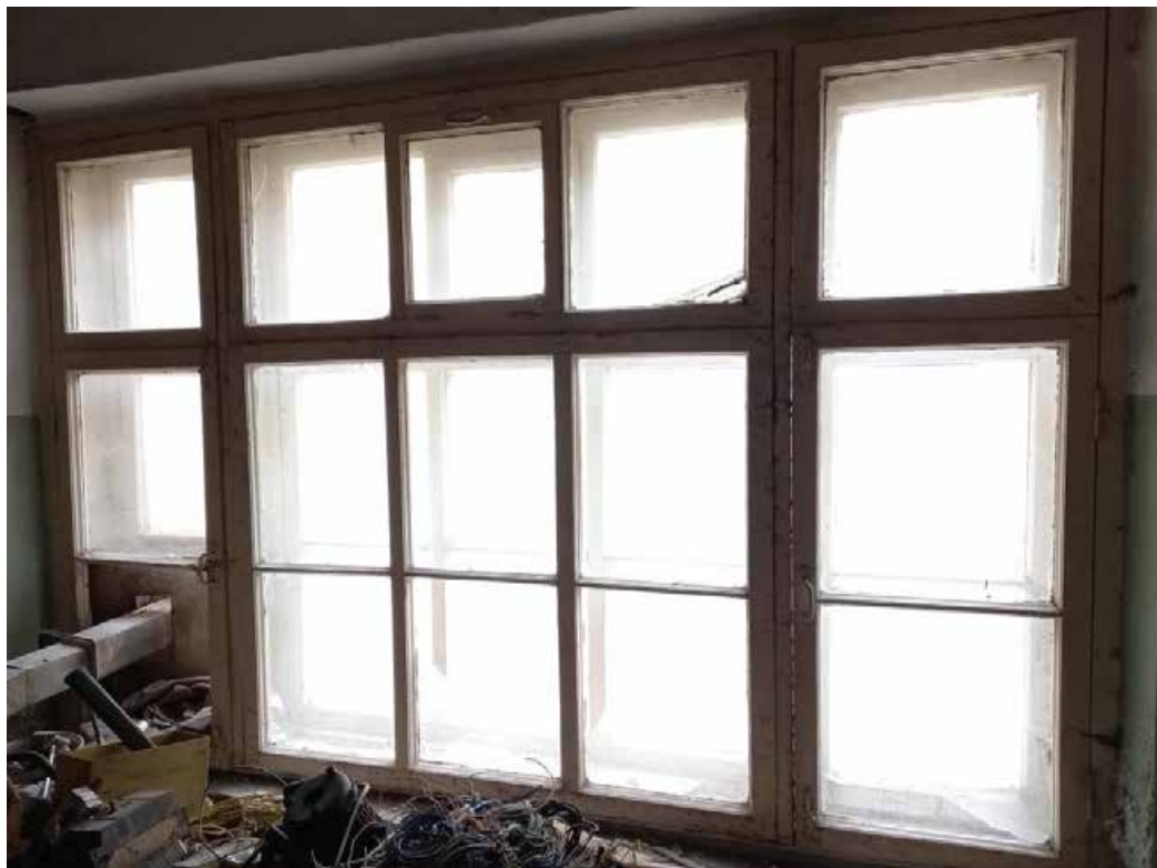
Фото 33. Оконное заполнение, 1 этаж, вид из помещения. Наблюдаются нарушения геометрии окна, утраты, поздние вставки, следы биоповреждений, многочисленные следы поздней покраски, расхождение узловых соединений, щели между элементами заполнения.
