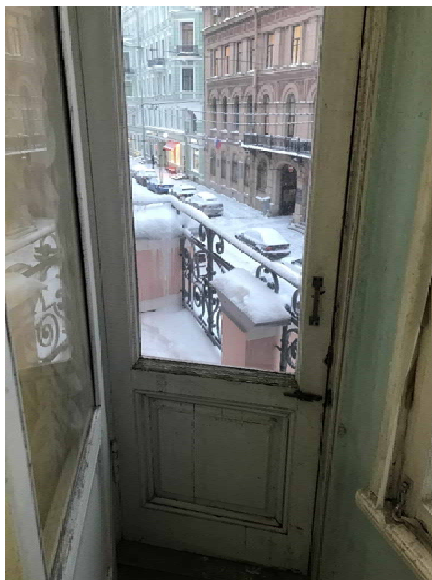
Фото 13. Балконная дверь (правая), вид из помещения. Наблюдается общий износ, трещины, разнообразная поздняя фурнитура, поздние вставки
