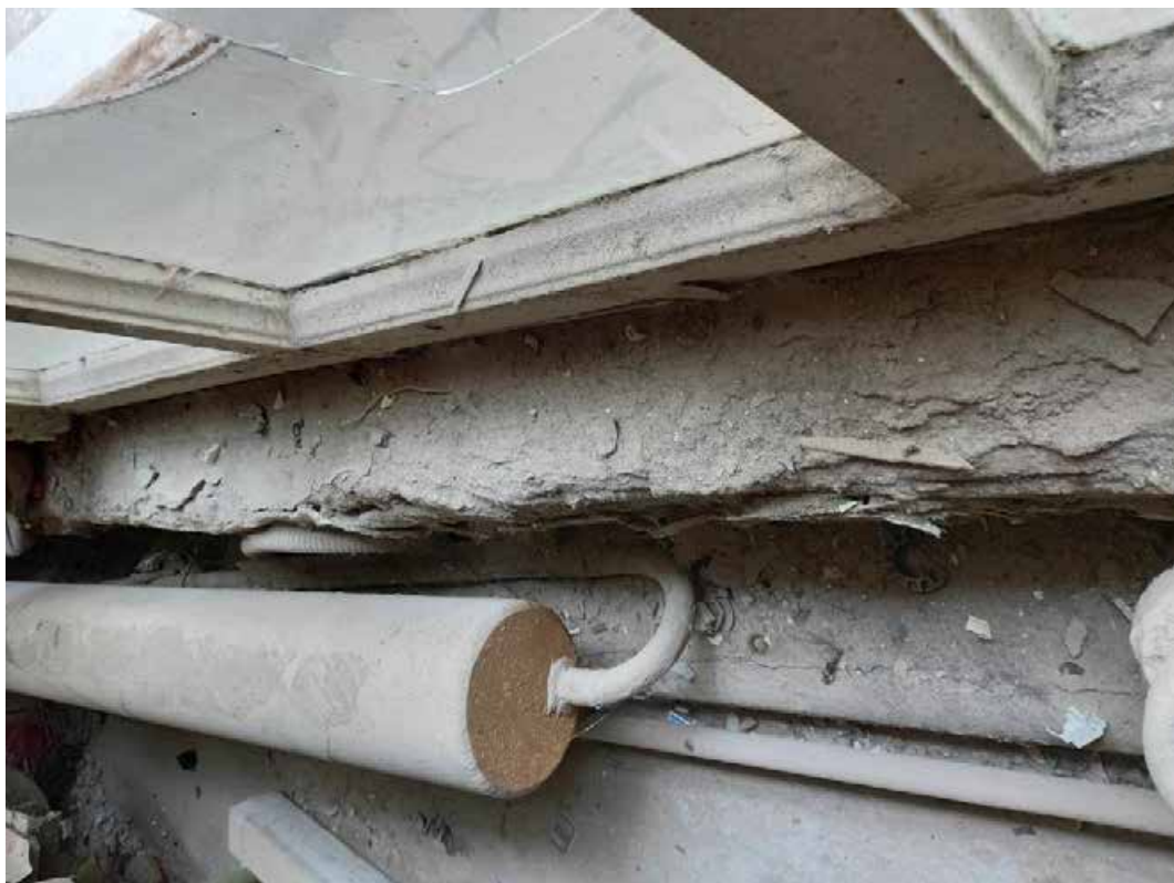
Фото 34. Оконное заполнение, 1 этаж, вид из помещения. Наблюдается разрушение подоконного пространства, отсутствие подоконной доски
