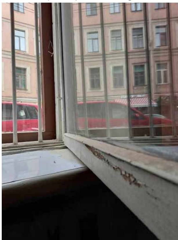
Фото 18. Оконное заполнение 1 этаж, лицевой фасад, вид из помещения. Наблюдаются нарушения красочного слоя, загрязнения, поздние вставки
