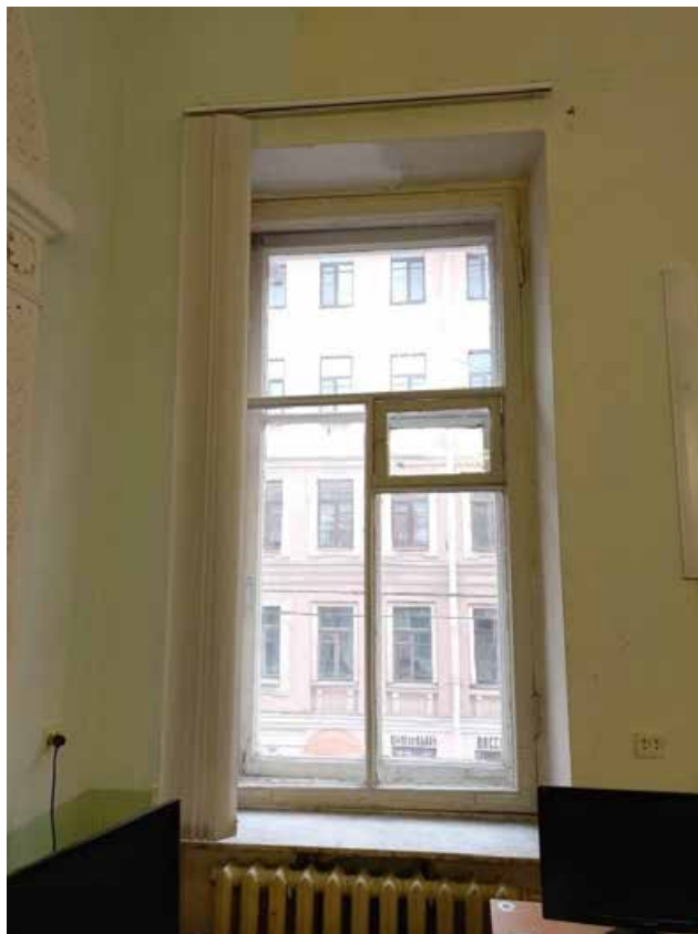
Фото 21. Оконное заполнение 3 этаж, лицевой фасад, вид из помещения. Наблюдаются нарушения геометрии окна, перекос створок, поздние вставки, многочисленные следы поздней покраски.
