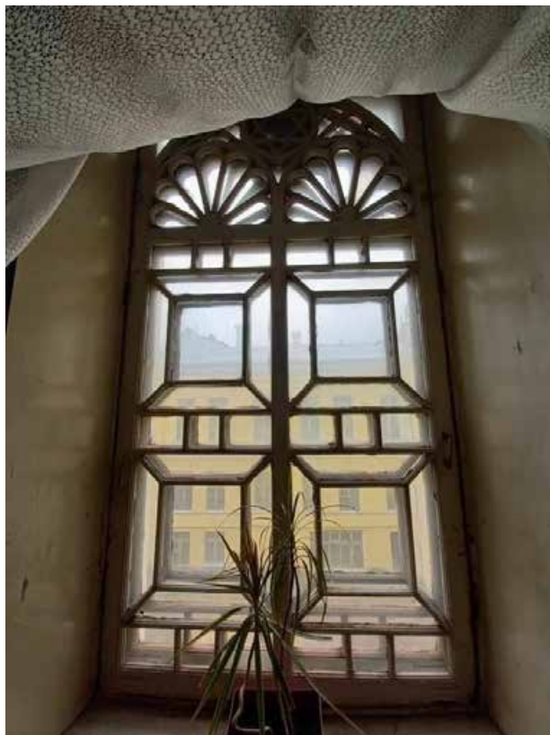
Фото 27. Оконное заполнение, 3 этаж, парадная лестница. Наблюдаются сколы древесины, следы биоповреждений, поздние вставки, трещины, расхождение узловых соединений.
