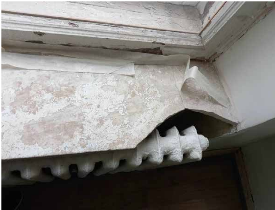
Фото 23. Подоконная доска (мрамор). Наблюдаются повреждения в виде сколов, трещин, царапин, а также позднее лакокрасочное покрытие
