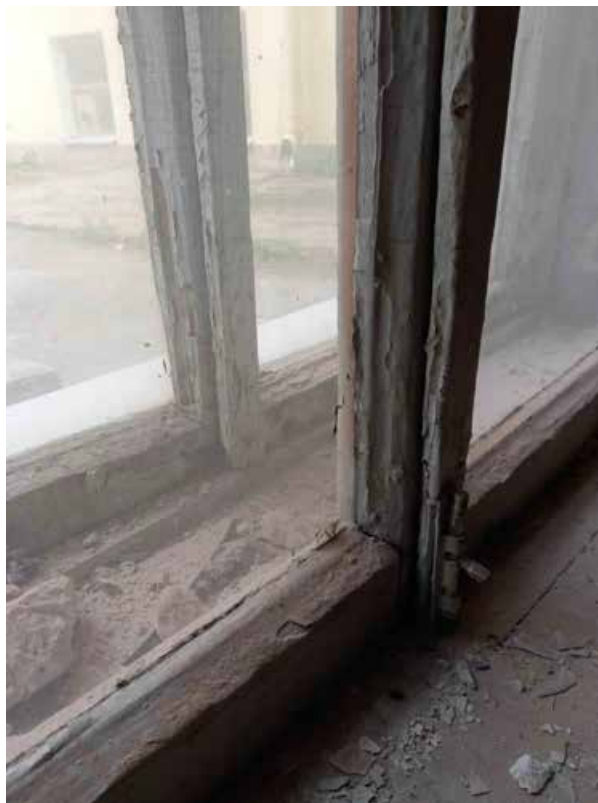
Фото 36. Фрагмент оконного заполнения, дворовой фасад, 1 этаж, вид из помещения. Наблюдаются следы биоповреждений, многочисленные следы поздней покраски, расхождение узловых соединений, загрязнение, механические повреждения древесины и покраски
