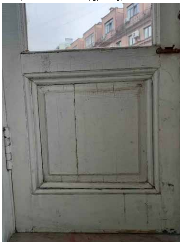
Фото 14. Балконная дверь (правая), вид из помещения. Наблюдается общий износ, трещины, разнообразная поздняя фурнитура, многочисленные следы (растрескивание) поздних покрасок
