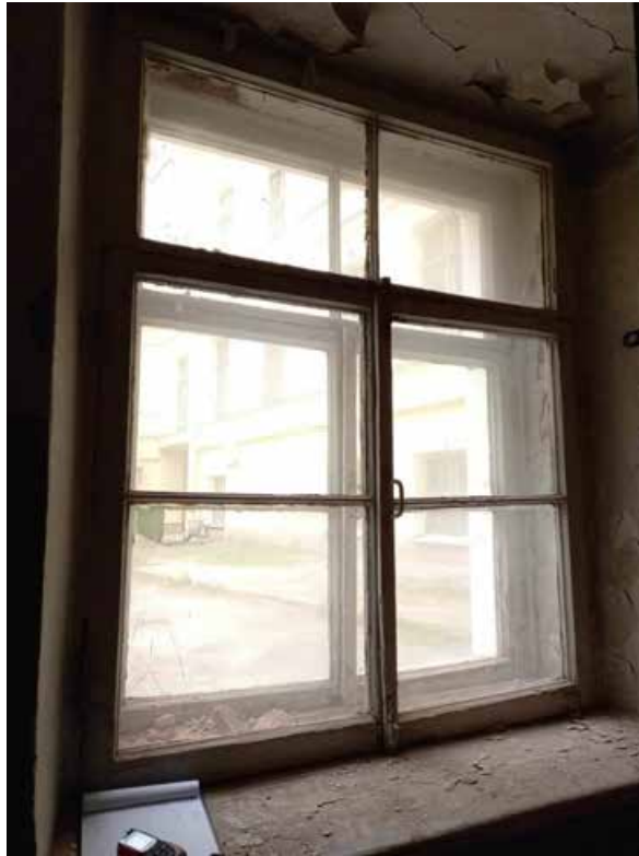
Фото 35. Оконное заполнение, дворовой фасад, 1 этаж, вид из помещения. Наблюдаются нарушения геометрии окна, следы биоповреждений, многочисленные следы поздней покраски, расхождение узловых соединений, загрязнение.
