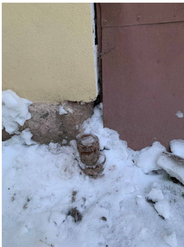
Фото 40. Фрагмент ворот дворового фасада. Элементы крепления створок. Наблюдаются следы коррозии, ржавчина
