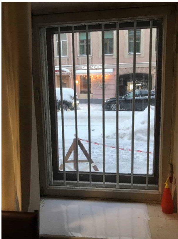
Фото 19. Оконное заполнение 1 этаж, лицевой фасад, вид из помещения. Наблюдаются нарушения красочного слоя, загрязнения, наружная рама и металлическая решетка поздние
