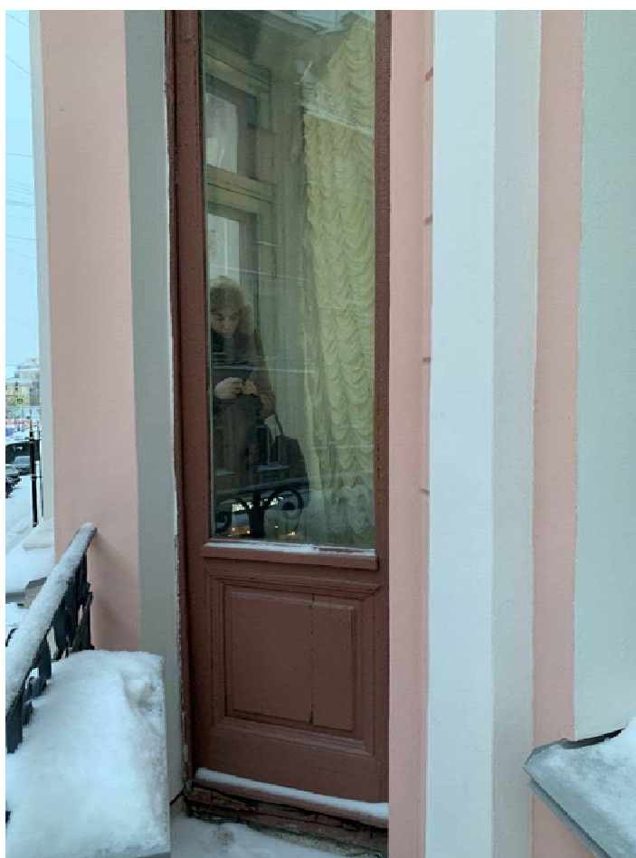
Фото 10. Лицевой фасад. Балконная дверь (правая) третьего этажа имеет следы биоповреждений, трещины, множественные лакокрасочные наслоения, поздние вставки
