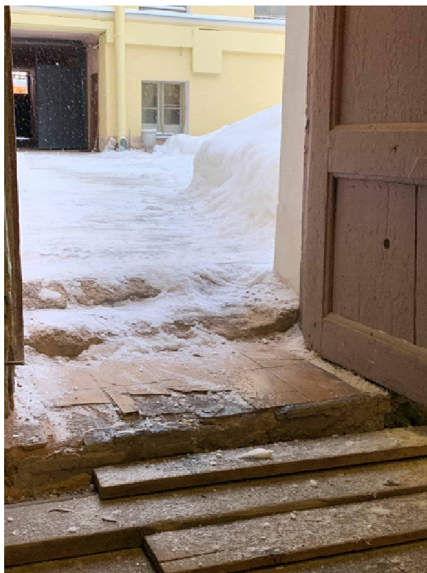
Фото 38. Дворовой фасад. Порог входа в помещение со двора. Наблюдаются разрушения дверной коробки, откоса
