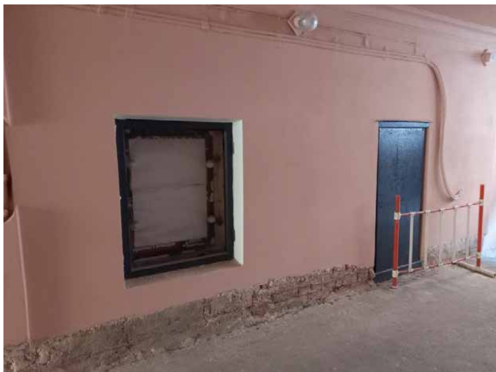
Фото 7. Стена арочного проезда. Оконное заполнение в нише, наружная рама поздняя, из помещения заложено кирпичом.
