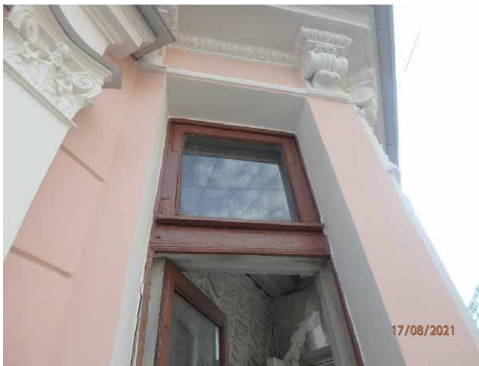
Фото 12. Лицевой фасад. Балконная дверь (левая) третьего этажа имеет дефекты и повреждения в виде трещин, коверн и поздних вставок
