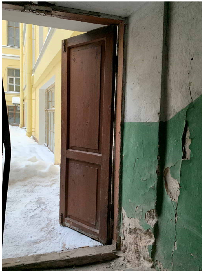
Фото 42. Дверное заполнение, 1 этаж, вид из помещения. Наблюдается перекос створок, следы биоповреждений, поздняя фурнитура
