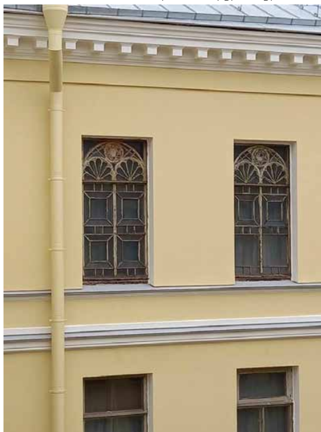
Фото 26. Дворовой фасад. Оконное заполнение, 3 этаж, парадная лестница. Наблюдаются утраты, следы биоповреждений.
