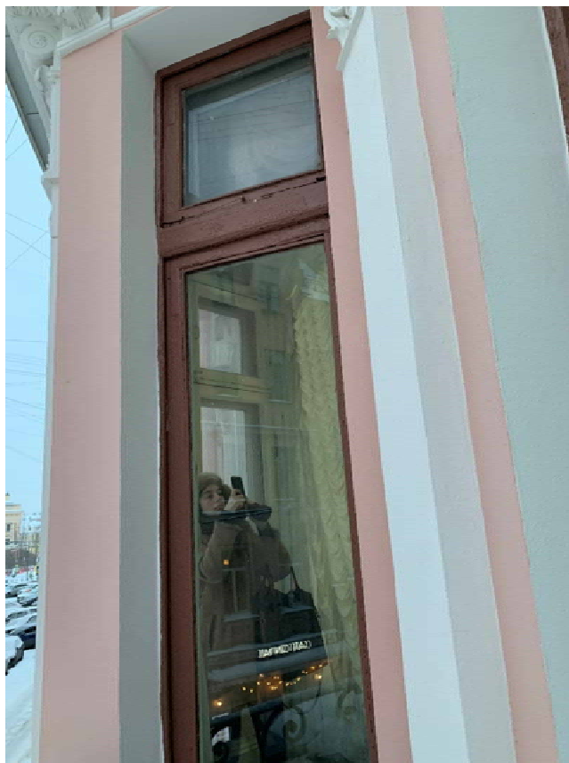
Фото 11. Лицевой фасад. Балконная дверь (правая) третьего этажа имеет следы биоповреждений, трещины, множественные лакокрасочные наслоения, поздние вставки
