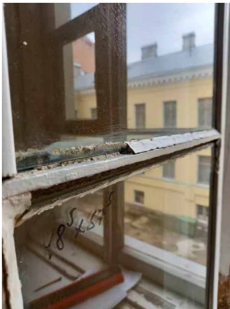
Фото 31. Фрагмент окна. Расхождение узловых соединений, нарушение герметизации стекольного заполнения.
