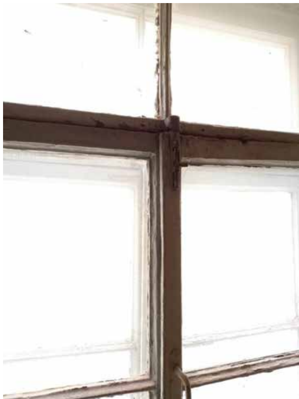
Фото 37. Фрагмент оконного заполнения, дворовой фасад, 1 этаж, вид из помещения. Наблюдаются следы биоповреждений, многочисленные следы поздней покраски, расхождение узловых соединений, загрязнение, механические повреждения древесины и покраски
