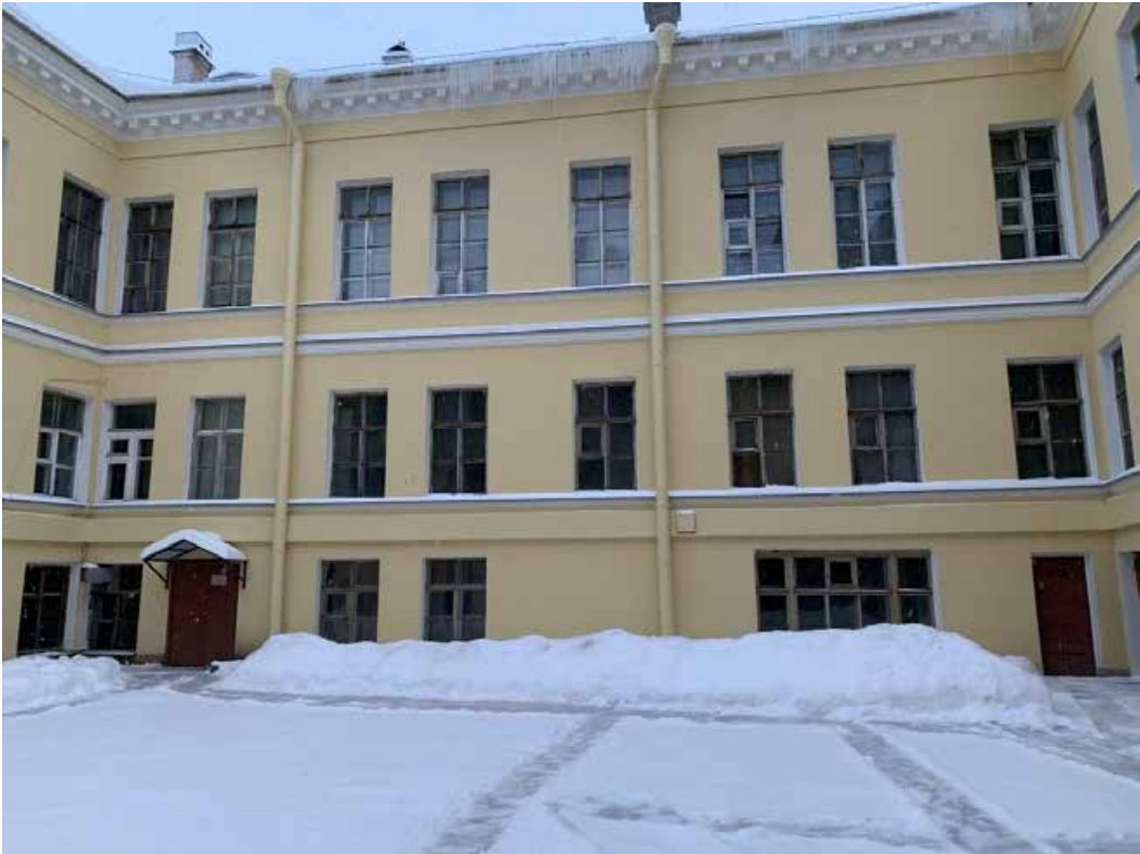
Фото 5. Дворовой фасад. Оконные заполнения за годы эксплуатации получили естественный физический износ, наблюдаются следы биоповреждений, деструкция древесины, поздние вставки и замены. Двери поздние, утилитарные.
