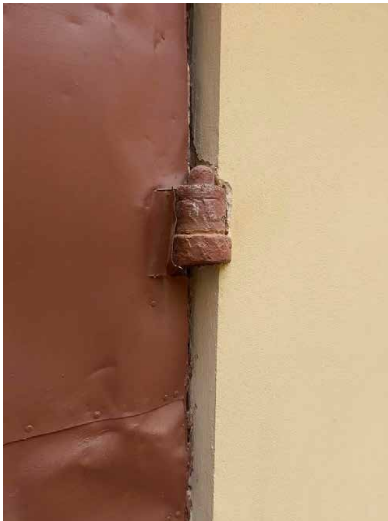
Фото 41. Фрагмент ворот дворового фасада. Элементы крепления створок. Наблюдаются следы коррозии, ржавчина
