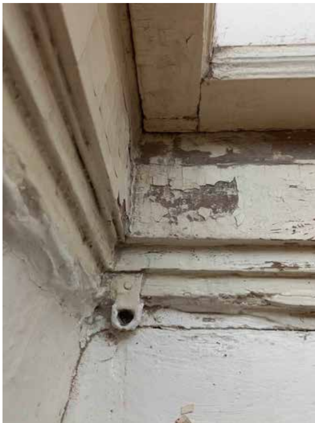
Фото 17. Оконное заполнение лицевого фасада, вид из помещения. Наблюдаются многочисленные следы поздней покраски, расхождение узловых соединений
