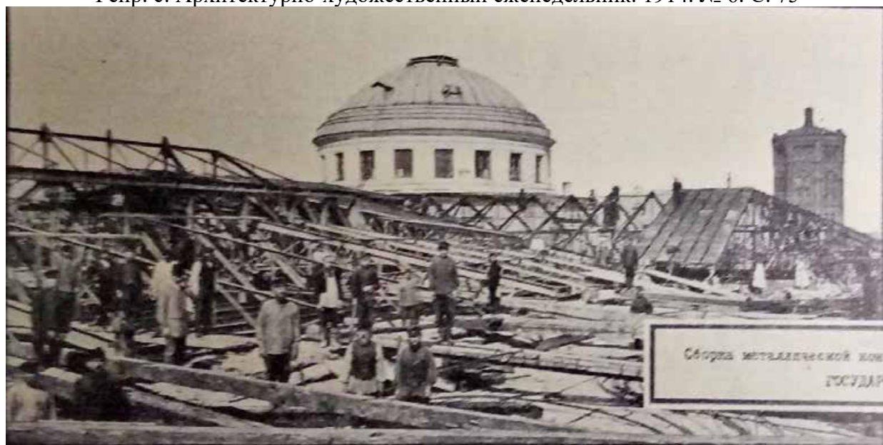
53. Сборка металлических конструкций над Залом заседаний. Фото 1910 г. // Репр. с: Архитектурно-художественный еженедельник. 1914. № 6. С. 75
