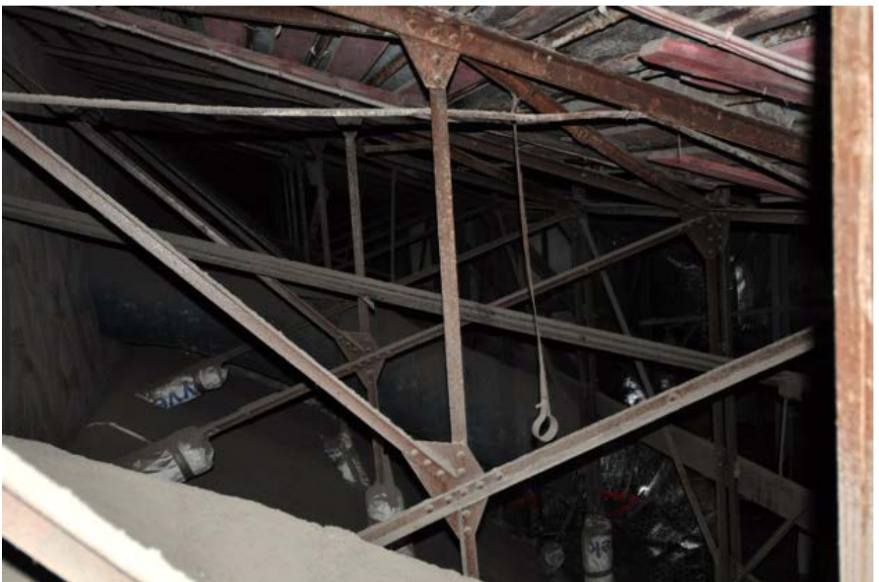
6. Фермы консольные фонаря Думского зала объекта культурного наследия федерального значения «Дворец Таврический. Дворец», расположенного по адресу: г. Санкт-Петербург, ул. Шпалерная, д. 47, лит. А. 15.10.2021
