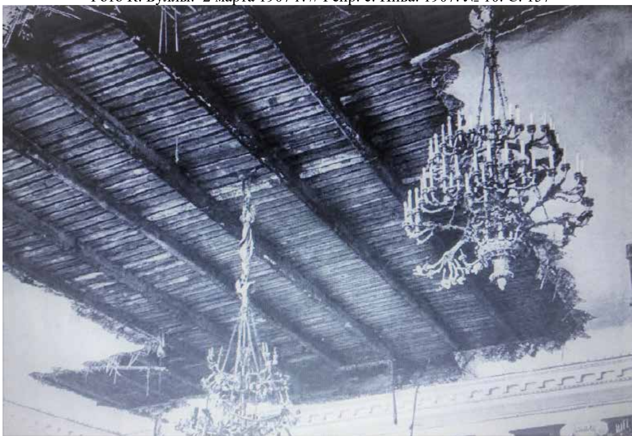
32. Часть обвалившегося потолка Зала заседаний с поврежденными люстрами Фото К. Буллы. 2 марта 1907 г. // Репр. с: Нива. 1907. № 10. С. 157
