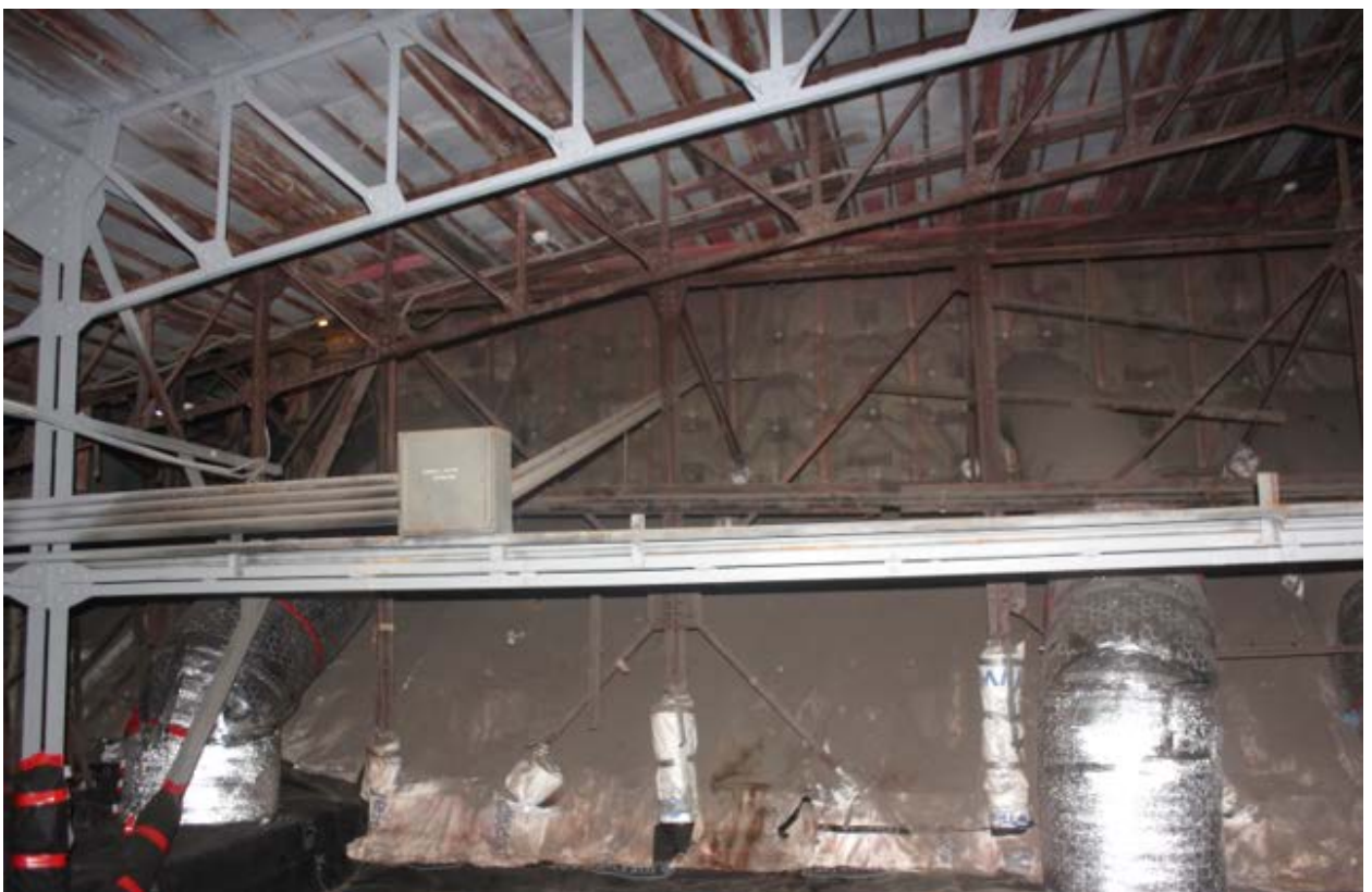
4. Фермы фонаря Думского зала объекта культурного наследия федерального значения «Дворец Таврический. Дворец», расположенного по адресу: г. Санкт-Петербург, ул. Шпалерная, д. 47, лит. А. 15.10.2021
