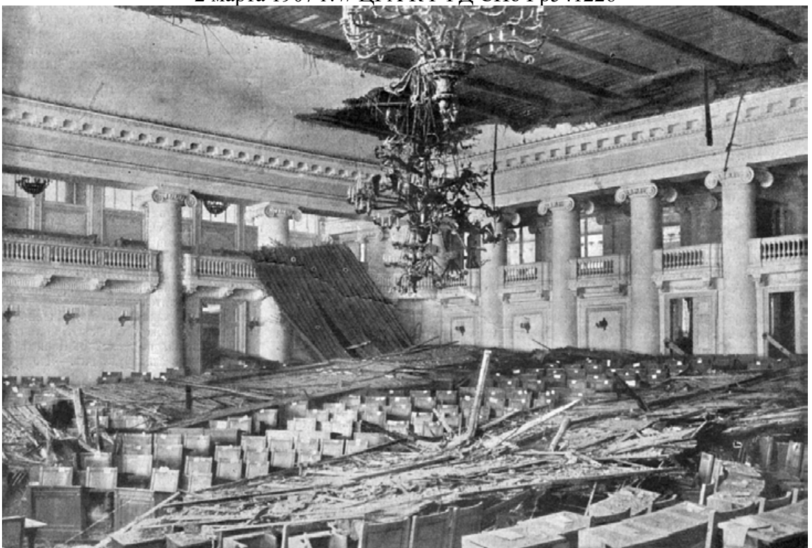
25. Обрушение потолка в зале заседаний 2 марта 1907 г. // ЦГА КФФД СПб Гр541227
