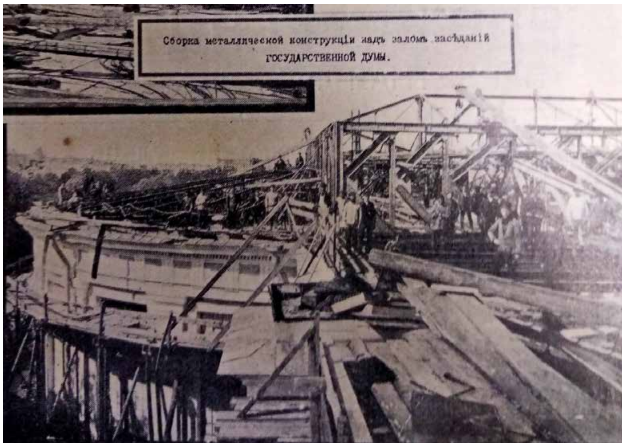
52. Сборка металлических конструкций над Залом заседаний. Фото 1910 г. // Репр. с: Архитектурно-художественный еженедельник. 1914. № 6. С. 75
