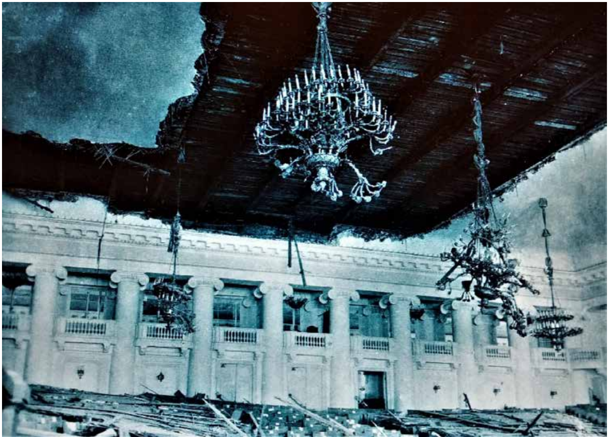
28. Обрушение потолка в зале заседаний 2 марта 1907 г. Лист из альбома фотоснимков «Разрушение штукатурки в Государственной думе 2 марта 1907 года». // РГИА. Ф. 1405. Оп. 539. Д. 425. Л. 3
