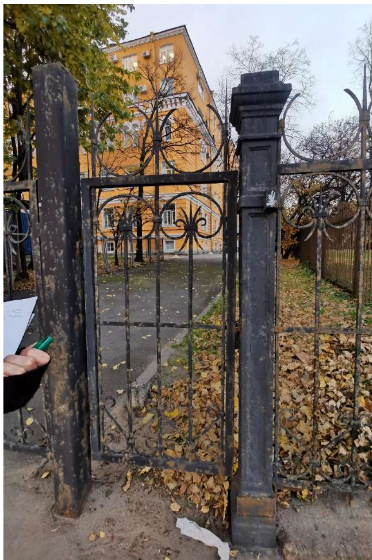
Фото №16. Вид на калитку и историческую стойку со стороны Арсенальной набережной. С утратой декоративного элемента «шишки». Часть цоколя укреплена поздней металлической пластиной. Коррозия металла. Сколы и выбоины на гранитном цоколе.
