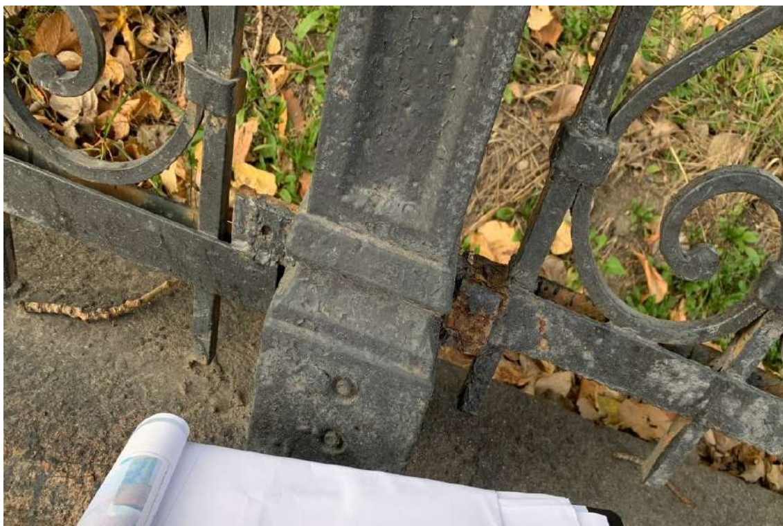
Фото №11. Коррозия металла в зоне заклепочного соединения. Общая загрязненность.
