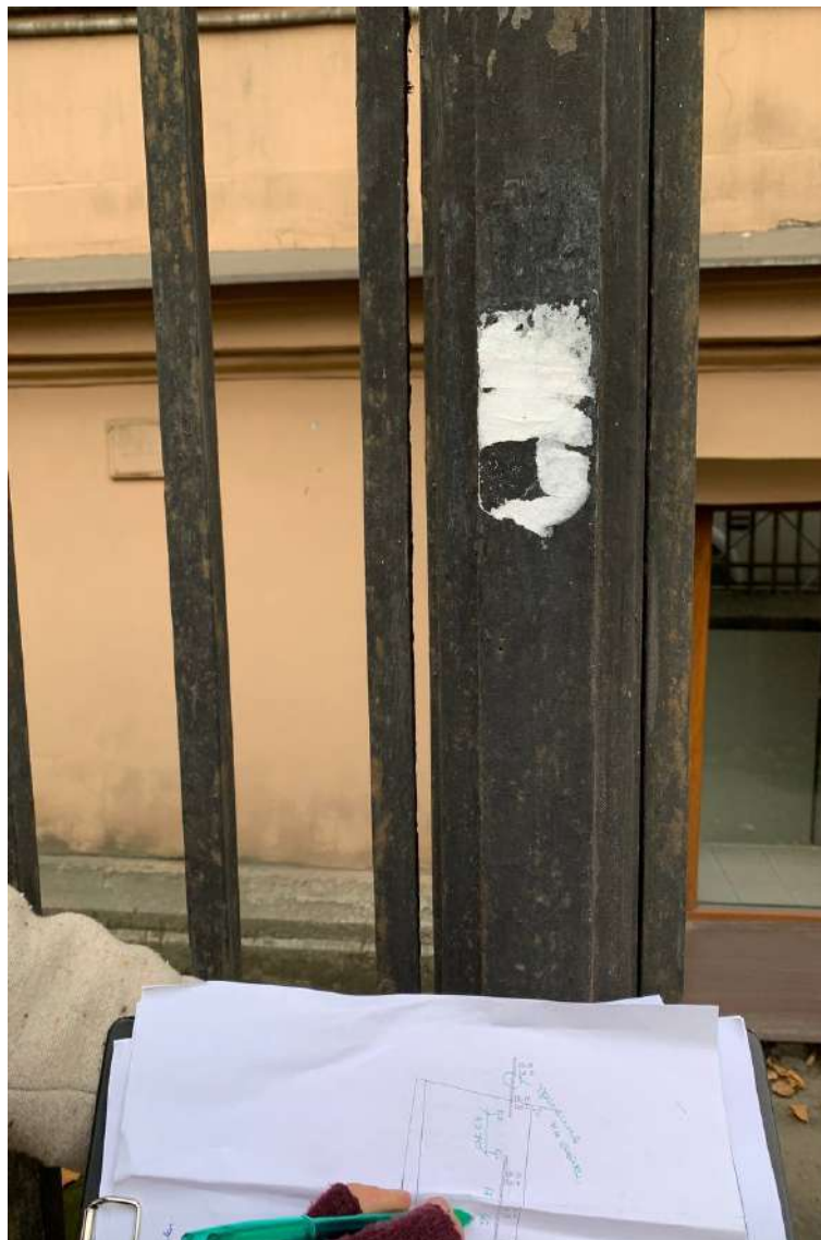
Фото №27. Изгиб вертикального стержня решетки со стороны ул. Комсомола.
