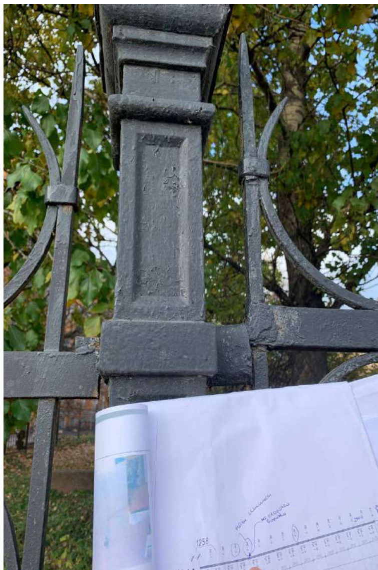
Фото №9. Коррозия металла в зоне сварного шва. Коррозия хомута.
