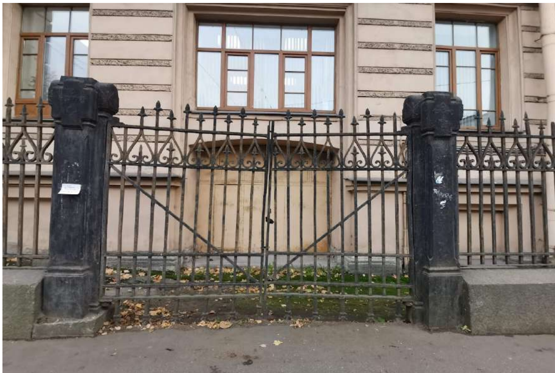
Фото №28. Вид на ворота со стороны ул. Комсомола., разрушение цоколя левого пилона. Утеря пирамидальных завершений на обоих пилонах. Отклонение от вертикали створок ворот. Изгиб вертикального стержня. Заглубление нижних декоративных элементов ниже дневной поверхности. Общая загрязненность.
