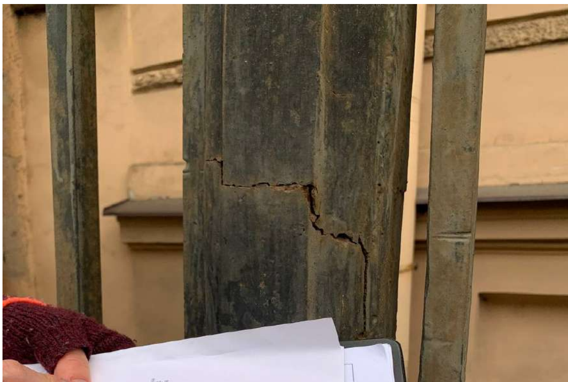
Фото №25. Поперечная трещина на исторической стойке.
