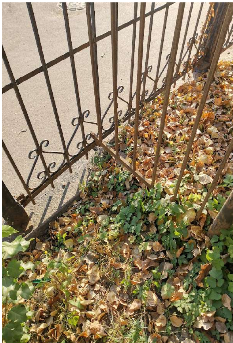
Фото №15. Примыкание секции внутреннего ограждения к секции ограждения со стороны Арсенальной набережной. Отсутствие соединительной стойки. Коррозия красочного слоя
