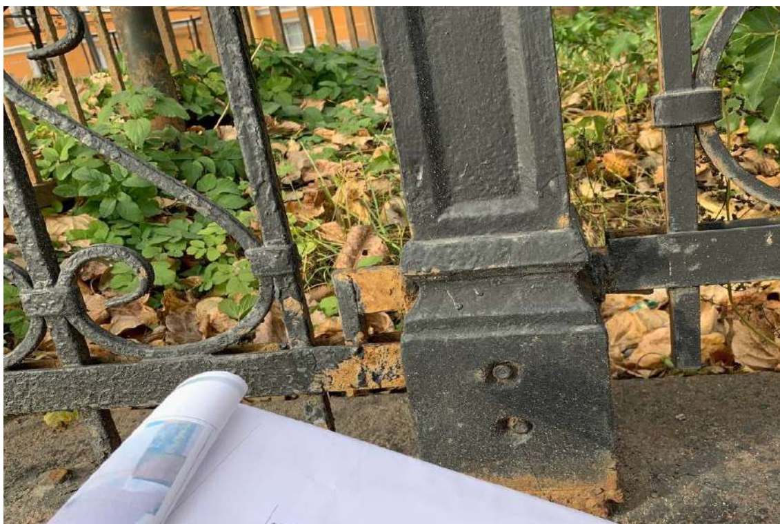
Фото №12. Коррозия металла. Общая загрязненность.
