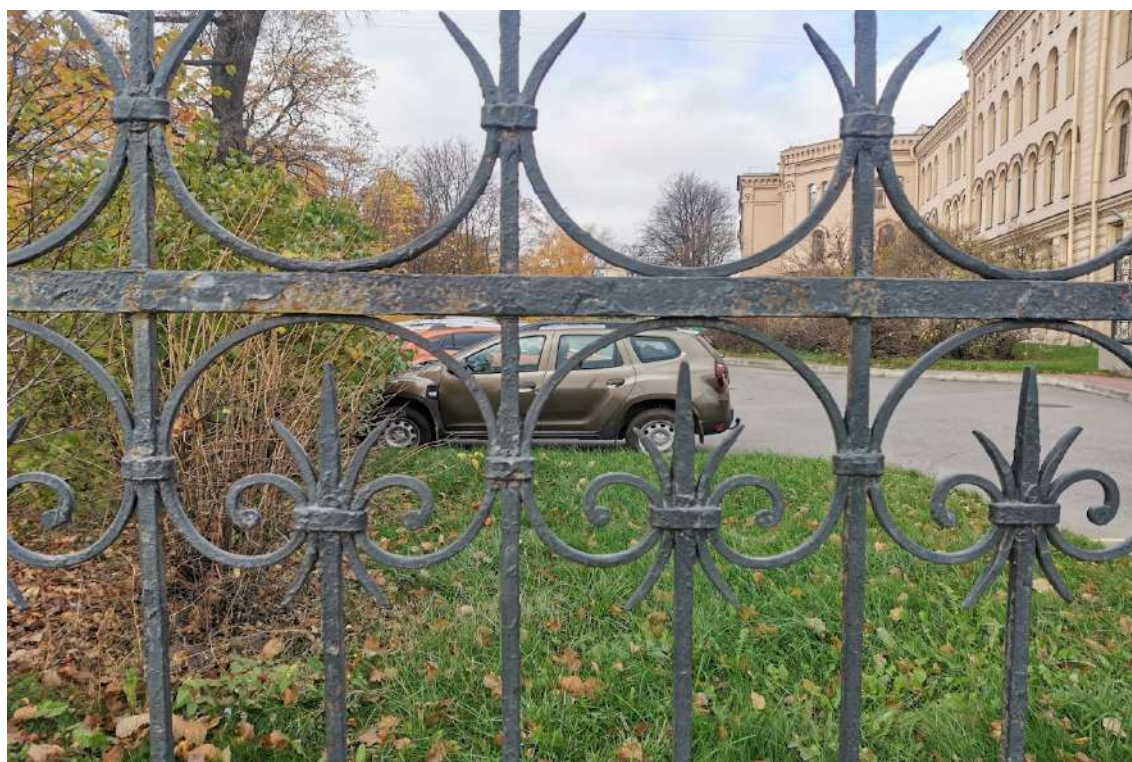
Фото №7. Фрагмент ограды со стороны Адмиралтейской набережной. Наблюдается коррозия.
