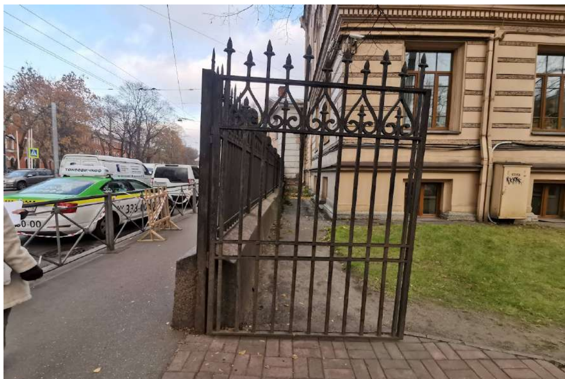
Фото №23. Вид на калитку со стороны ул. Комсомола. Шелушение красочного слоя. Отклонение от вертикали стойки калитки. Общая загрязненность.
