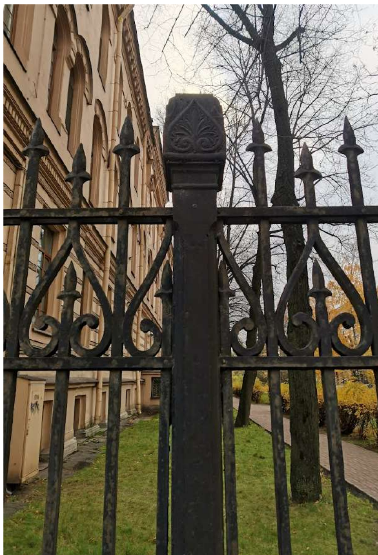
Фото №24. Вид на фрагмент исторической стойки со стороны ул. Комсомола. Коррозия металла. Общая загрязненность. Шелушение красочного слоя.
