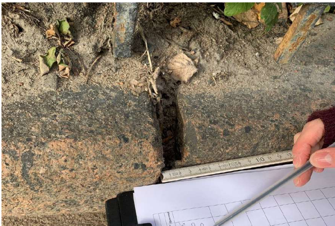
Фото №14. Выветривание шовного раствора. Зазор между цокольными камнями. Общая загрязненность.
