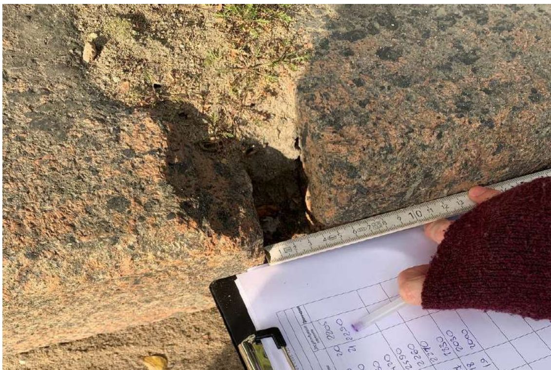
Фото №13. Расхождение шва между соседними гранитными цоколями. Загрязнение красочным составом.
