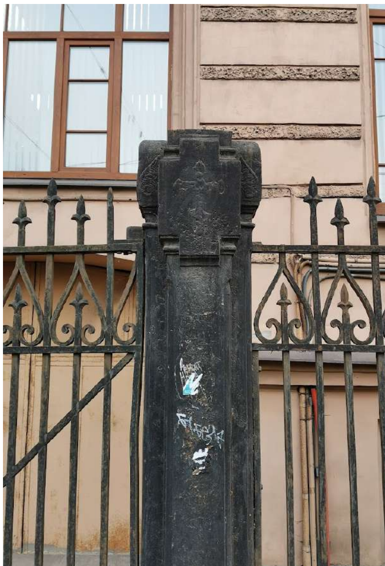
Фото №30. Вид на фрагмент исторического пилона. Утеря пирамидального завершения. Общая загрязненность. Шелушение красочного слоя.
