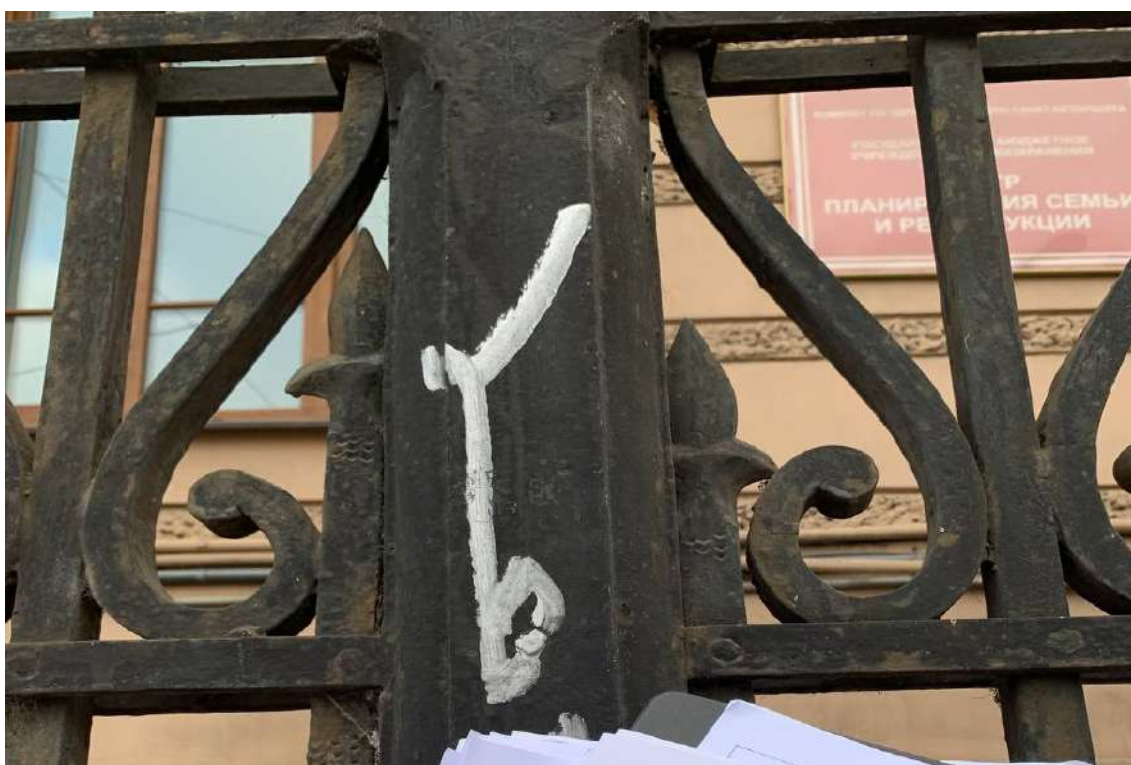
Фото №26. Загрязнение краской. Общая загрязненность. Коррозия металла.
