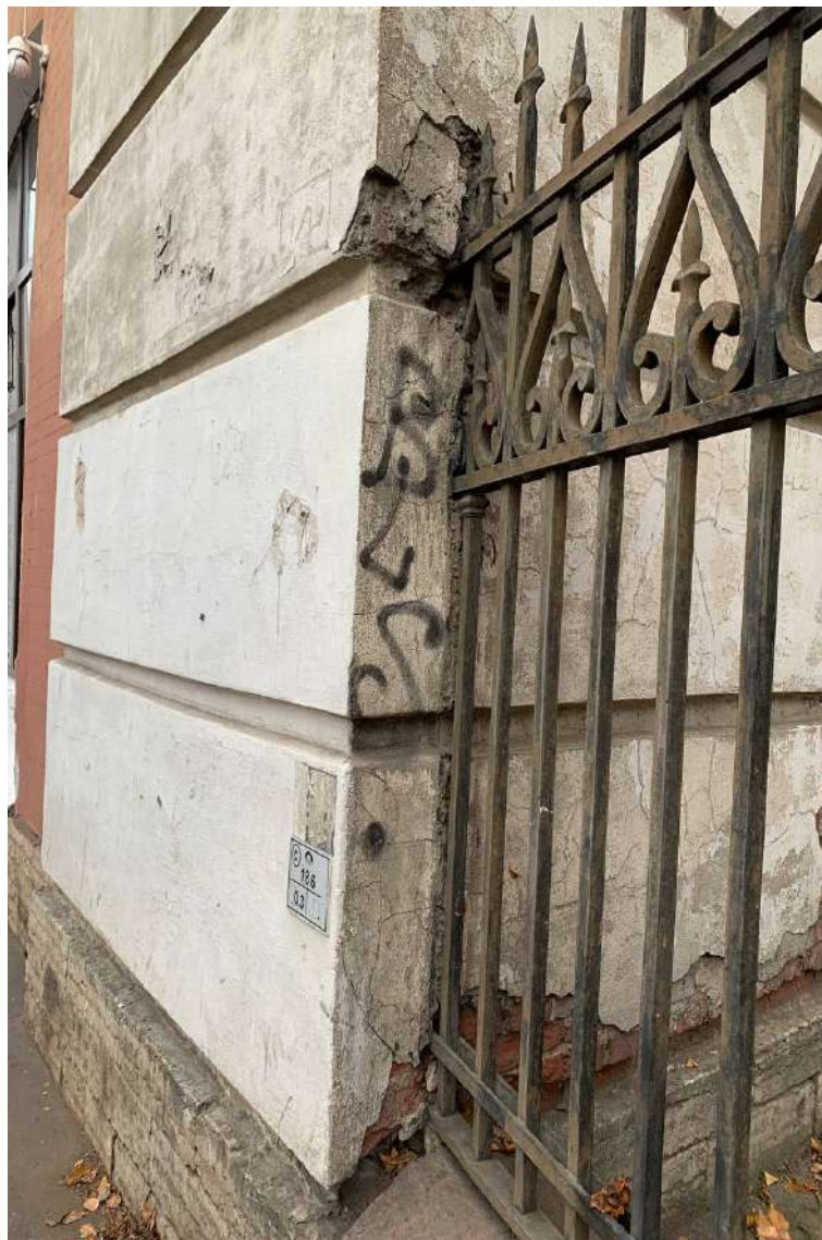
Фото №29. . Нарушение заделки секции в соседнее здание со стороны ул. Комсомола.
