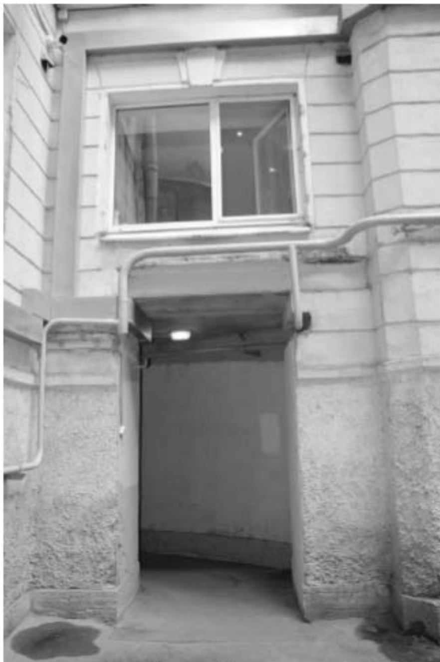
20. Арка прохода во внутренний двор. Оформление оконного проема над аркой. Вид с юга
