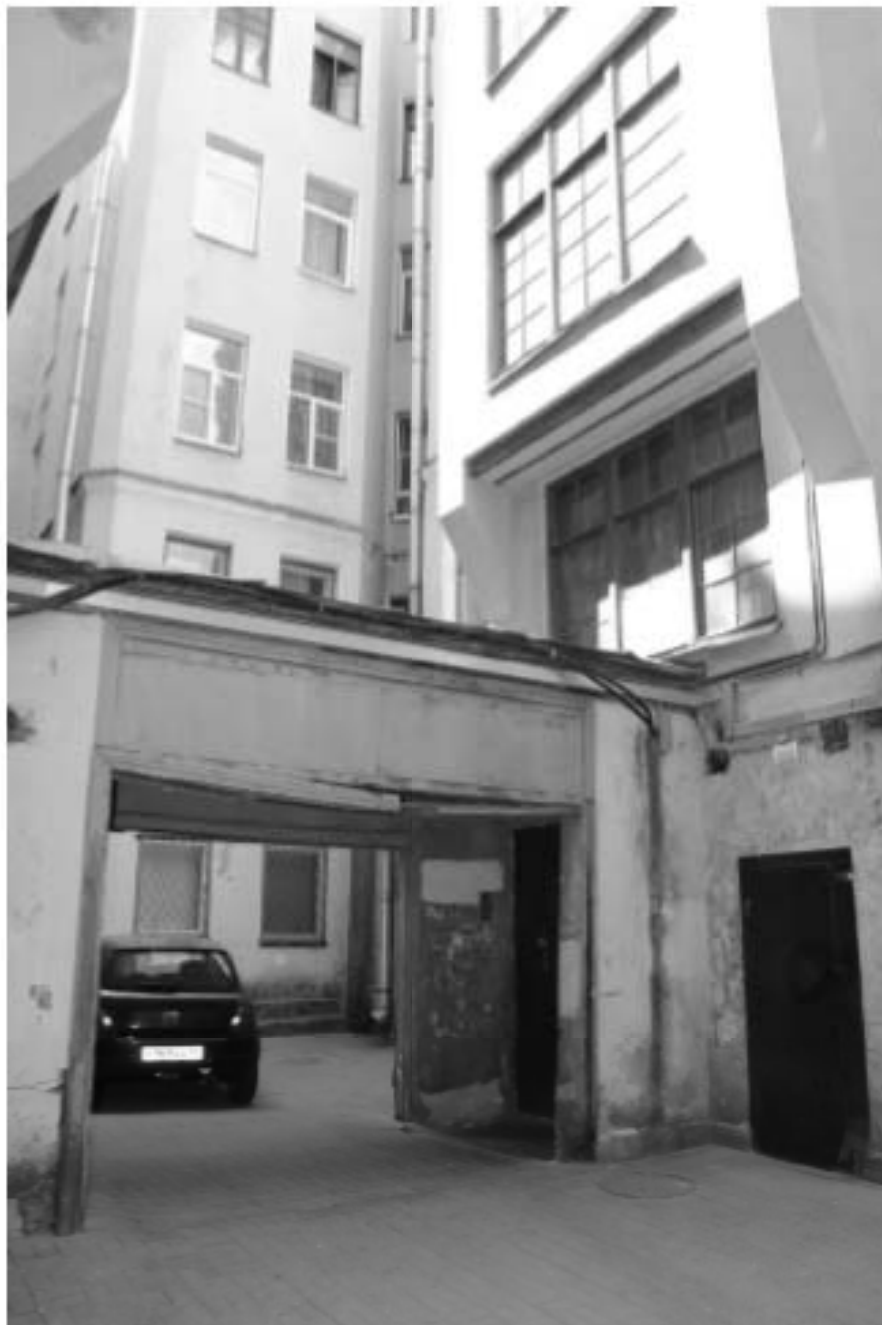
8. Фрагмент фасада внутреннего двора здания. Арка, соединяющая литеру А и литеру Б, с дверью входа в парадную литеры Б. Вид с востока
