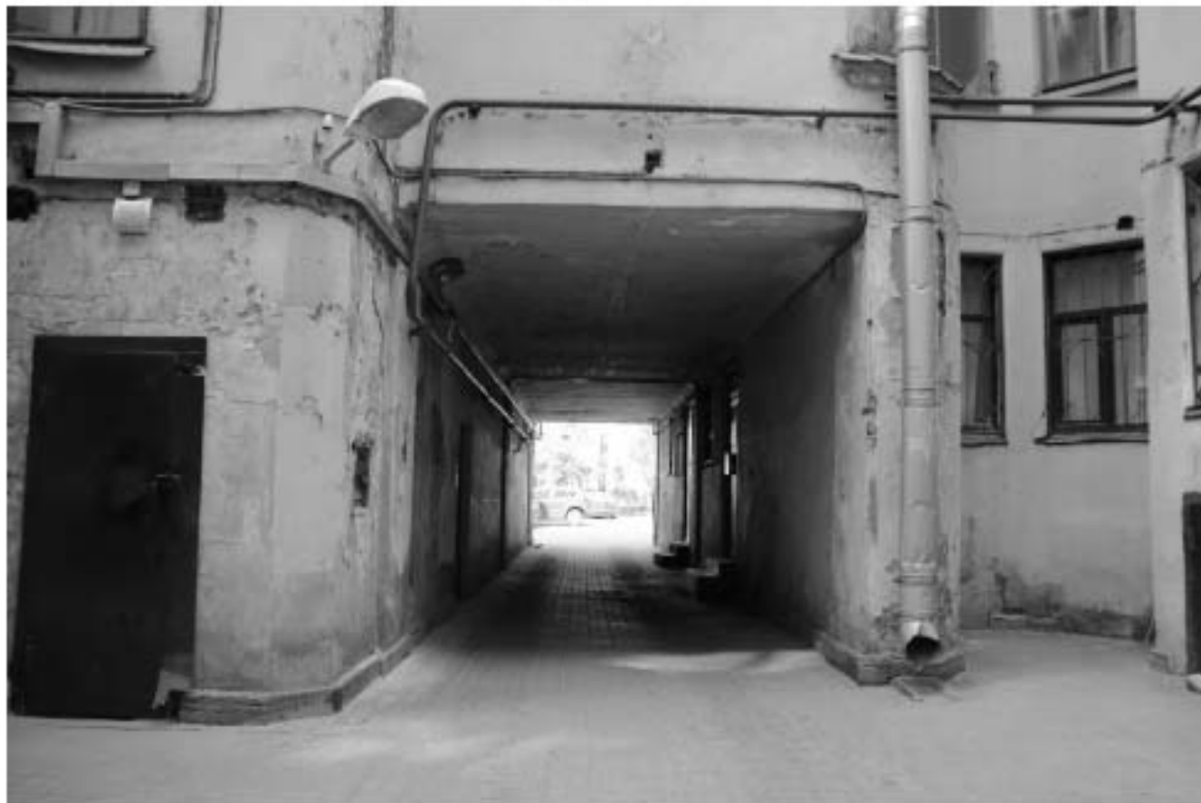
6. Проездная арка. Вид от здания литеры А во внутренний двор. Вид с юго-востока
