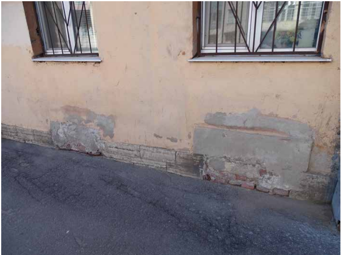
Фото 13 Здание по адресу: г. Санкт-Петербург, Большая Зеленина ул., дом 29, литера Б. Фрагмент лицевого фасада по ул. Петрозаводской. Цоколь. Съемка 19.04.2021 г. Штиглиц М. С.
