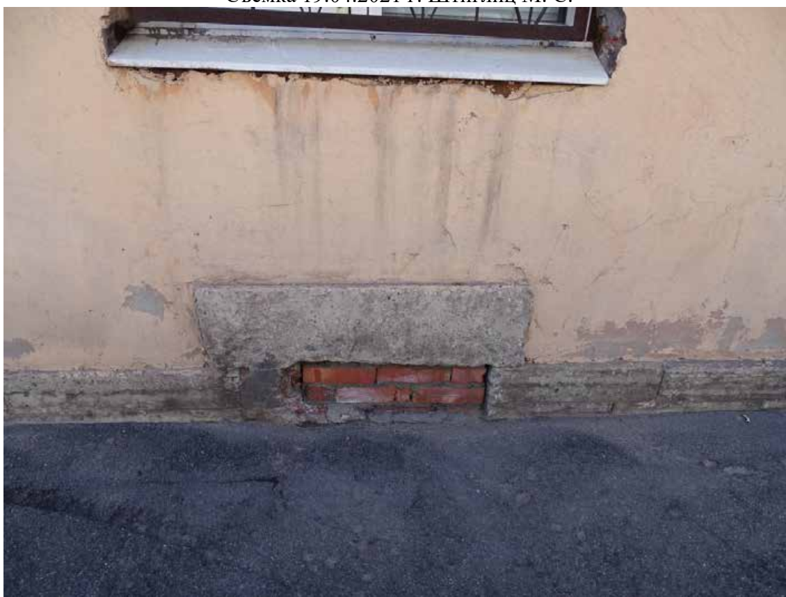
Фото 12. Здание по адресу: г. Санкт-Петербург, Большая Зеленина ул., дом 29, литера Б. Фрагмент лицевого фасада по ул. Петрозаводской. Цоколь. Оконный проем в уровне подвала. Съемка 19.04.2021 г. Штиглиц М. С.
