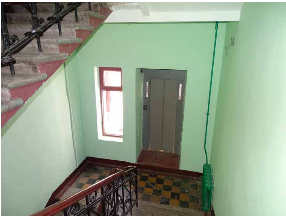
Фото 98. Лестница ЗЛК. Площадка между 2-м и 3-м этажом. Съемка 19.04.2021 г. Штиглиц М. С.
