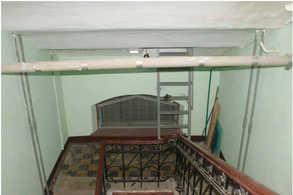
Фото 110. Лестница ЗЛК. Площадка между 5-м и 6-м этажом. Съемка 19.04.2021 г. Штиглиц М. С.
