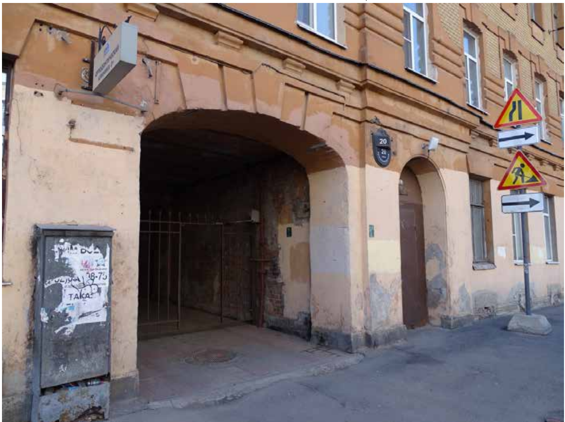
Фото 14. Здание по адресу: г. Санкт-Петербург, Большая Зеленина ул., дом 29, литера Б. Фрагмент лицевого фасада по ул. Петрозаводской. Воротный проезд. Съемка 19.04.2021 г. Штиглиц М. С.
