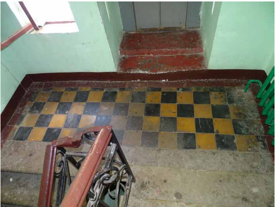
Фото 95. Лестница 3ЛК. Площадка между 1-м и 2-м этажом. Покрытие пола. Съемка 19.04.2021 г. Штиглиц М. С.
