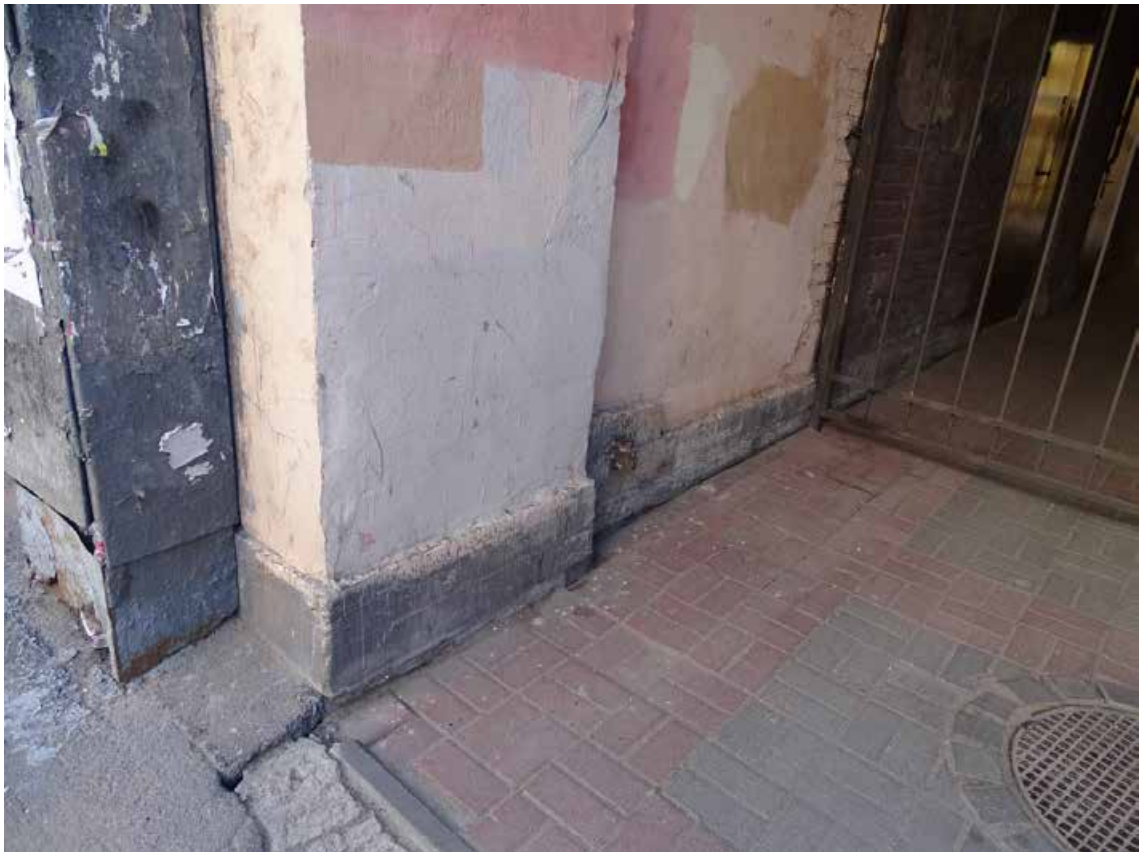
Фото 15. Здание по адресу: г. Санкт-Петербург, Большая Зеленина ул., дом 29, литера Б. Воротный проезд по фасаду ул. Петрозаводской. Цоколь. Съемка 19.04.2021 г. Штиглиц М. С.
