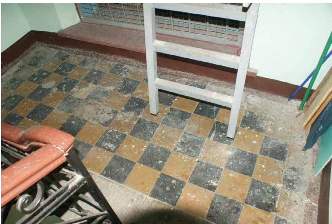
Фото 113. Лестница ЗЛК. Площадка между 5-м и 6-м этажом. Выход на кровлю. Съемка 19.04.2021 г. Штиглиц М. С.
