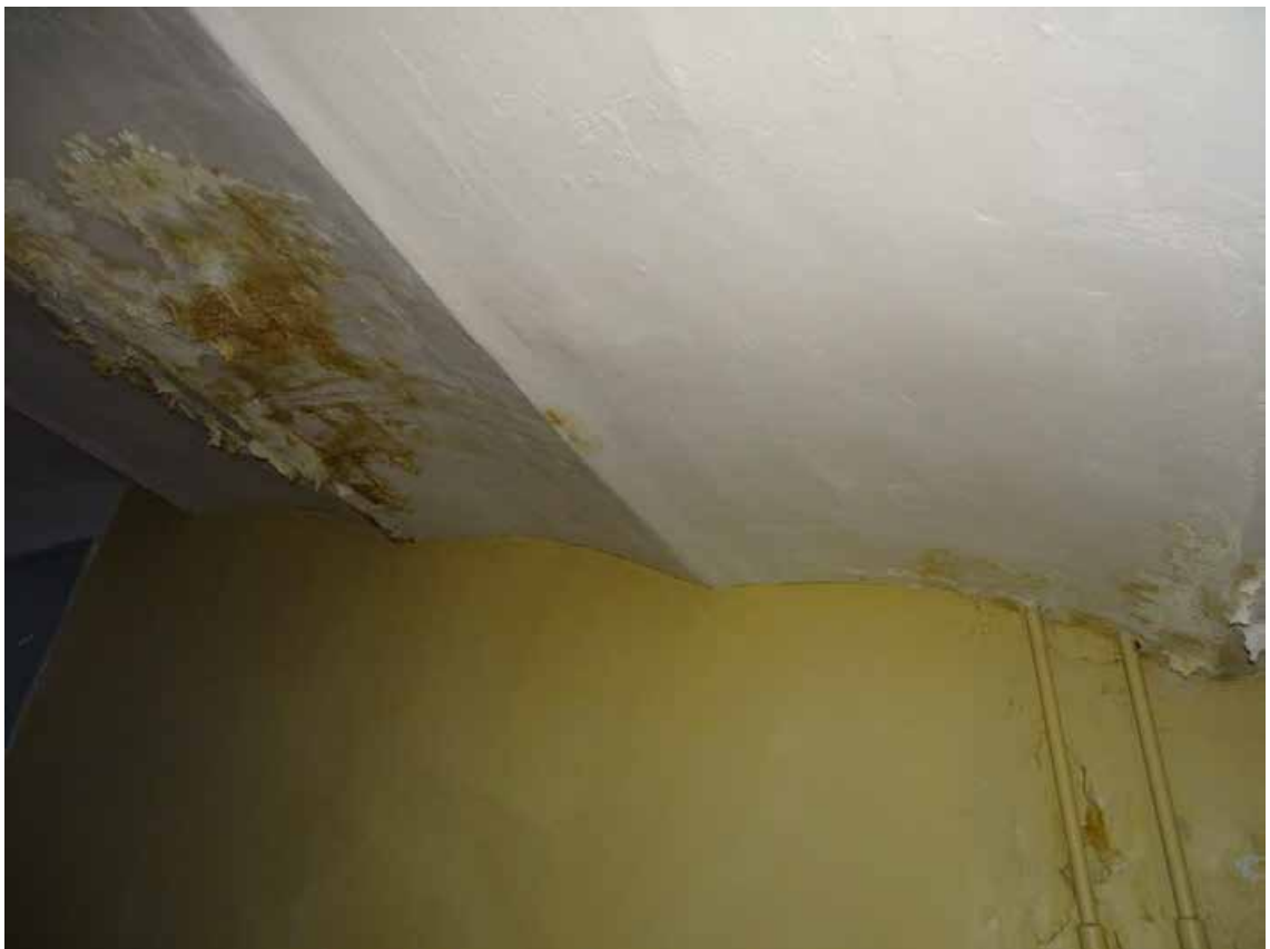
Фото 32. Лестница 1ЛК. Площадка между 5-м и чердачным этажом. Своды. Съемка 19.04.2021 г. Штиглиц М. С.
