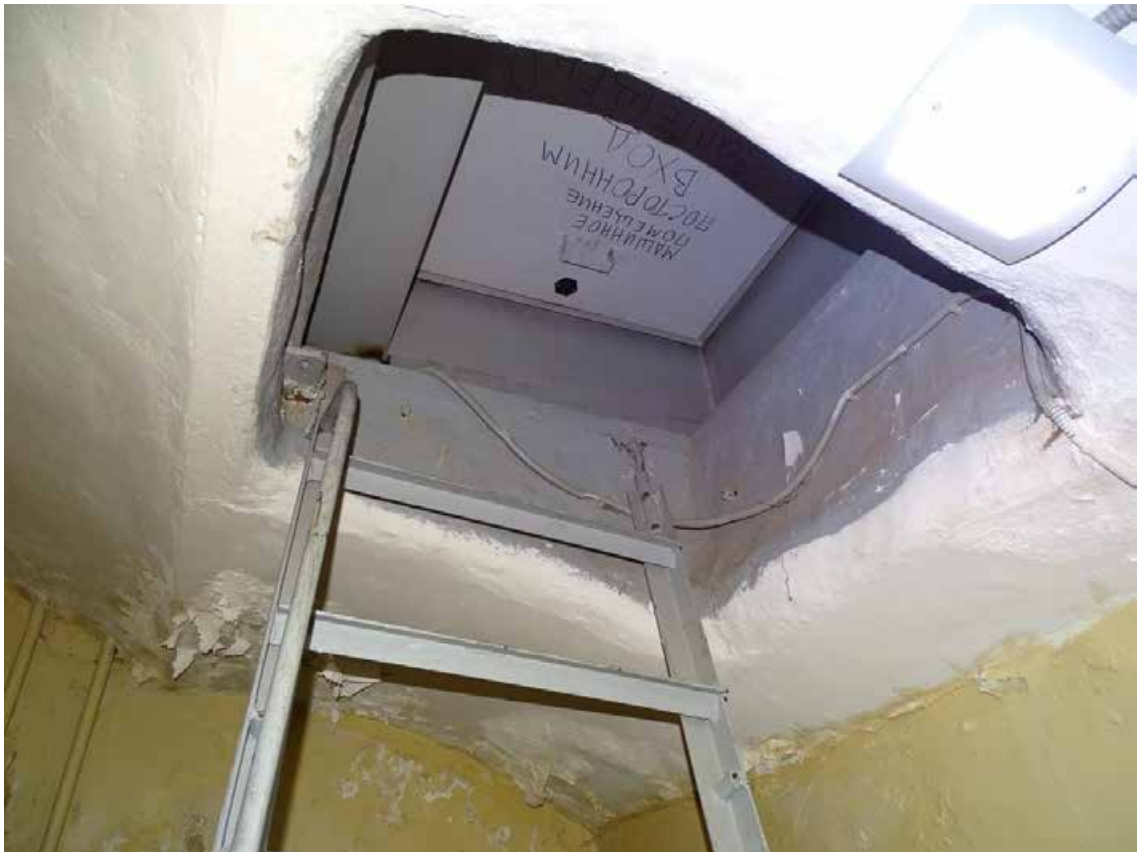
Фото 31. Лестница 1ЛК. Площадка между 5-м и чердачным этажом. Съемка 19.04.2021 г. Штиглиц М. С.
