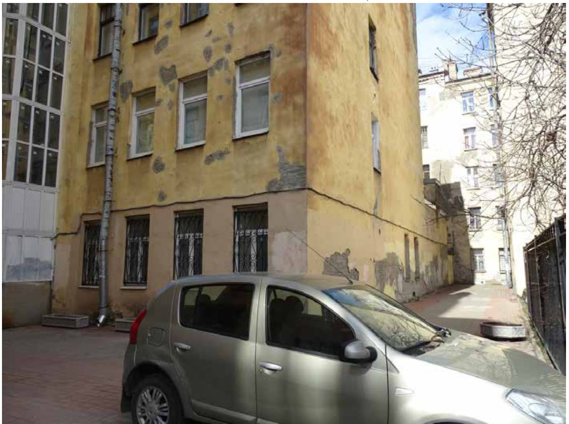
Фото 32. Здание по адресу: г. Санкт-Петербург, Большая Зеленина ул., дом 29, литера Б. Фрагмент северо-восточного фасада 5-ти этажного корпуса. Съемка 19.04.2021 г. Штиглиц М. С.
