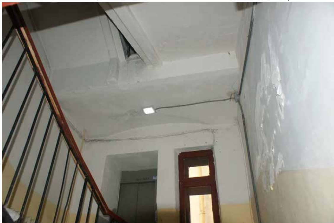
Фото 12. Лестница 1ЛК. Площадка между 1-м и 2-м этажом. Съемка 19.04.2021 г. Штиглиц М. С.
