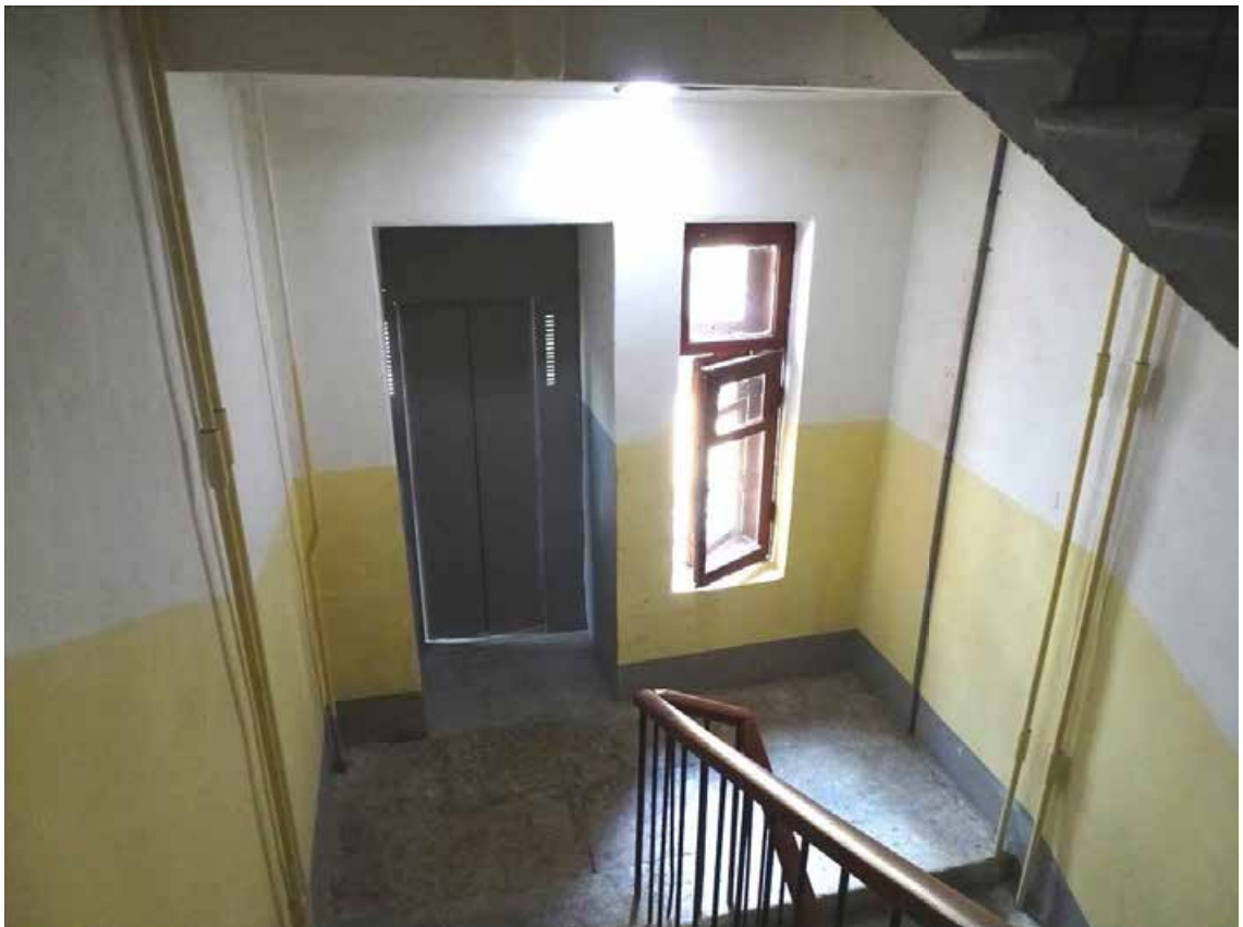
Фото 22. Лестница 1ЛК. Площадка между 4-м и 5-м этажом. Съемка 19.04.2021 г. Штиглиц М. С.
