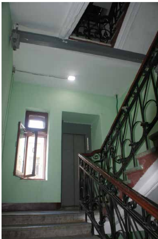
Фото 104. Лестница ЗЛК. Площадка между 4-м и 5-м этажом. Съемка 19.04.2021 г. Штиглиц М. С.
