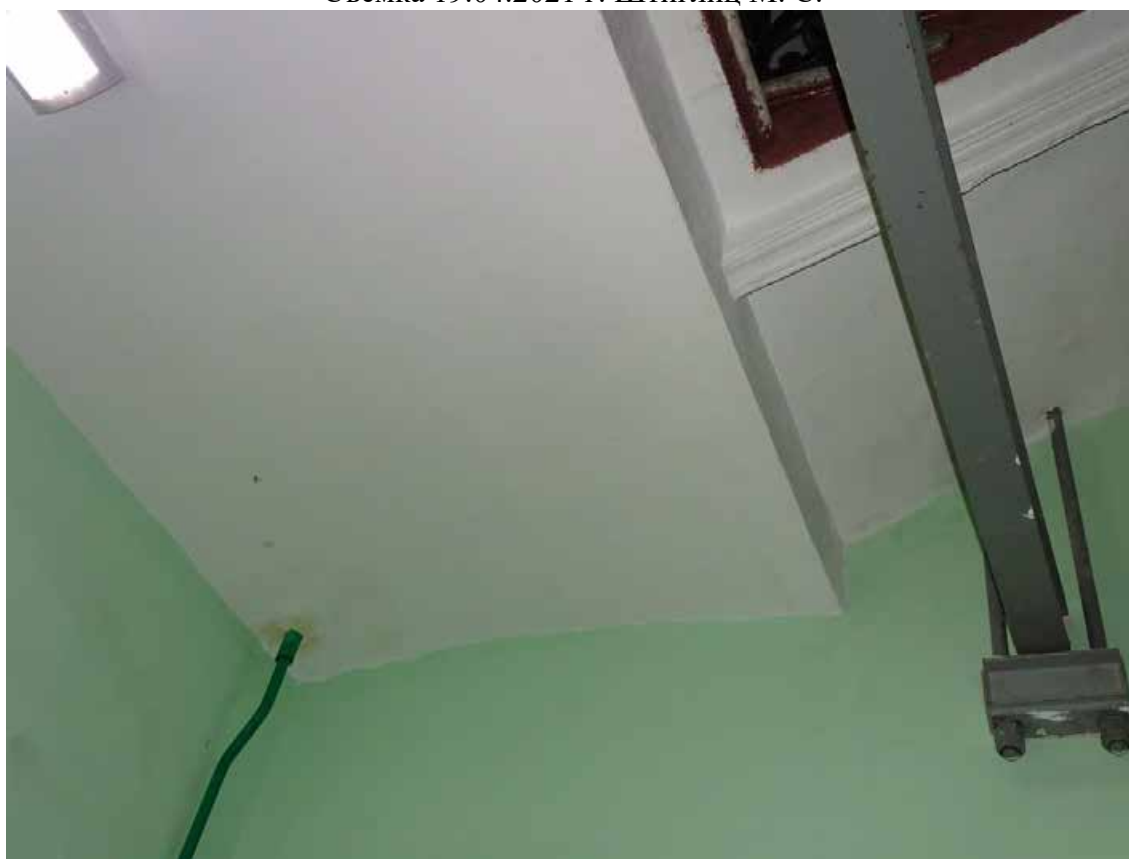
Фото 105. Лестница ЗЛК. Площадка между 4-м и 5-м этажом. Съемка 19.04.2021 г. Штиглиц М. С.
