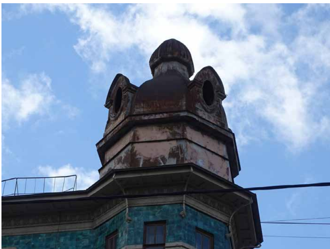
Фото 18. Здание по адресу: г. Санкт-Петербург, 11-я линия В. О., 34/47, литера А. Фигурный купол над угловым эркером. Съемка 19.04.2021 г. Кириков Б. М.
