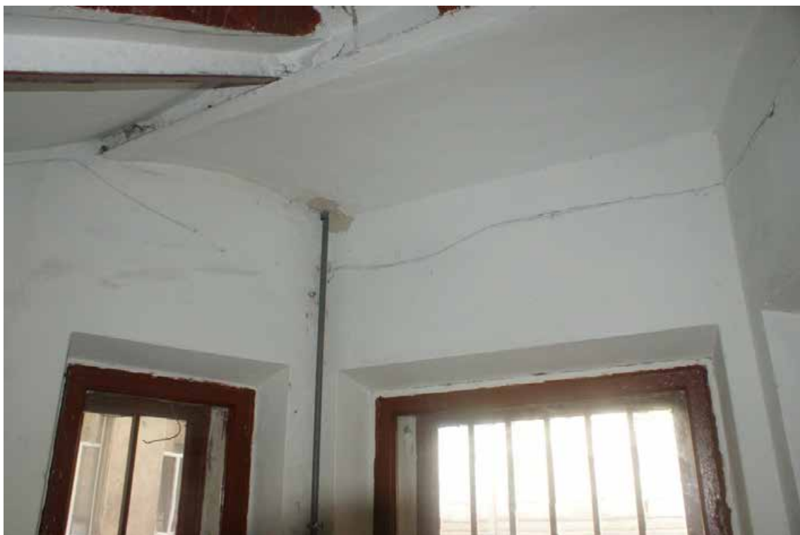
Фото 133. Лестница № 4. Площадка м/у 2-м и 3-м этажом. Съемка 19.04.2021 г. Кириков Б. М.
