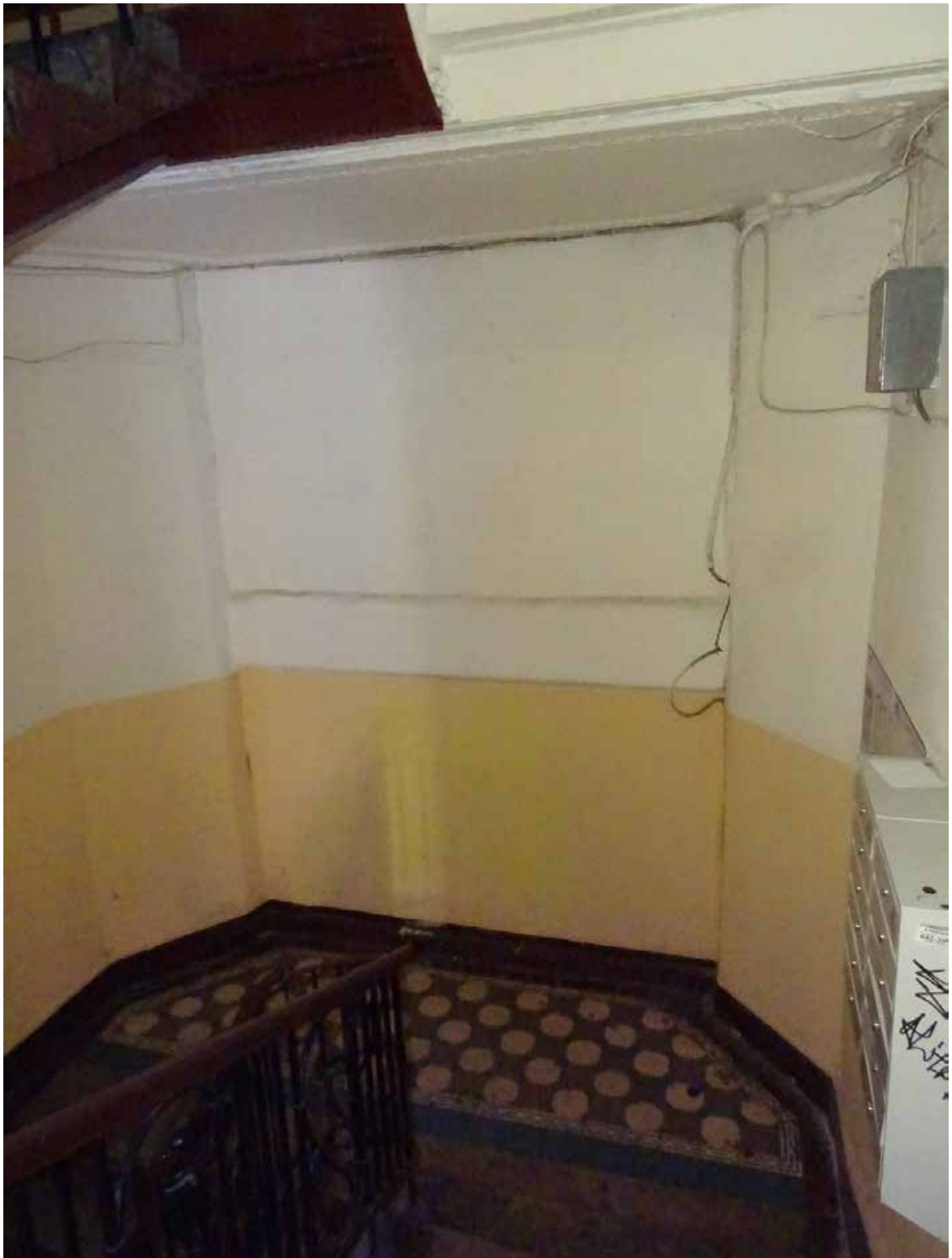
Фото 16. Лестница № 1. Площадка м/у 1-м и 2-м этажом. Съемка 19.04.2021 г. Кириков Б. М.
