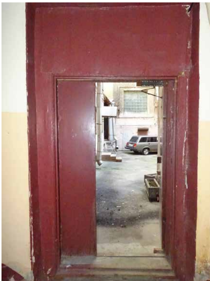
Фото 73. Лестница № 3. 1-й этаж. Вход в лестничную клетку. Съемка 19.04.2021 г. Кириков Б. М.
