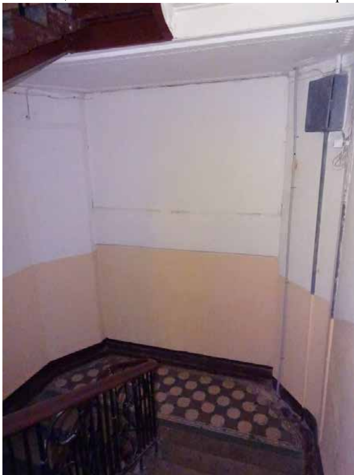
Фото 26. Лестница № 1. Площадка м/у 3-м и 4-м этажом. Съемка 19.04.2021 г. Кириков Б. М.
