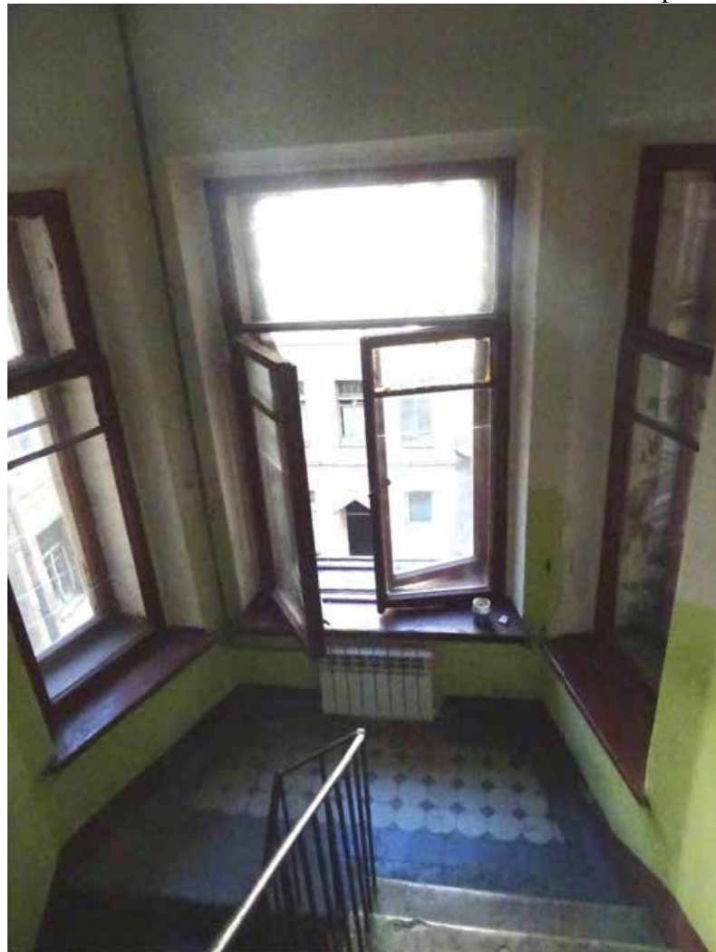
Фото 136. Лестница № 4. Площадка м/у 3-м и 4-м этажом. Съемка 19.04.2021 г. Кириков Б. М.
