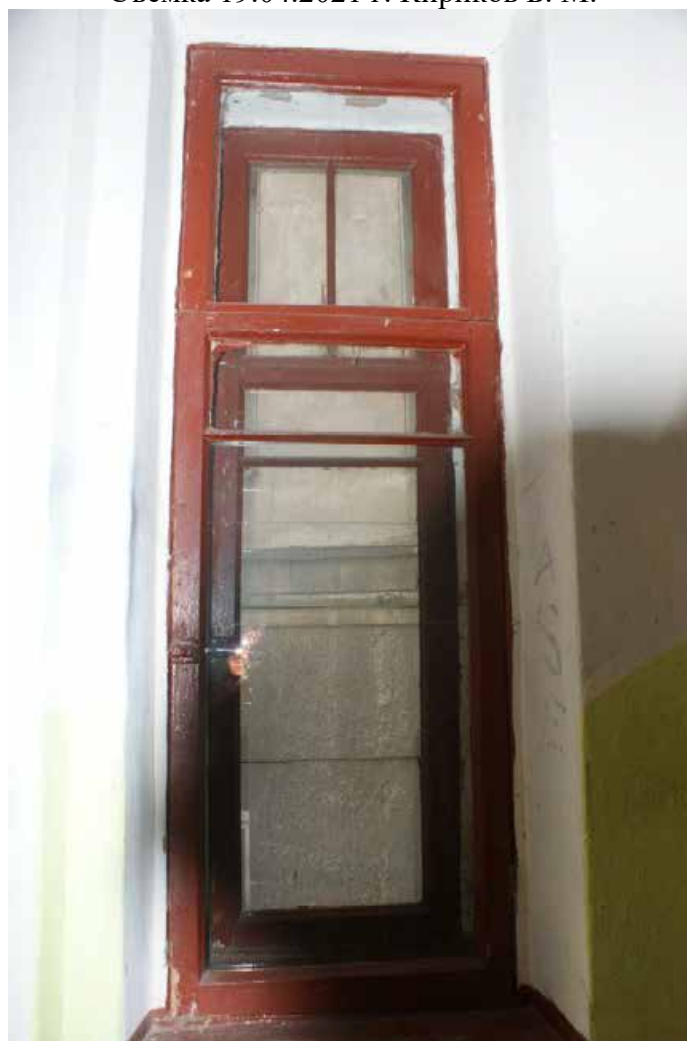
Фото 132. Лестница № 4. Площадка м/у 2-м и 3-м этажом. Съемка 19.04.2021 г. Кириков Б. М.
