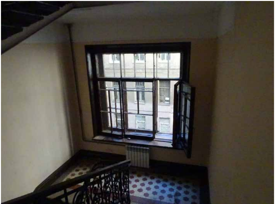
Фото 52. Лестница № 2. Площадка м/у 2-м и 3-м этажом. Съемка 19.04.2021 г. Кириков Б. М.
