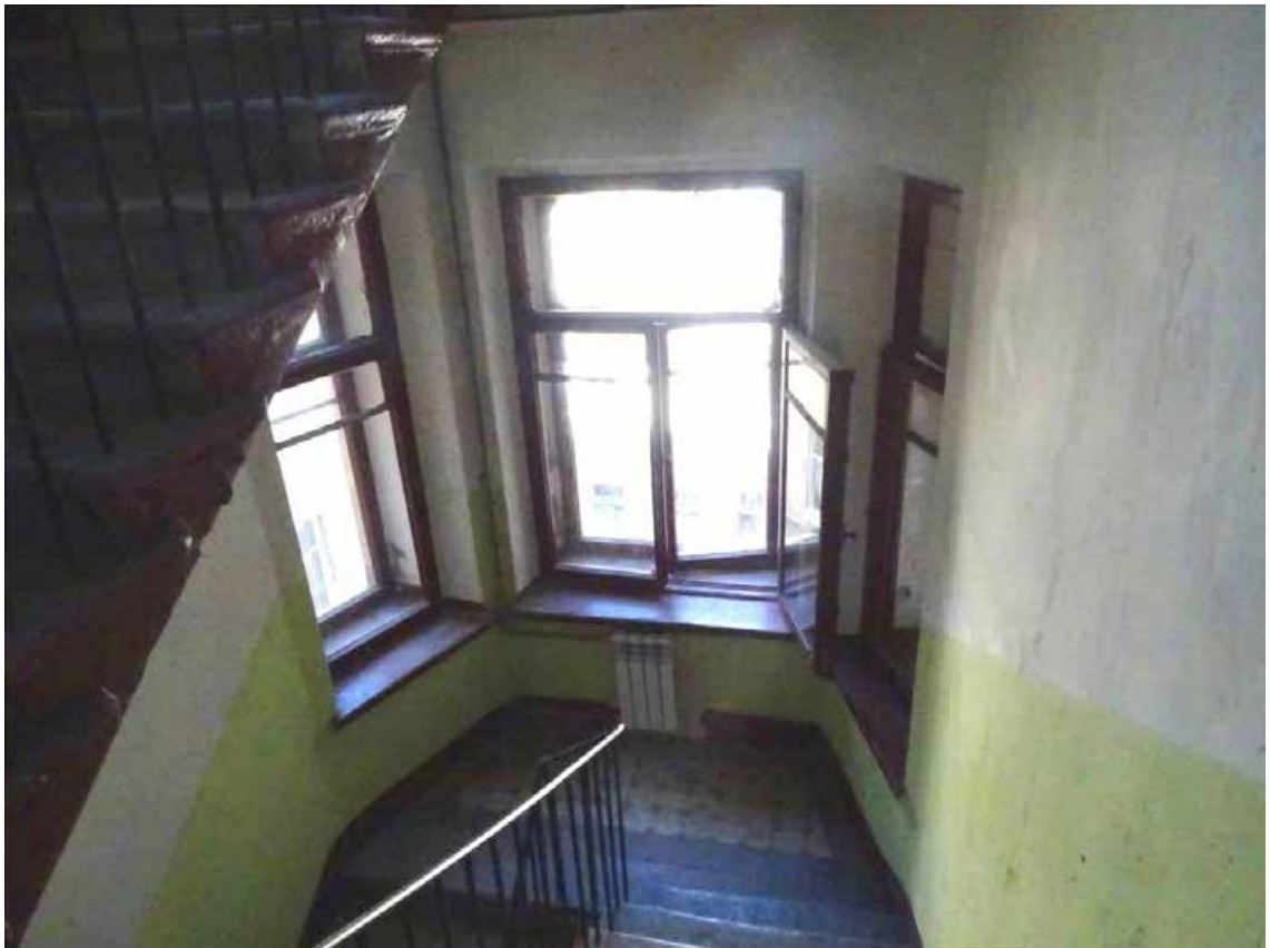
Фото 139. Лестница № 4. Площадка м/у 4-м и 5-м этажом. Съемка 19.04.2021 г. Кириков Б. М.
