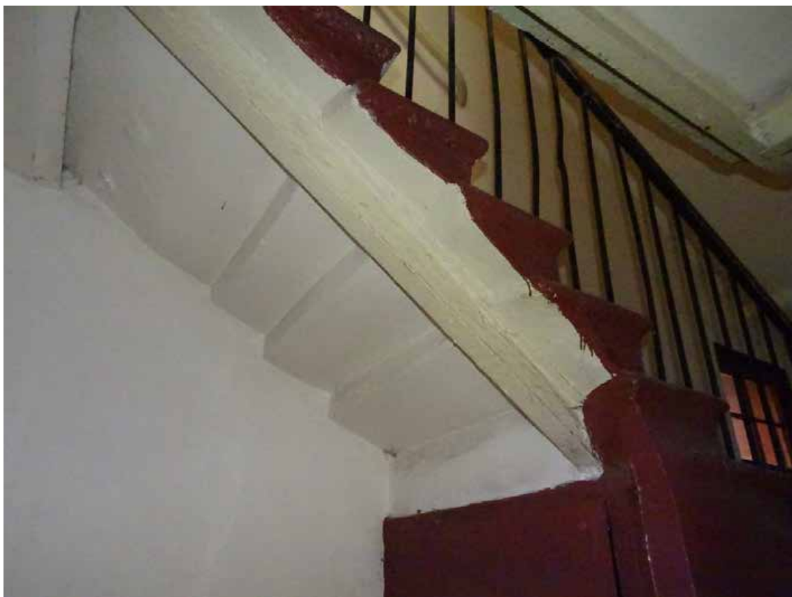
Фото 75. Лестница № 3. 1-й этаж. Пространство под лестничным маршем. Съемка 19.04.2021 г. Кириков Б. М.
