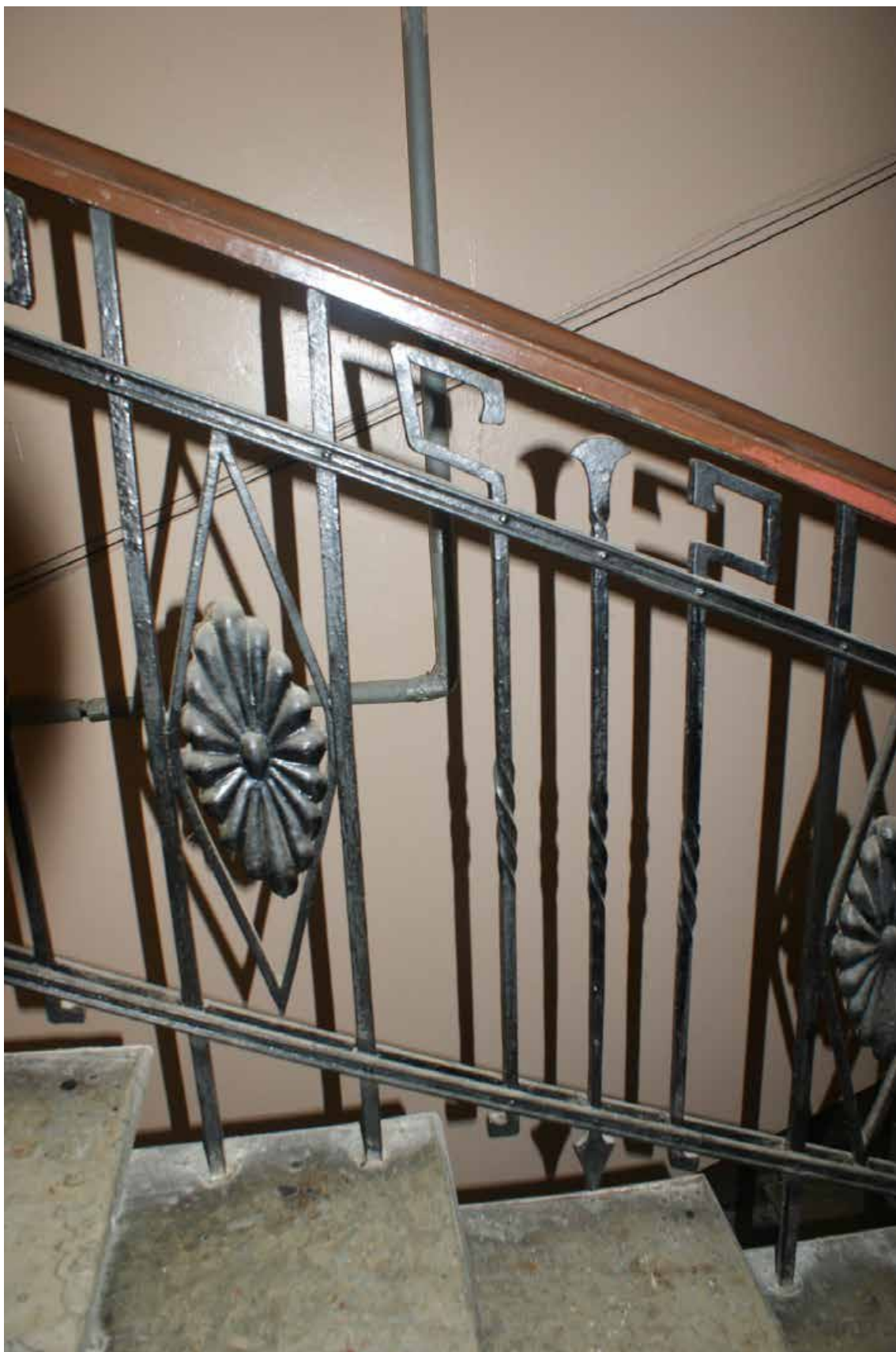
Фото 107. ЛК-3. 5-й этаж. Лестничное ограждение. Съемка 19.04.2021 г. Трушковский В.Э.
