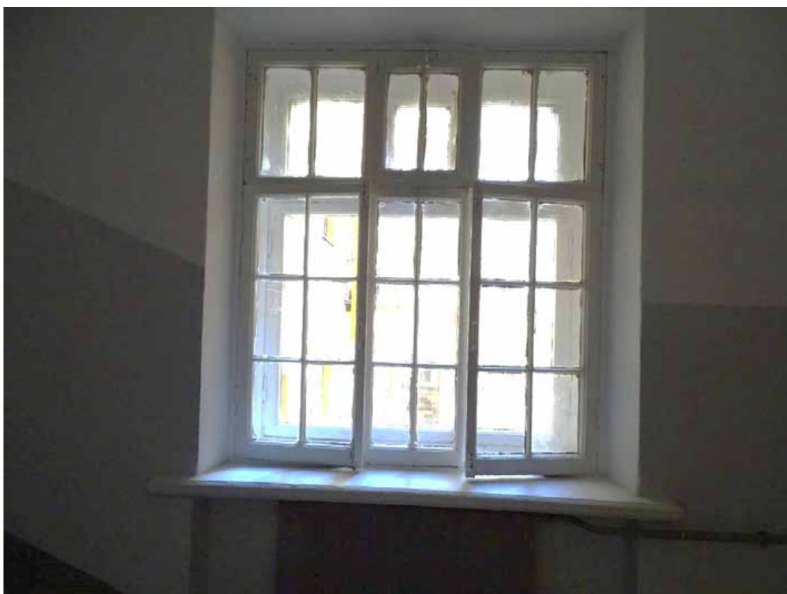
Фото 184. ЛК-6. Площадка между 2-м и 3-м этажом. Оформление окна. Съемка 19.04.2021 г. Трушковский В.Э.
