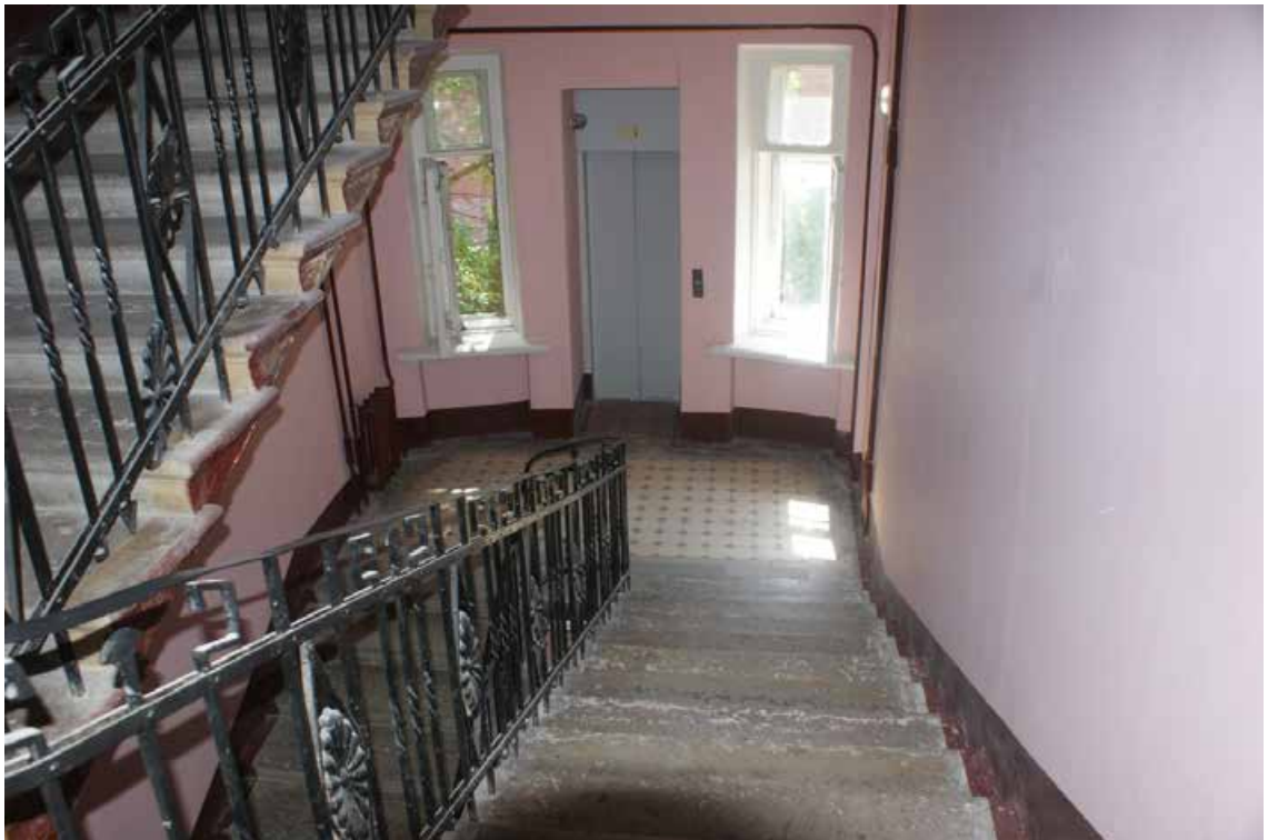
Фото 235. ЛК-8. Вид на площадку между 4-м и 5-м этажом. Съемка 19.04.2021 г. Трушковский В.Э.
