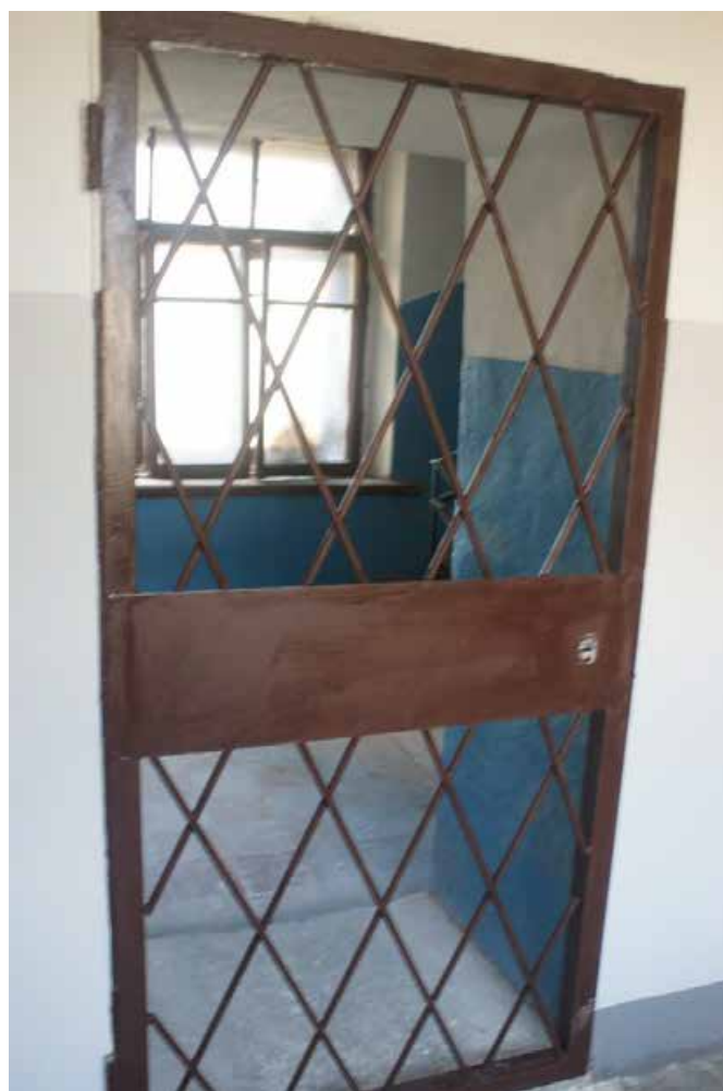
Фото 209. ЛК-6. Вид на площадку между 6-м и чердачным этажом. Дверь на соседнюю лестницу. Съемка 19.04.2021 г. Трушковский В.Э.
