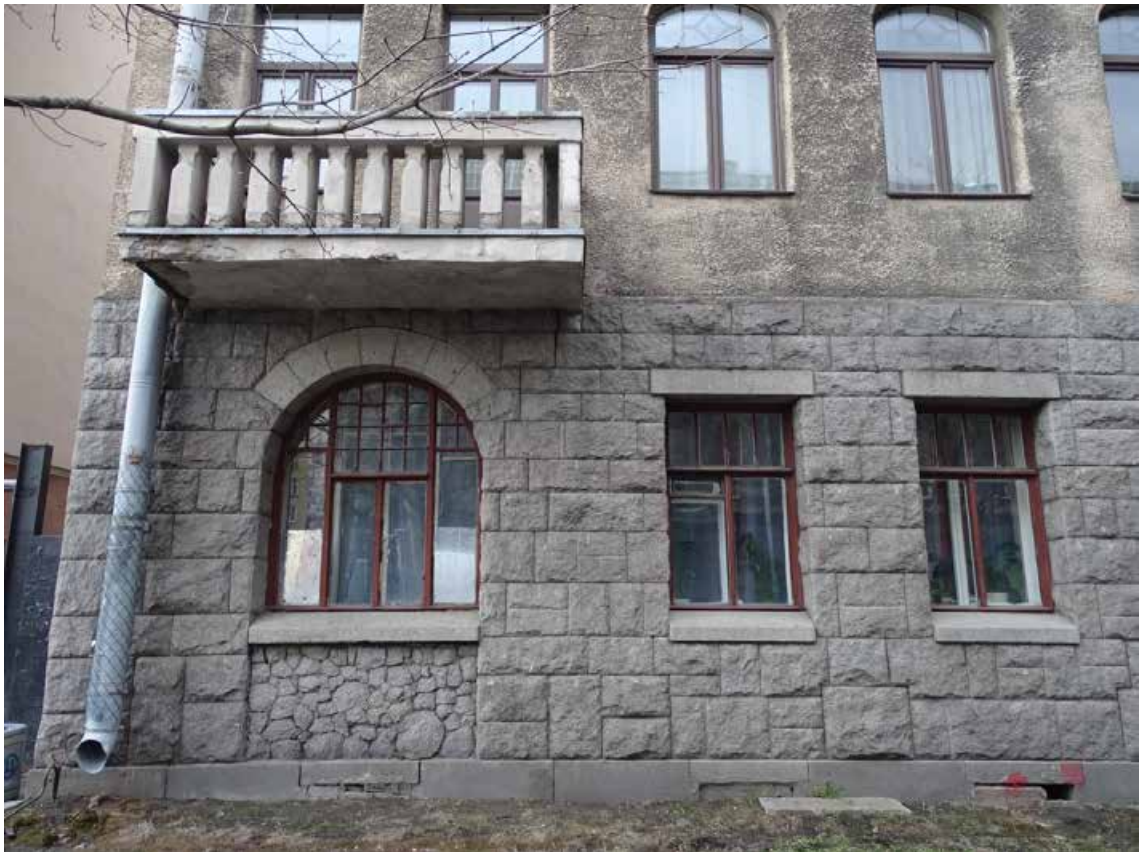
Фото 15. Здание по адресу: г. Санкт-Петербург, Большая Монетная ул., дом 29, литера А. Фрагмент фасада по Большой Монетной ул. Балкон 2-го этажа. Съемка 19.04.2021 г. Трушковский В.Э.
