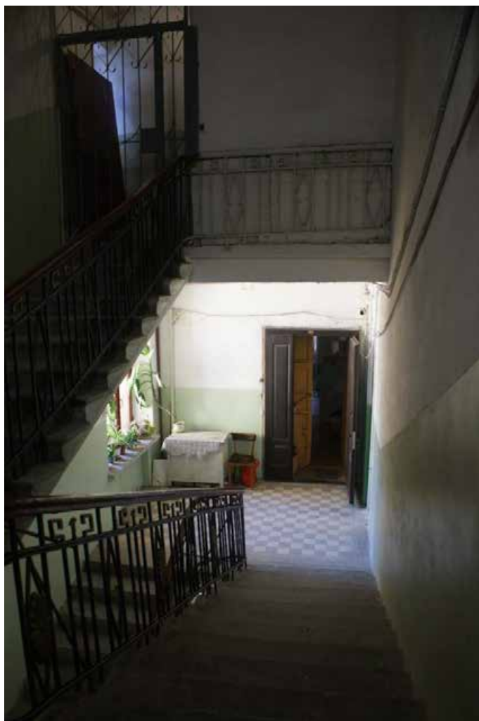
Фото 33. ЛК-1. Вид на площадку между 5-м и 6-м этажом. Съемка 19.04.2021 г. Трушковский В.Э.
