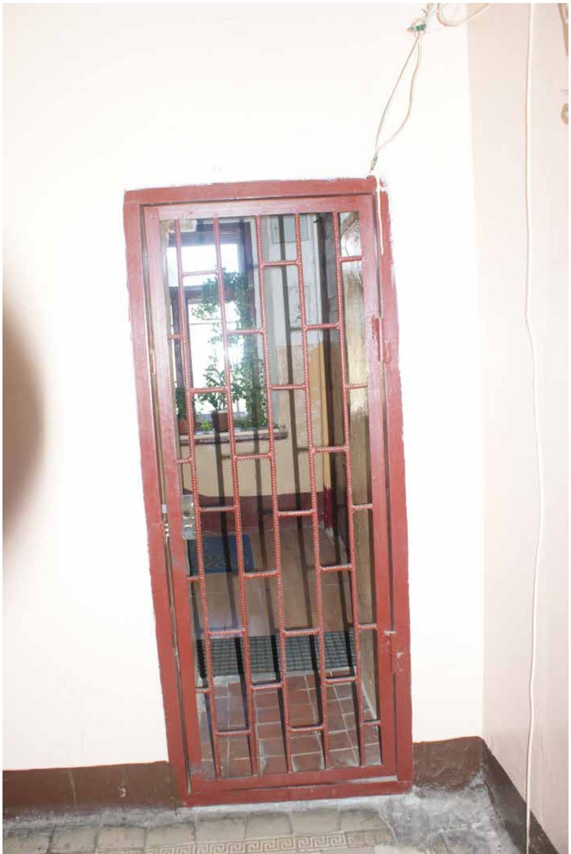
Фото 116. ЛК-3. 6 этаж. Проем, выходящий на соседнюю лестничную клетку. Съемка 19.04.2021 г. Трушковский В.Э.
