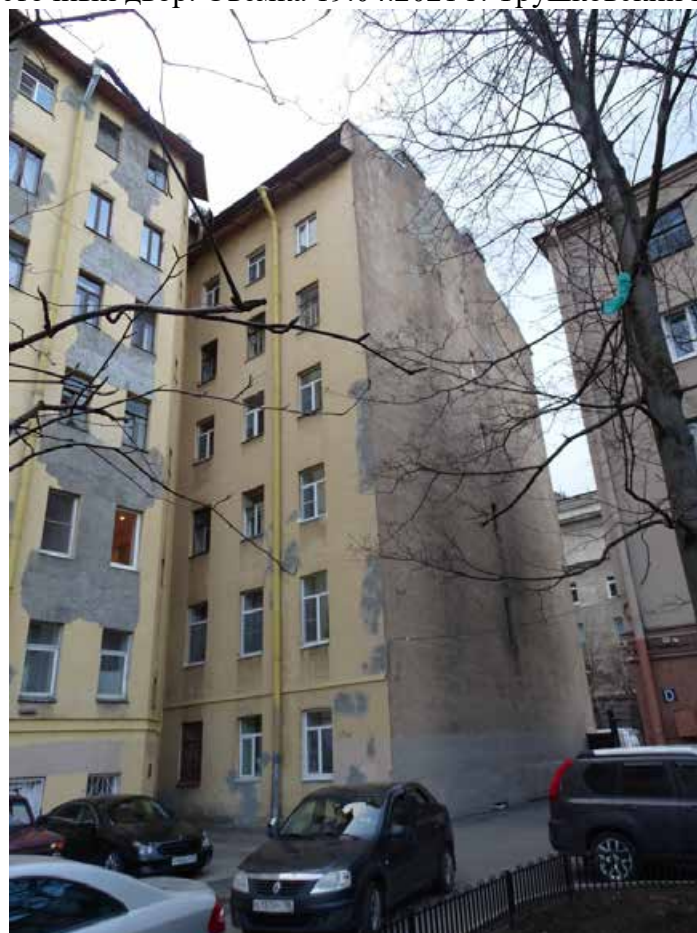
Фото 38. Здание по адресу: г. Санкт-Петербург, Большая Монетная ул., дом 29, литера А. Восточный двор. Съемка 19.04.2021 г. Трушковский В.Э.
