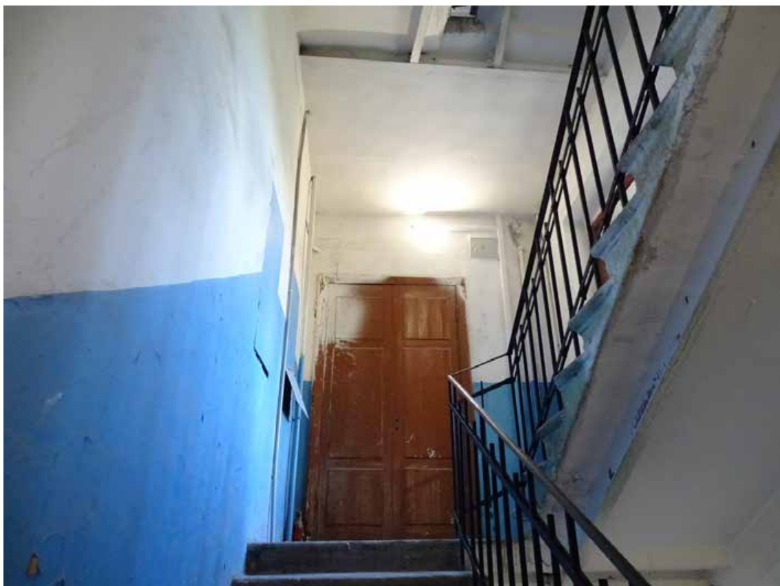
Фото 137. ЛК-5. Вид на площадку между 3-м и 4-м этажом. Съемка 19.04.2021 г. Трушковский В.Э.
