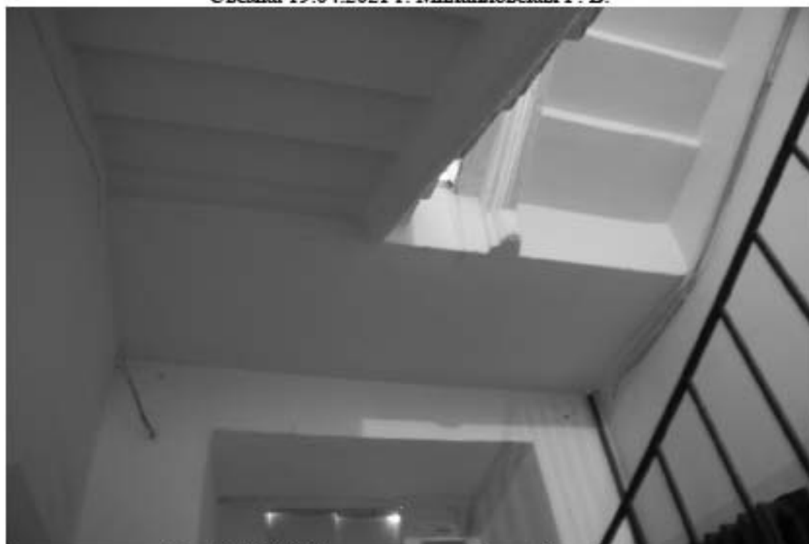
Фото 88. 6ЛК. Площадка между 1-м и 2-м этажом. Съемка 19.04.2021 г. Михайловская Г. В.
