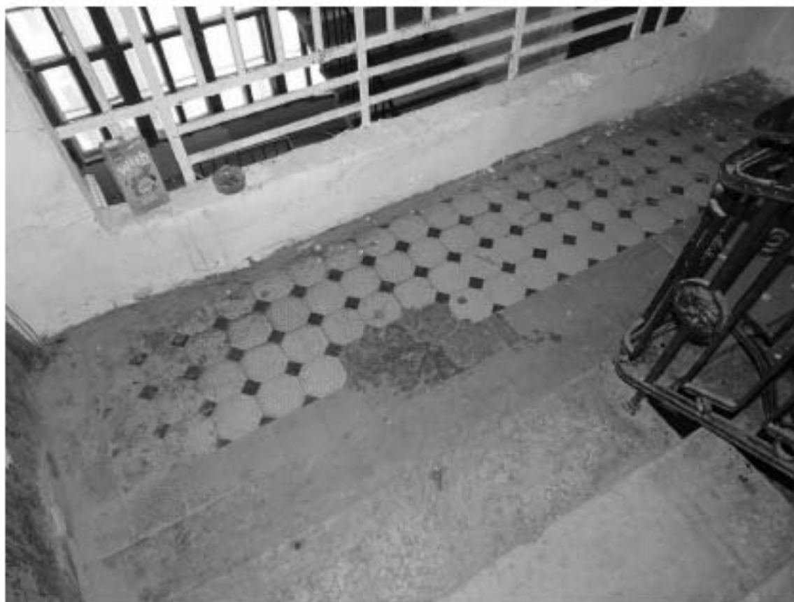
Фото 41. Лестница № 1: Площадка м/у 6-м и 7-м этажом. Съемка 19.04.2021 г. Михайловская Г. В.
