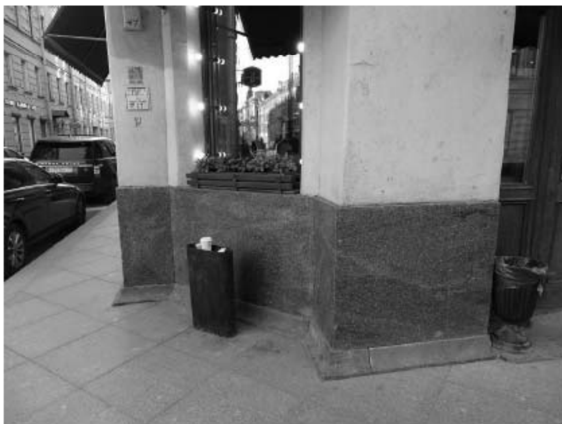
Фото 19. Здание по адресу: г. Санкт-Петербург, Большой проспект П.С., дом 74, литера А. Угловая часть здания (угол Большого пр. и ул. Подрезова). Съемка 19.04.2021 г. Михайловская Г. В.
