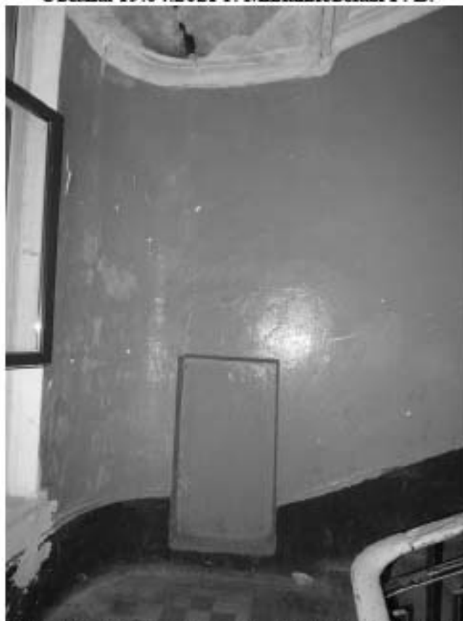
Фото 77. Лестница № 5: Площадка между 2-м и 3-м этажом. Ниша в стене. Съемка 19.04.2021 г. Михайловская Г. В.
