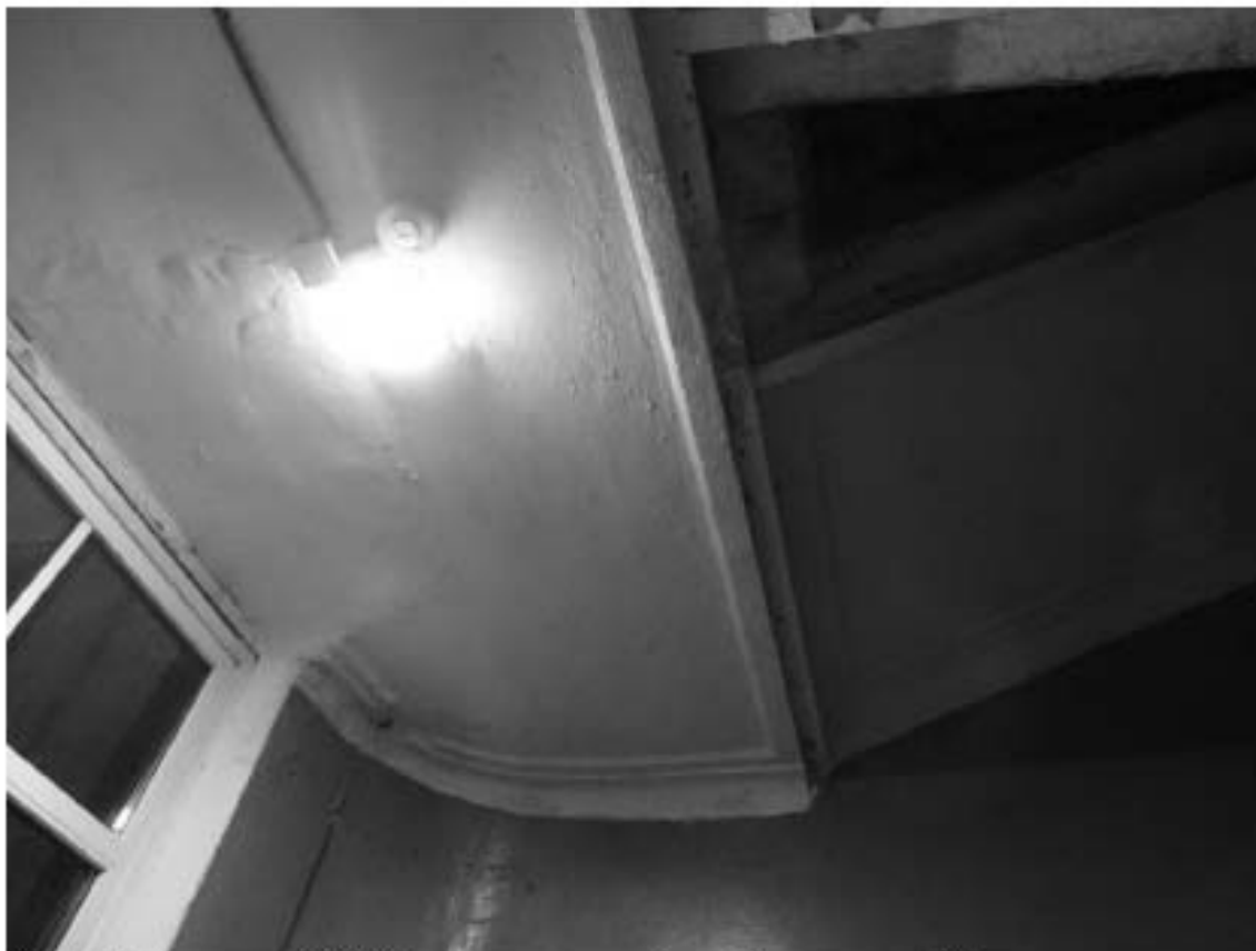
Фото 69. Лестница № 5: Площадка между 1-м и 2-м этажом. Оформление потолка. Съемка 19.04.2021 г. Михайловская Г. В.
