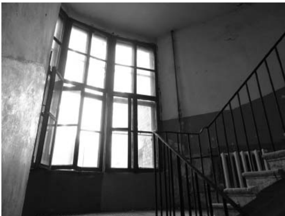
Фото 105. Лестница № 11: Площадка между 4-м и 5-м этажом. Съемка 19.04.2021 г. Михайловская Г. В.
