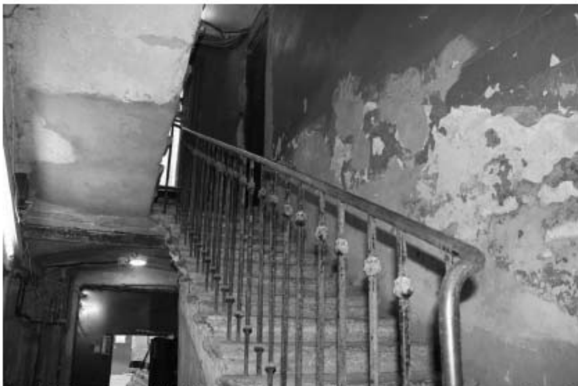
Фото 149. Лестница № 13: 1-й этаж. Лестничный марш на площадку между 1-м и 2-м этажом. Съемка 19.04.2021 г. Михайловская Г. В.
