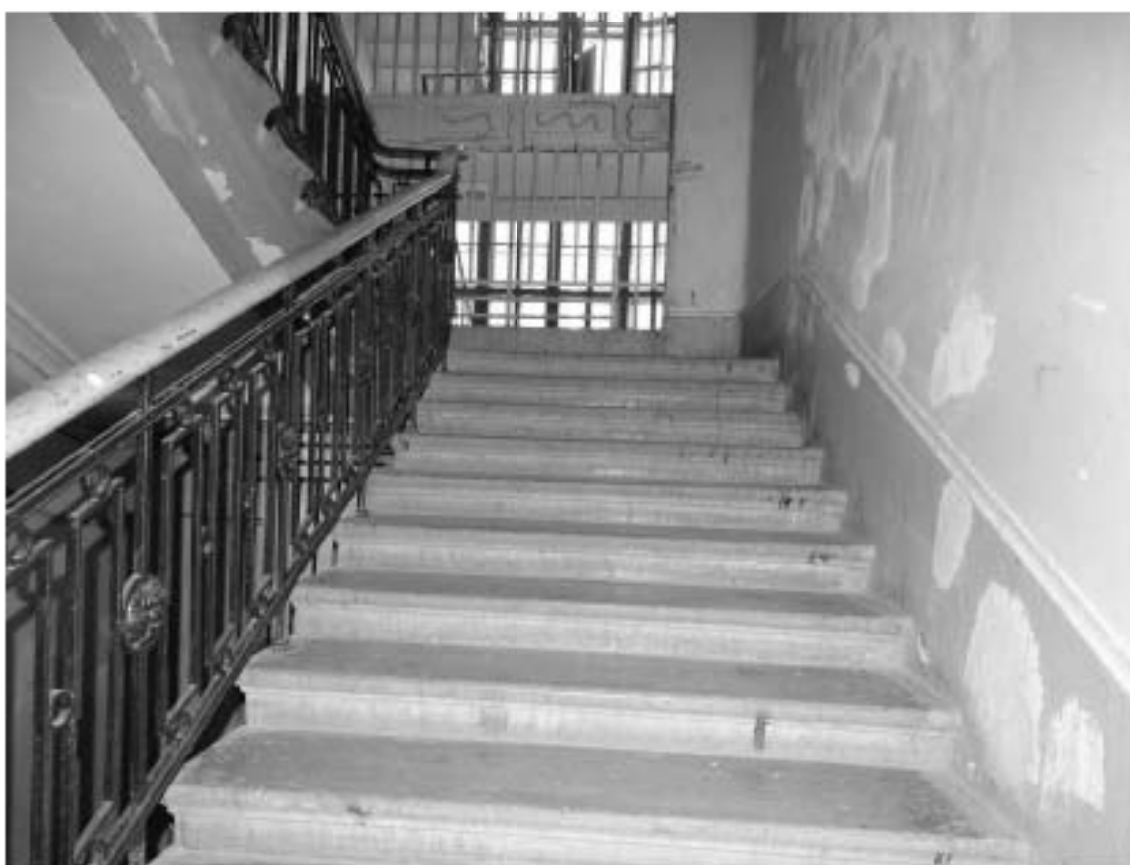
Фото 35. Лестница № 1: Лестничный марш на площадку между 5-м и 6-м этажом. Съемка 19.04.2021 г. Михайловская Г. В.
