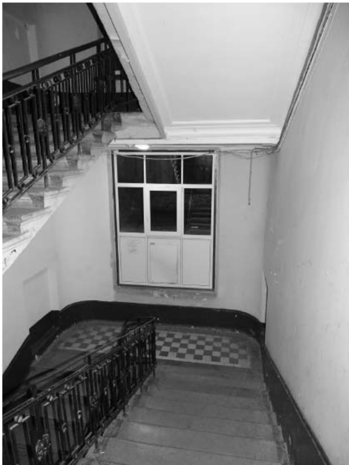
Фото 9. Лестница № 3: Площадка между 1-м и 2-м этажом. Съемка 19.04.2021 г. Михайловская Г. В.
