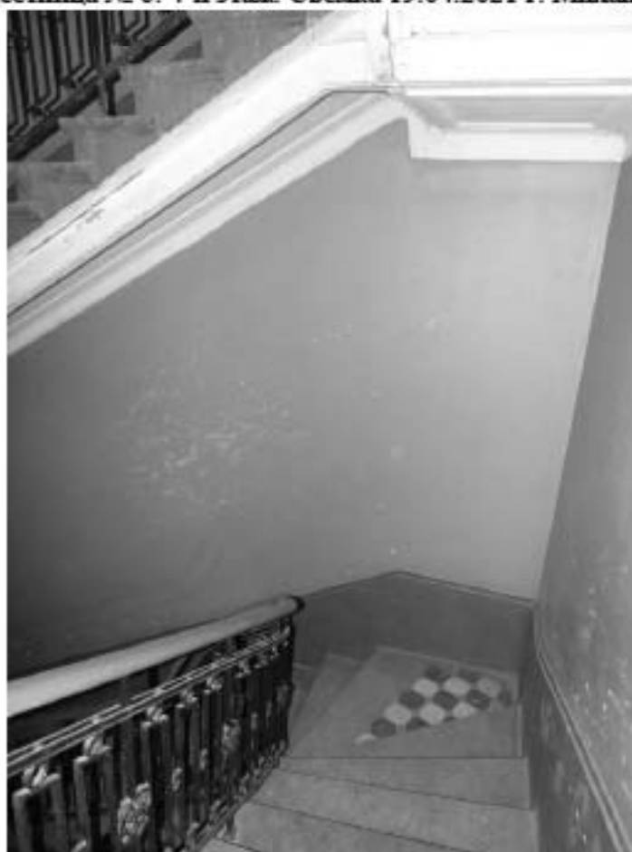
Фото 119. Лестница № 6: Площадка между 4-м и 5-м этажом. Съемка 19.04.2021 г. Михайловская Г. В.
