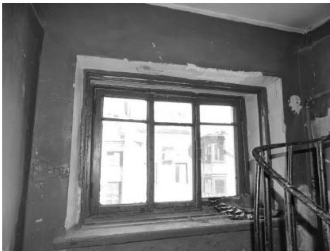
Фото 144. Лестница № 12: Площадка между 7-м и чердачным этажом. Оформление окна. Съемка 19.04.2021 г. Михайловская Г. В.
