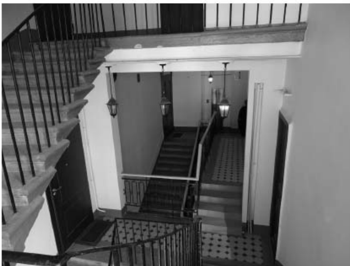
Фото 114. Лестница № 11: Вид на площадку 7-го этажа. Переход между лестницами. Съемка 19.04.2021 г. Михайловская Г. В.
