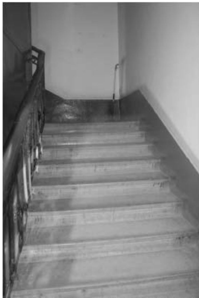
Фото 36. Лестница № 4: Лестничная площадка между 2-м и 3-м этажом. Съемка 19.04.2021 г. Михайловская Г. В.
