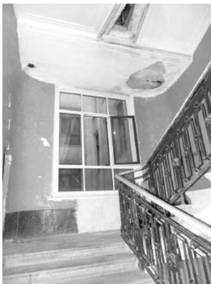
Фото 76. Лестница № 5: Площадка между 2-м и 3-м этажом.
