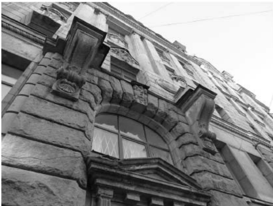
Фото 6. Здание по адресу: г. Санкт-Петербург, Большой проспект П.С., дом 74, литера А. Лицевой фасад по Большому пр. Фрагмент. Съемка 19.04.2021 г. Михайловская Г. В.
