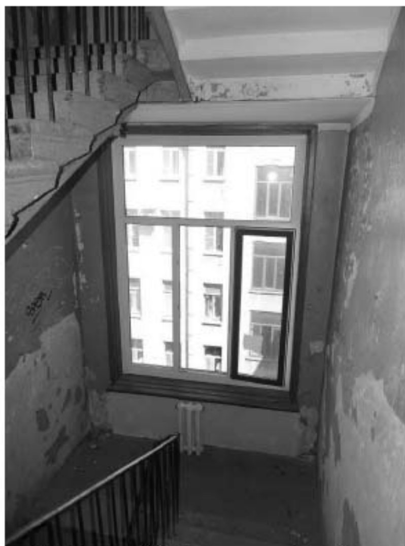
Фото 192. Лестница № 9: Площадка между 5-м и 6-м этажом. Съёмка 19.04.2021 г. Михайловская Г. В.
