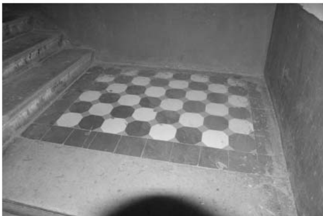
Фото 33. Лестница № 4: Площадка между 1-м и 2-м этажом. Покрытие пола. Съемка 19.04.2021 г. Михайловская Г. В.
