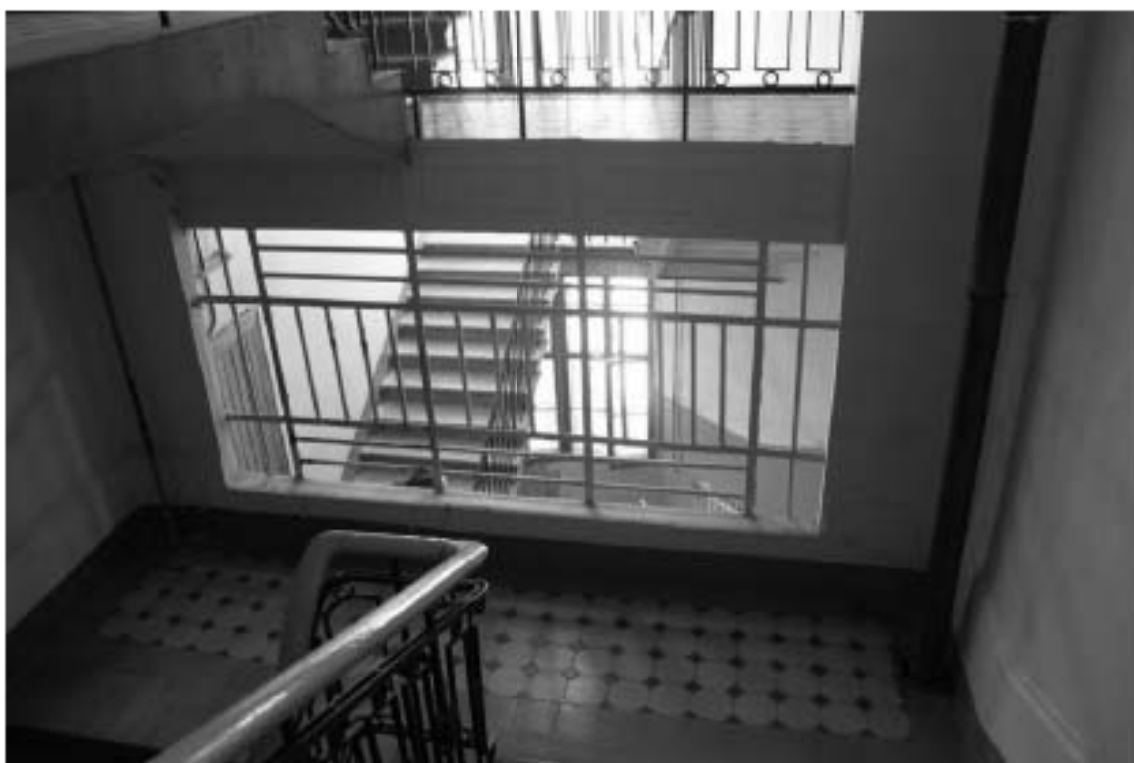
Фото 66. Лестница № 2: Площадка м/у 6-м и 7-м этажом. Съемка 19.04.2021 г. Михайловская Г. В.
