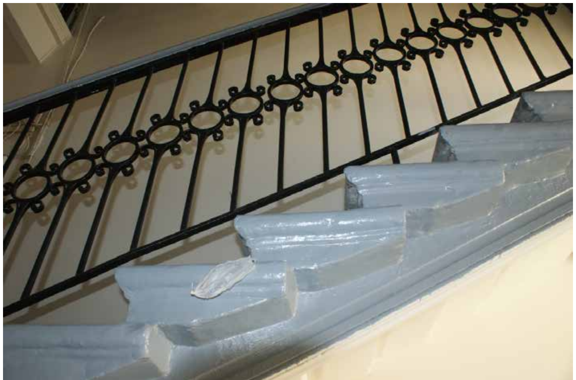
Фото 98. Лестница № 4. 3-й этаж. Лестничное ограждение. Съемка 19.04.2021 г. Трушковский В.Э.
