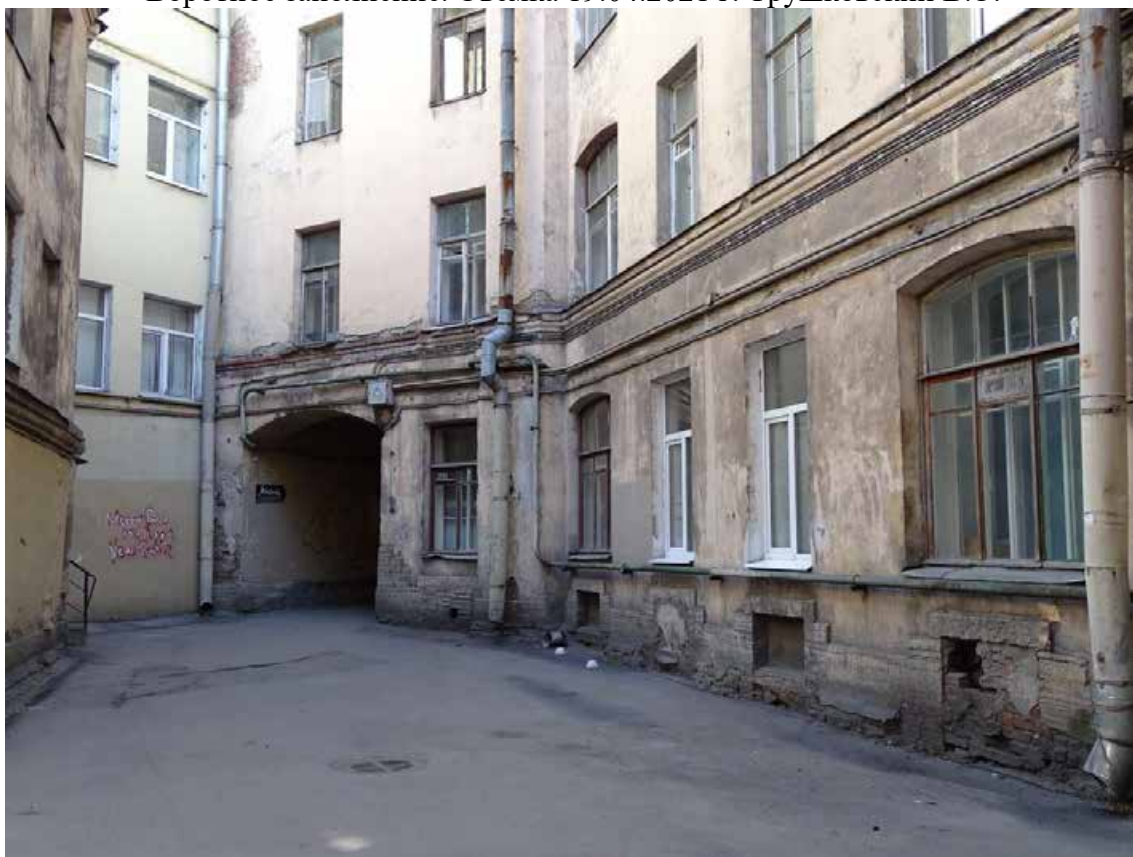
Фото 23. Здание по адресу: г. Санкт-Петербург, Тучков пер., 11/5, литера А. Фрагмент северо-западного дворового фасада. Съемка 19.04.2021 г. Трушковский В.Э.
