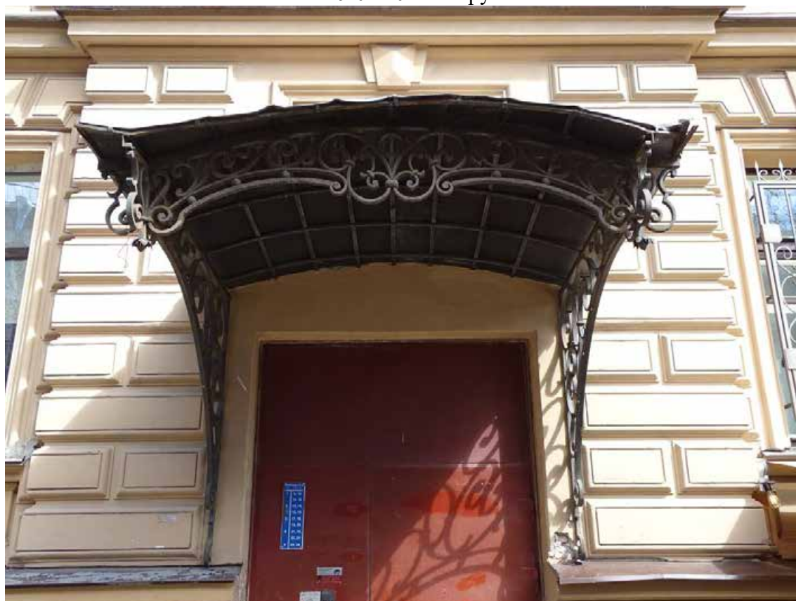
Фото 18. Здание по адресу: г. Санкт-Петербург, Тучков пер., 11/5, литера А. Фрагмент лицевого фасада со стороны Тучкова пер. Вход в парадную. Оформление навеса. Съемка 19.04.2021 г. Трушковский В.Э.
