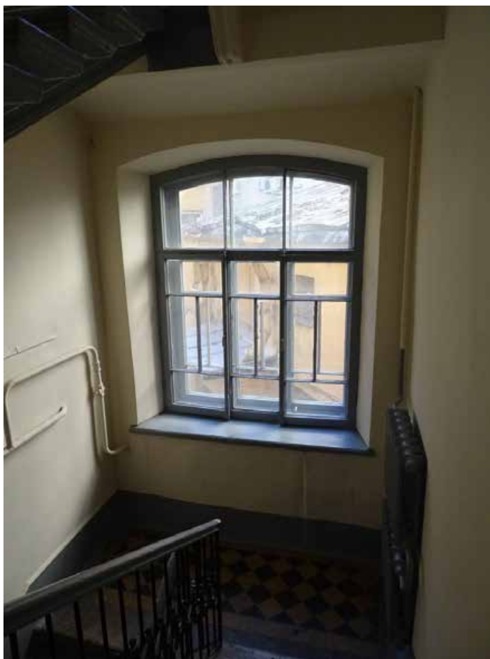
Фото 92. Лестница № 4. Площадка м/у 1-м и 2-м этажом. Съемка 19.04.2021 г. Трушковский В.Э.
