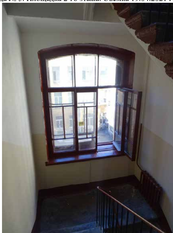
Фото 117. Лестница № 5. Площадка м/у 2-м и 3-м этажом. Съемка 19.04.2021 г. Трушковский В.Э.
