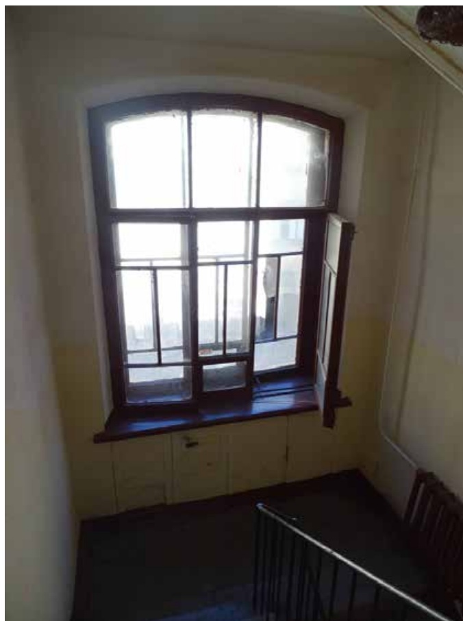
Фото 135. Лестница № 6. Площадка м/у 2-м и 3-м этажом. Съемка 19.04.2021 г. Трушковский В.Э.
