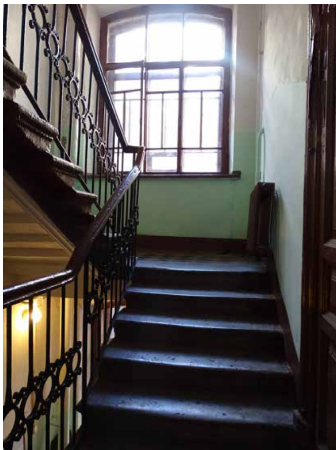
Фото 152. Лестница № 7. Площадка м/у 1-м и 2-м этажом. Съемка 19.04.2021 г. Трушковский В.Э.
