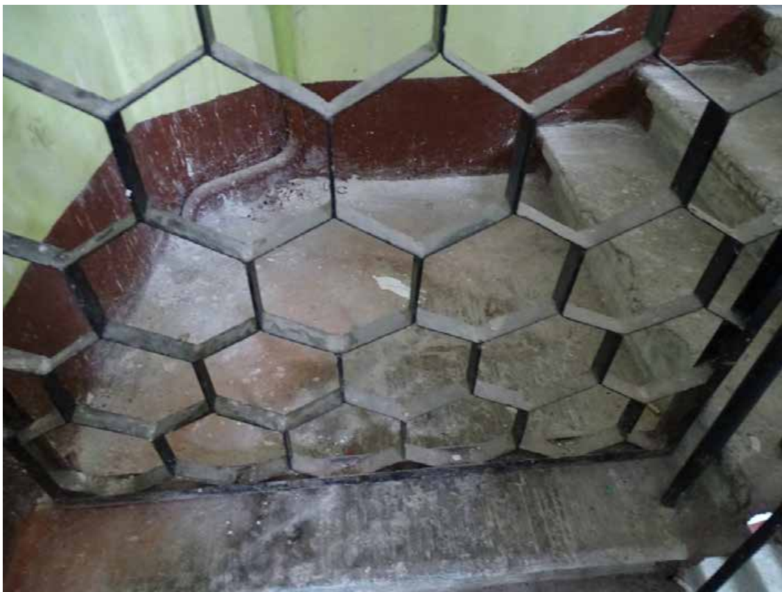
Фото 208. Лестница № 8. Площадка м/у 5-м и 6-м этажом. Съемка 19.04.2021 г. Трушковский В.Э.
