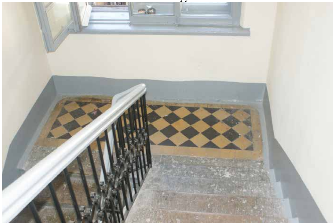
Фото 100. Лестница № 4. Площадка м/у 3-м и 4-м этажом. Покрытие пола. Съемка 19.04.2021 г. Трушковский В.Э.
