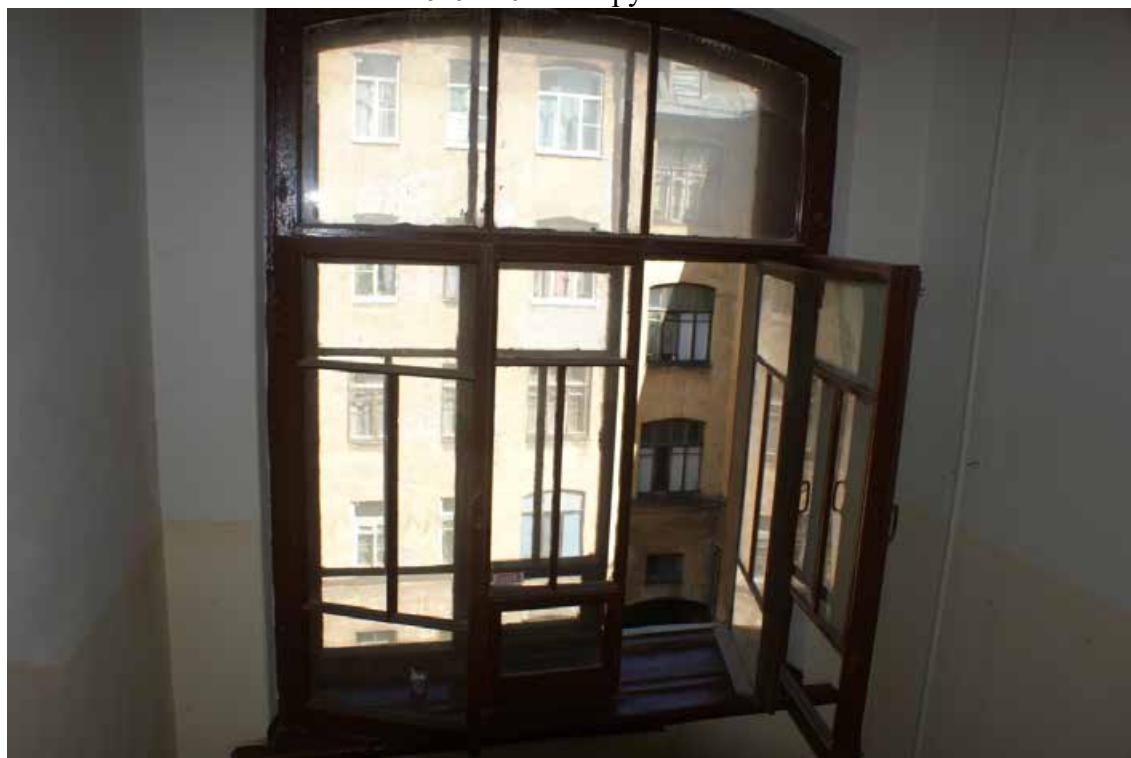
Фото 138. Лестница № 6. Площадка м/у 3-м и 4-м этажом. Съемка 19.04.2021 г. Трушковский В.Э.
