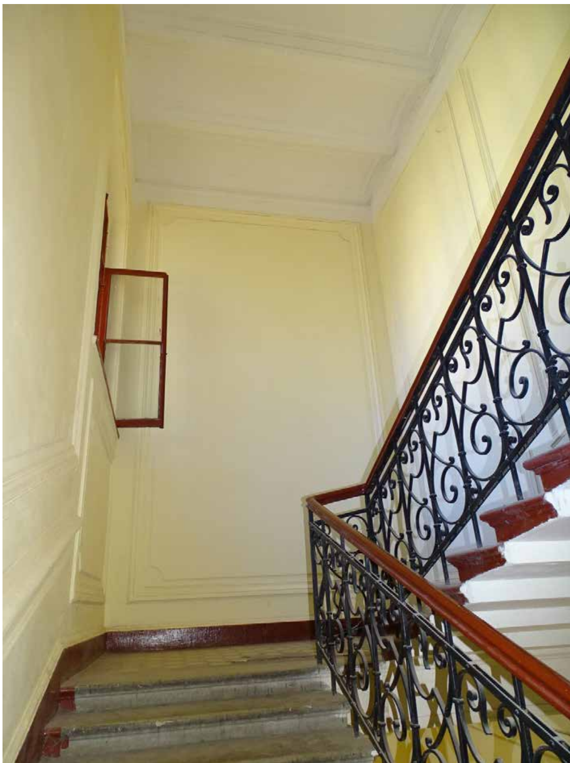
Фото 28. Лестница № 1. Вид на площадку м/у 3-м и 4-м этажом. Съемка 19.04.2021 г. Трушковский В.Э.
