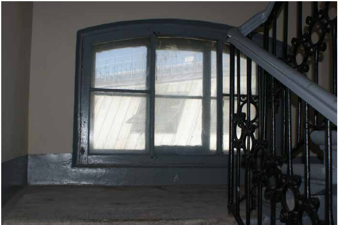
Фото 103. Лестница № 4. Площадка м/у 4-м и 5-м этажом. Съемка 19.04.2021 г. Трушковский В.Э.
