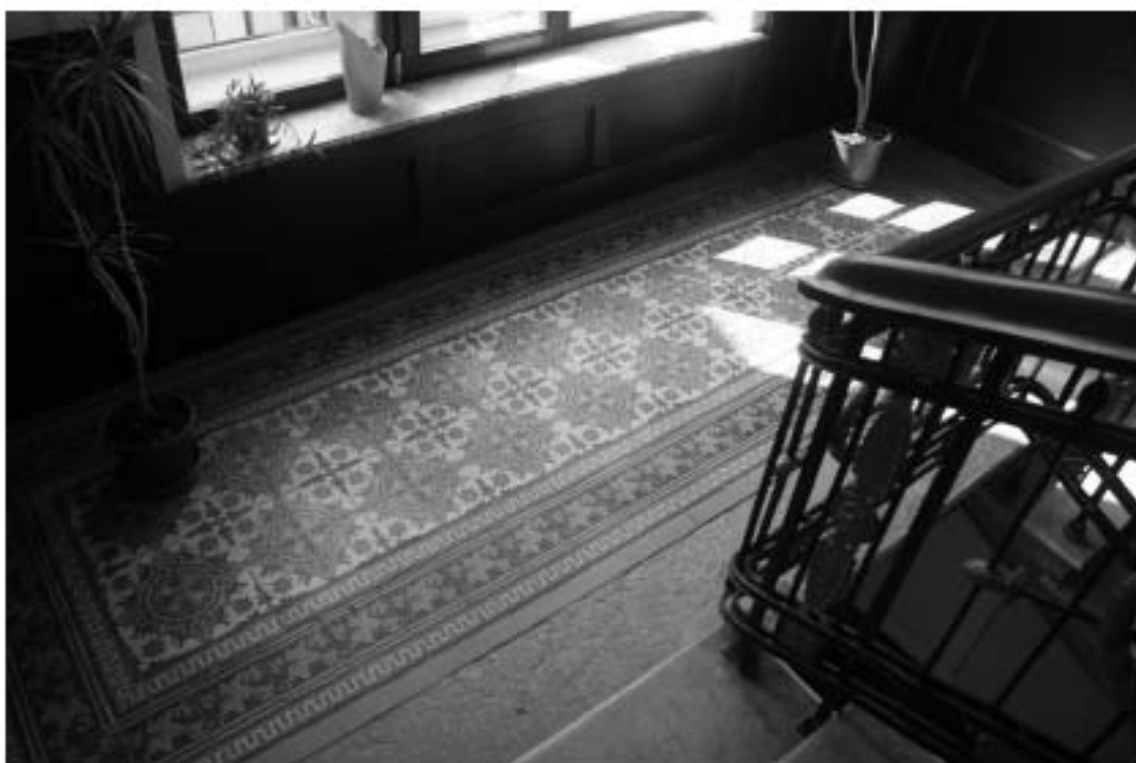
Фото 71. Лестница № 1. Площадка между 5-м и 6-м этажом. Покрытие пола. Съемка 26.04.2021 г. Михайловская Г. В.
