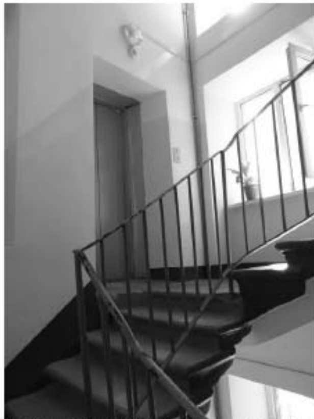
Фото 108. Лестница № 2. Площадка между 6-м и 7-м этажом. Съемка 26.04.2021 г. Михайловская Г. В.
