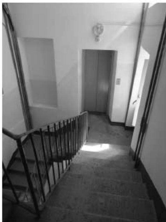
Фото 106. Лестница № 2. Площадка между 6-м и 7-м этажом. Съемка 26.04.2021 г. Михайловская Г. В.
