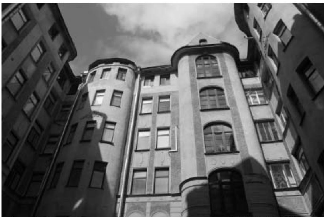
Фото 27. Фрагмент северного фасада внутреннего двора. 3-й, 4-й, 5-й, 6-й этажи. Съемка 26.04.2021 г. Михайловская Г. В.
