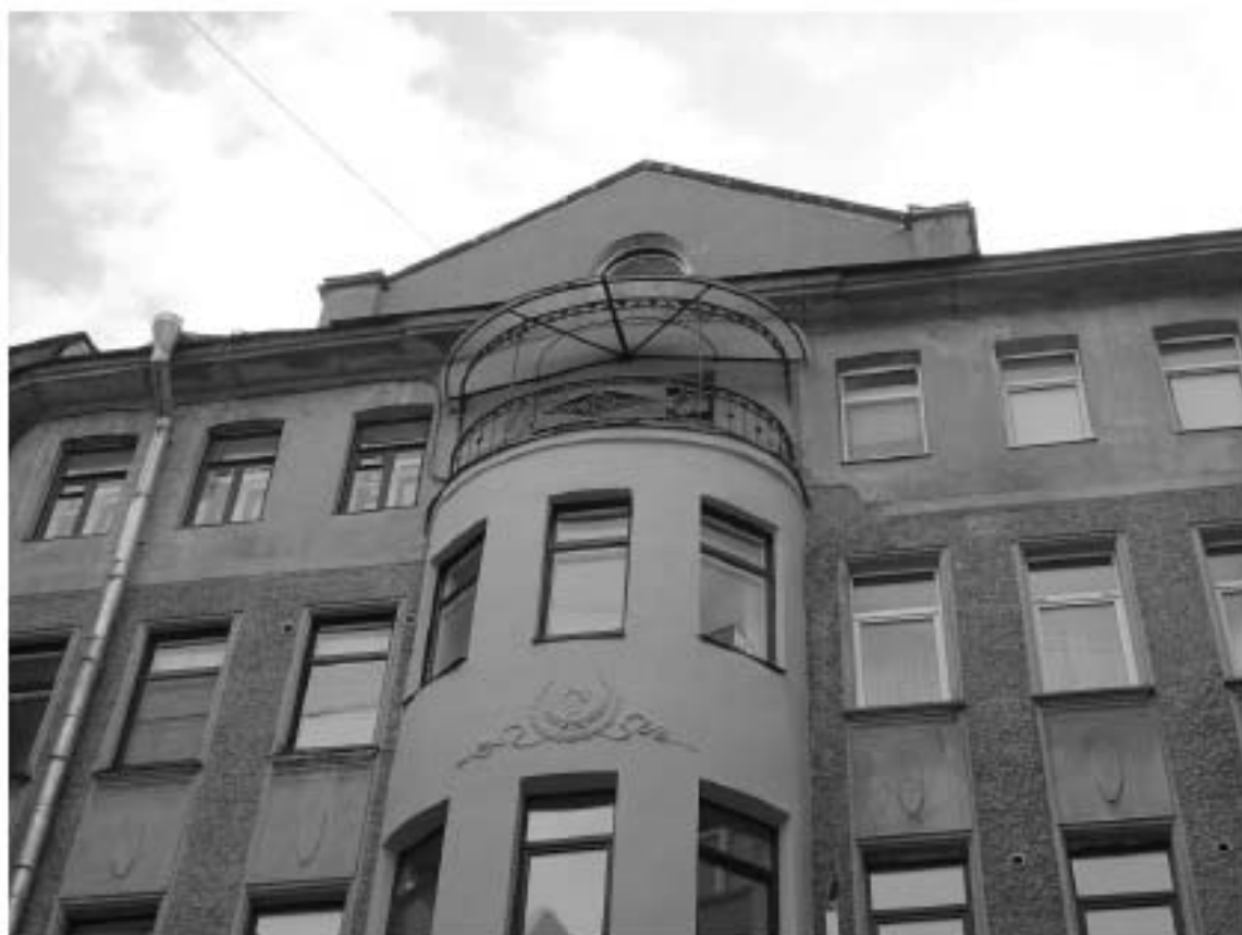
Фото 40. Фрагмент южного фасада внутреннего двора. 5-й и 6-й этажи. Съемка 26.04.2021 г. Михайловская Г. В.
