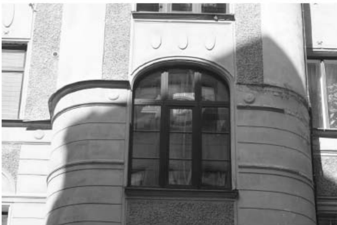
Фото 30. Фрагмент северного фасада внутреннего двора. Ризалит. 3-й этаж. Съемка 26.04.2021 г. Михайловская Г. В.
