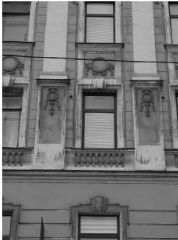
Фото 11. Фрагмент лицевого фасада. Оформление оконного проема. 3-й этаж. Съемка 26.04.2021 г. Михайловская Г. В.
