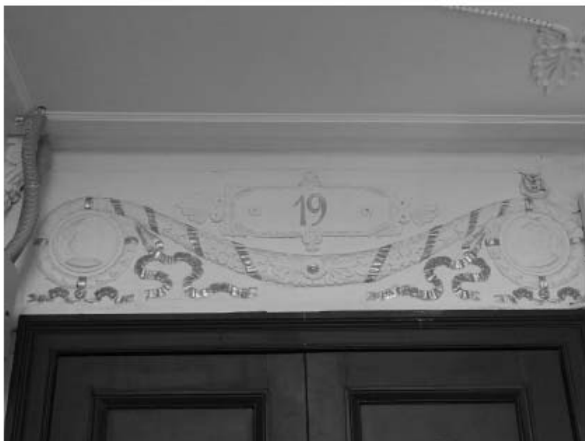
Фото 152. Лестница № 3. Площадка 3-го этажа. Лепные композиции над входной дверью. Съемка 26.04.2021 г. Михайловская Г. В.
