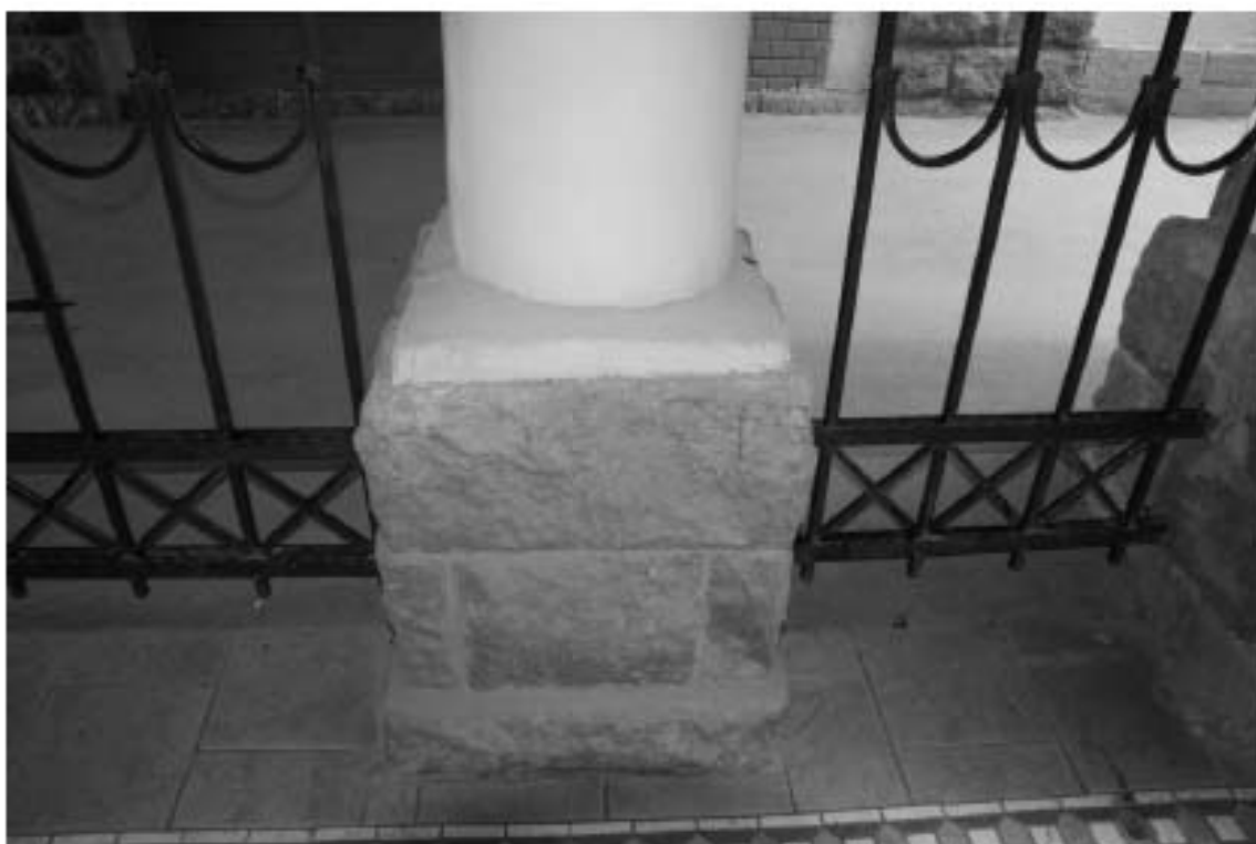
Фото 23. Пьедестал колонны проезда. Съемка 26.04.2021 г. Михайловская Г. В.
