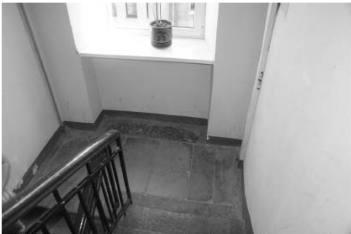
Фото 205. Лестница № 4. Площадка между 5-м и 6-м этажом. Покрытие пола. Съемка 26.04.2021 г. Михайловская Г. В.
