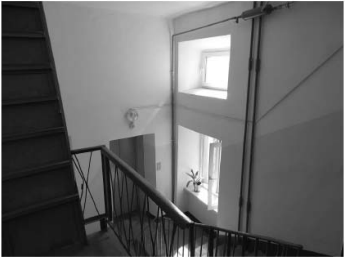
Фото 107. Лестница № 2. Площадка между 6-м и 7-м этажом. Съемка 26.04.2021 г. Михайловская Г. В.
