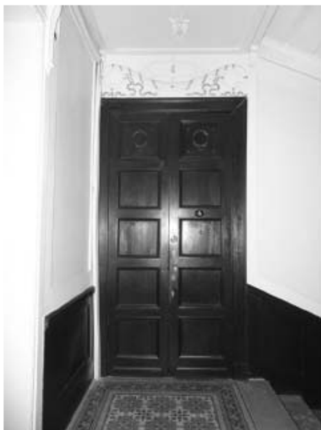
Фото 45. Лестница № 1. Площадка 3-го этажа. Входная дверь. Съемка 26.04.2021 г. Михайловская Г. В.
