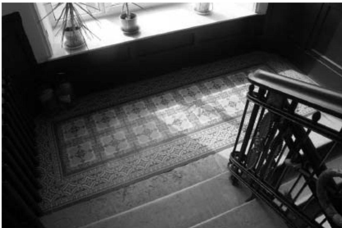
Фото 169. Лестница № 3. Площадка между 4-м и 5-м этажом. Покрытие пола. Съемка 26.04.2021 г. Михайловская Г. В.
