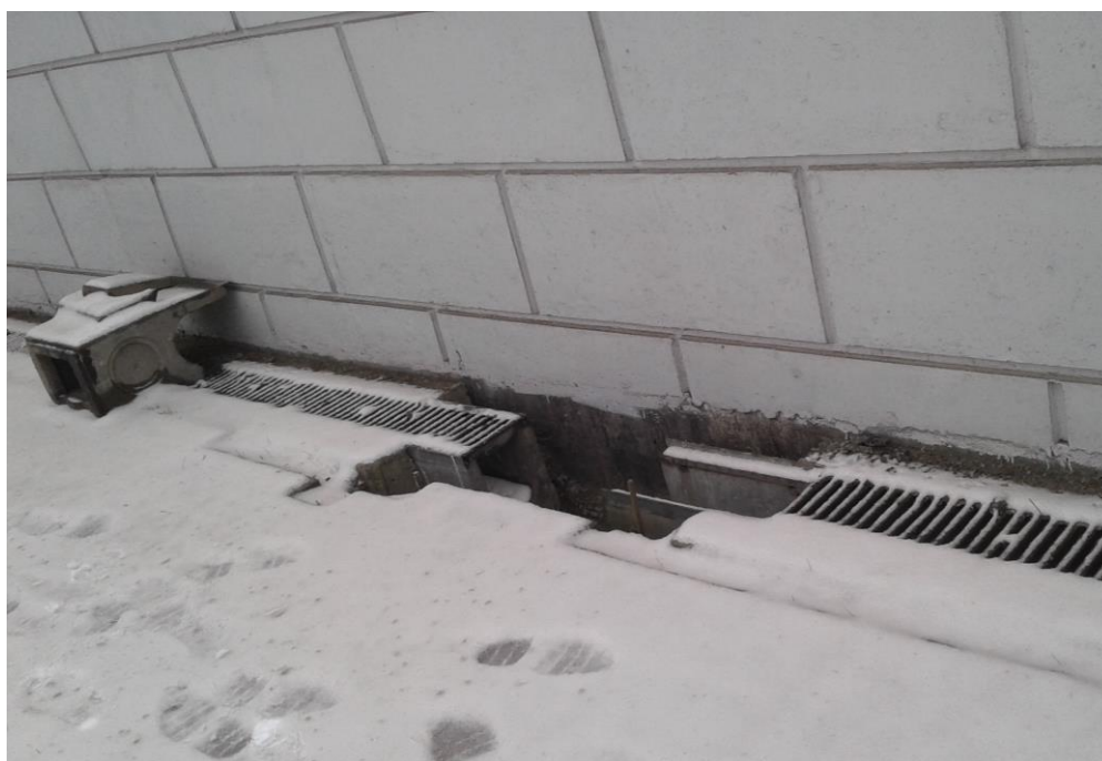
20. Объект культурного наследия регионального значения «Набережная Обводного канала» по адресу: от Шлиссельбургского моста до Московской ж. д. (Участок от протоки Французского ковша до Атаманского моста, левый берег). Нижний уровень. Металлическая решетка дренажного лотка.
