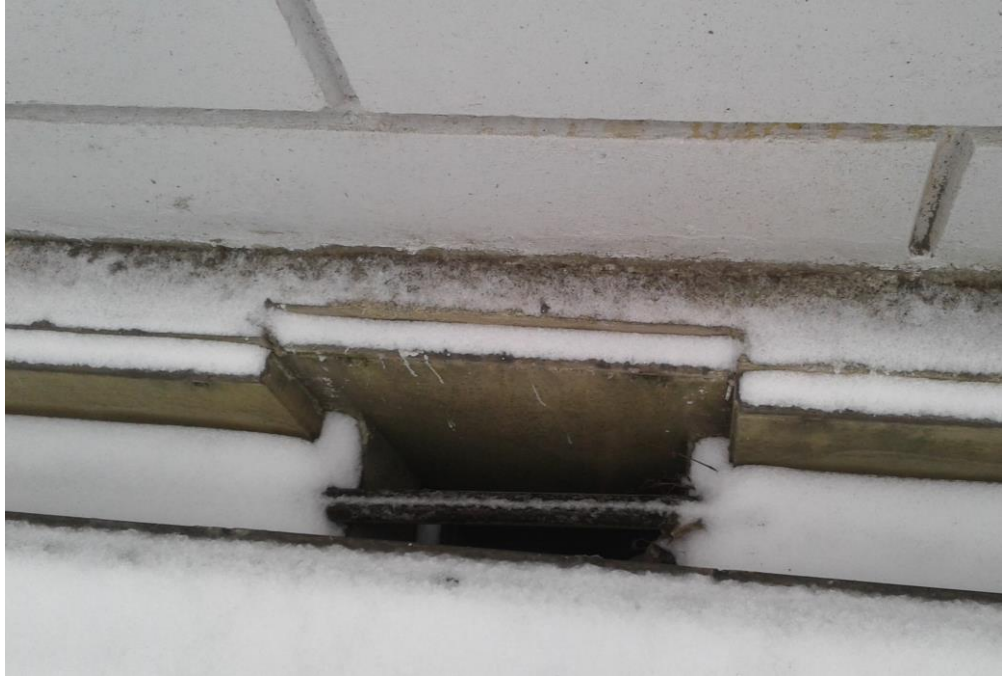
21. Объект культурного наследия регионального значения «Набережная Обводного канала» по адресу: от Шлиссельбургского моста до Московской ж. д. Участок от протоки Французского ковша до Атаманского моста, левый берег. Нижний уровень. Дренажный лоток.
